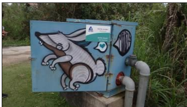
Figura 354- Vista externa do Booster Ratonos
