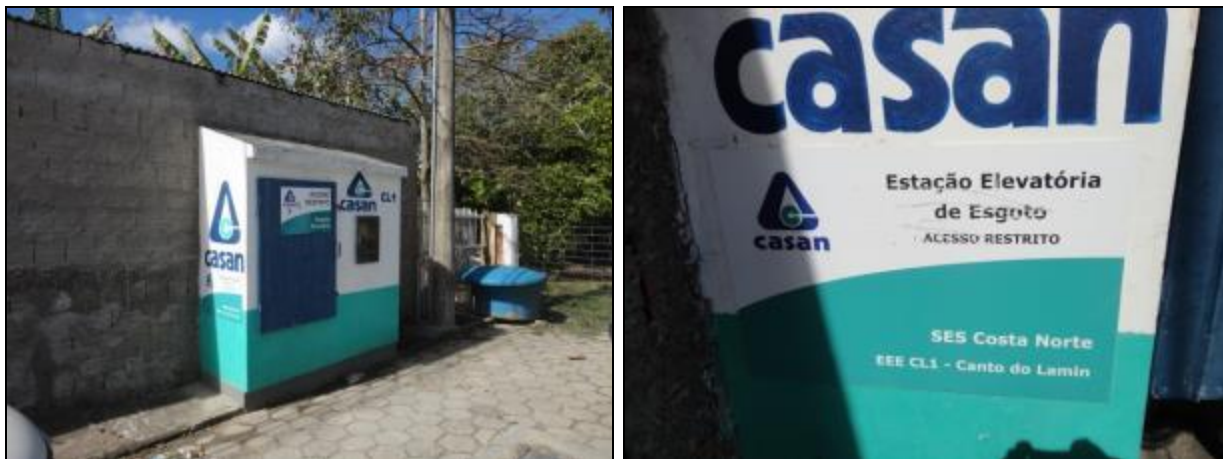
Figura 637- Vista externa da casa de comando com placa de identificação e restrição de acesso
