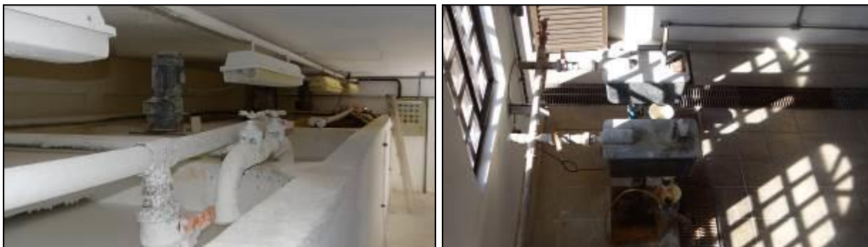
Figura 204 – Casa de química da ETA (Acompanhamento)
