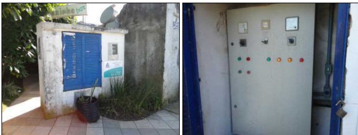
Figura 763- Vista da EEE BAd Henrique Valgas com placa de identificação e restrição de acesso (à esquerda) e quadro de comando (à direita)
