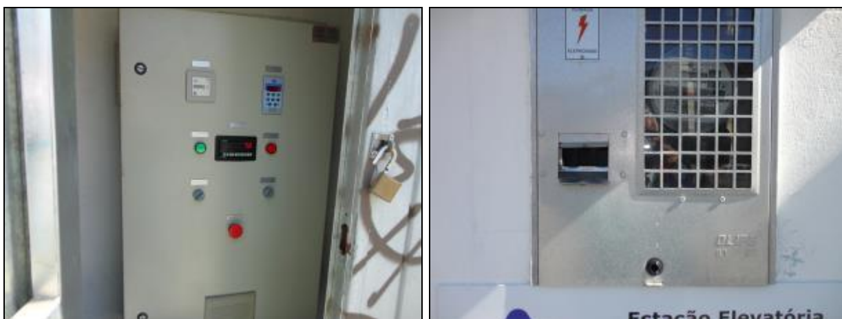
Figura 725- Quadro de comando (à esquerda) e quadro de energia (à direita)
