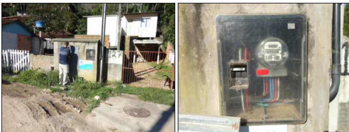
Figura 758- Vista da EEE Caieira do Saco dos Limões com placa de identificação e restrição de acesso (à esquerda) e quadro de energia (à direita)
