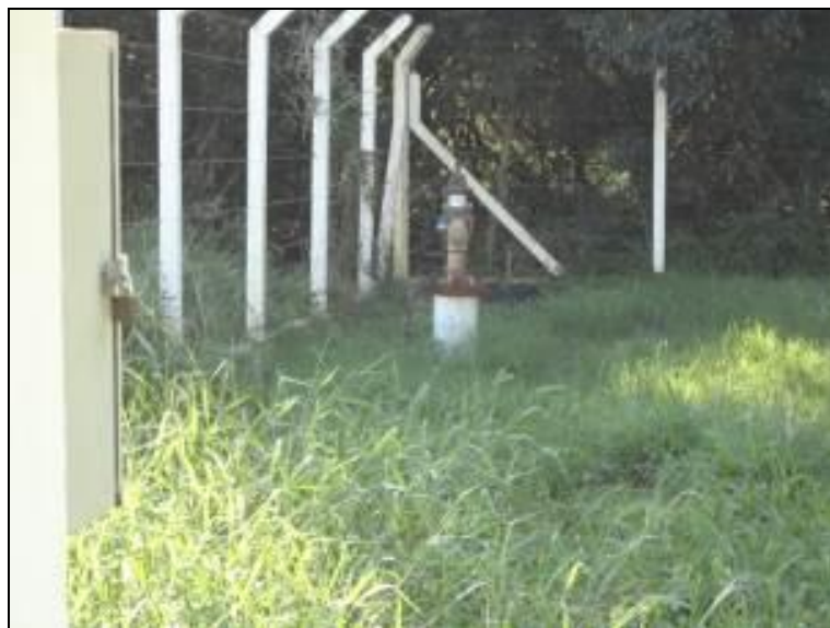
Figura 335- Poço III da ETA Ingleses
