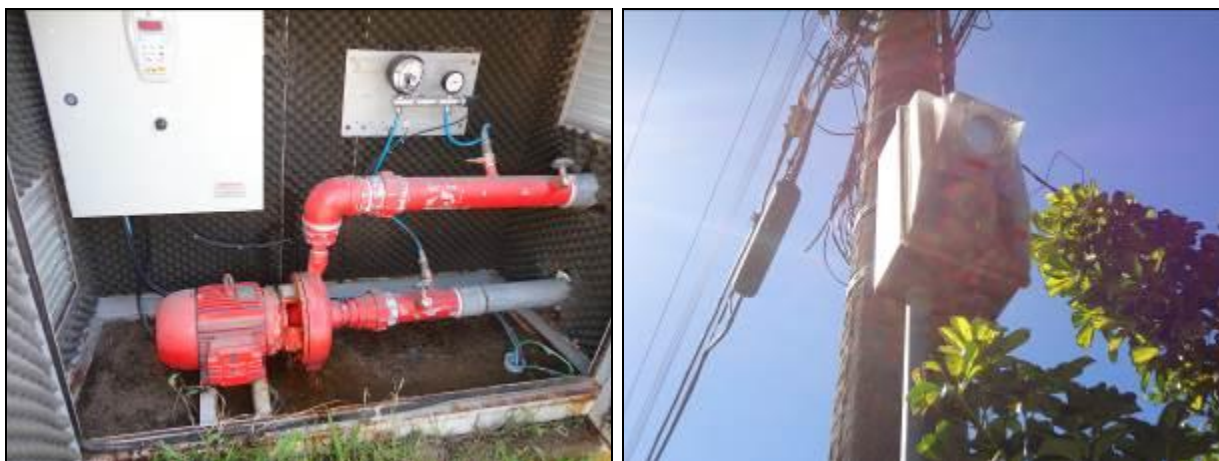
Figura 405- Vista interna com bomba e quadro de comando (à esquerda) e quadro de energia no poste (à direita)
