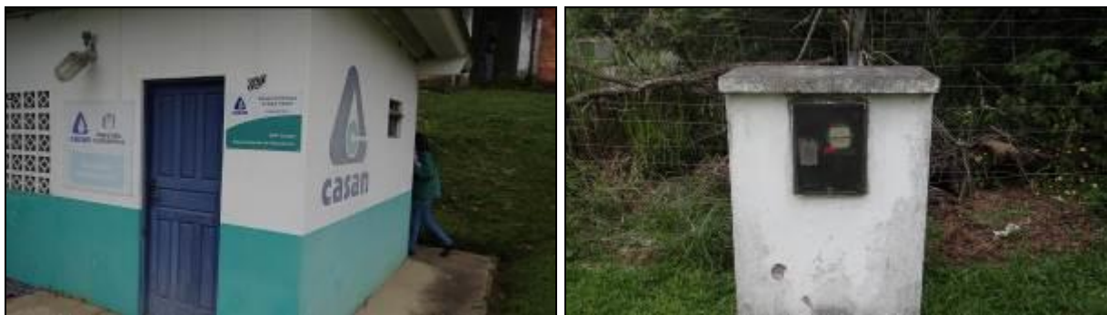
Figura 377- Vista externa no local das bombas (à esquerda) e quadro de energia (à direita)
