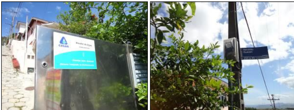
Figura 412- Placa de identificação (à esquerda) e quadro de energia no poste (à direita)
