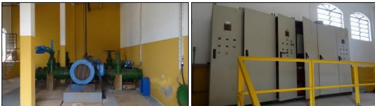
Figura 317- Bombas de recalque (à esquerda) e quadros de comando (à direita)
