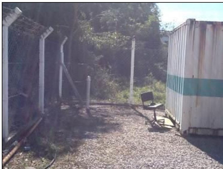
Figura 164 - Alguns trechos do cercamento da ETA (Inicial)
