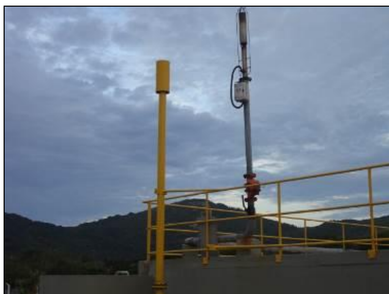
Figura 572 – Queimador de biogás (Acompanhamento)
