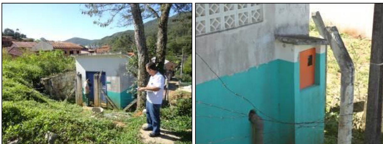
Figura 414- Vista geral da área (à esquerda) e quadro de energia (à direita)
