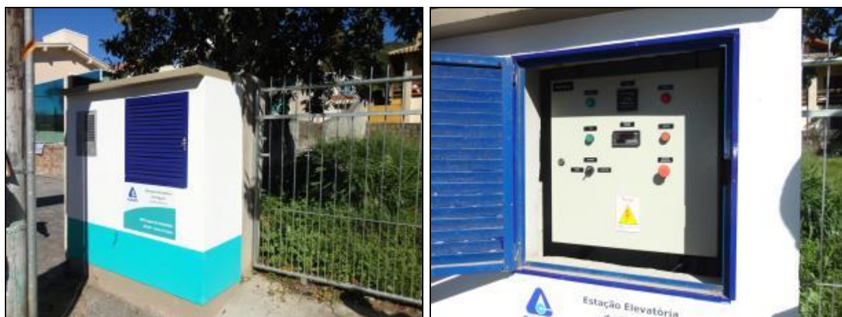
Figura 682- Vista da EEE BB Canto da Lagoa com placa de identificação e restrição de acesso, bem como a vista interna do quadro de comando
