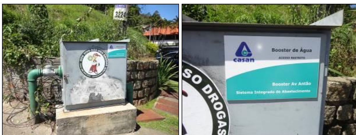
Figura 388- Vista geral do Booster com placa de identificação
