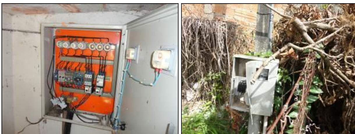
Figura 437- Quadro de comando (à esquerda) e quadro de energia (à direita)
