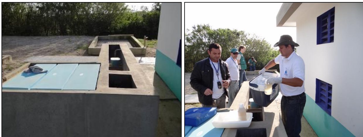
Figura 489 - Área de recepção dos efluentes da ETE e coleta de material para análise (Inicial)
