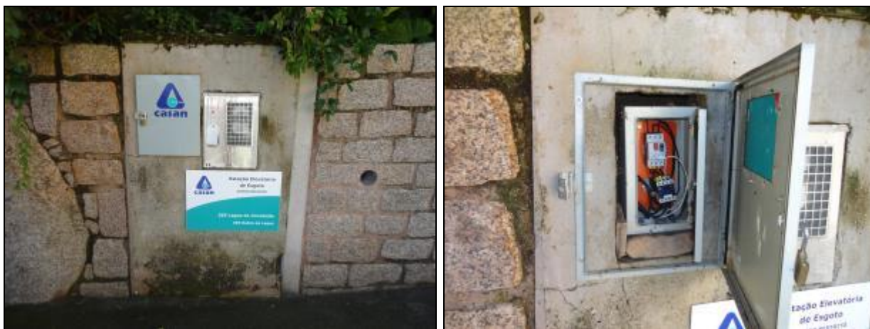
Figura 687- Vista da EEE Retiro da Lagoa com placa de identificação e restrição de acesso, bem como vista dos quadros de energia e comando
