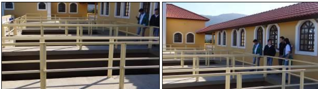
Figura 200 – Áreas de tratamento da água contam com proteção de guarda-corpo (Acompanhamento)
