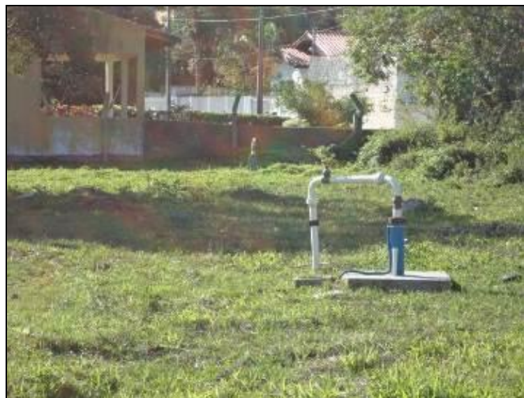
Figura 110 - Área do manancial cercada, porém não identificada (Acompanhamento)
