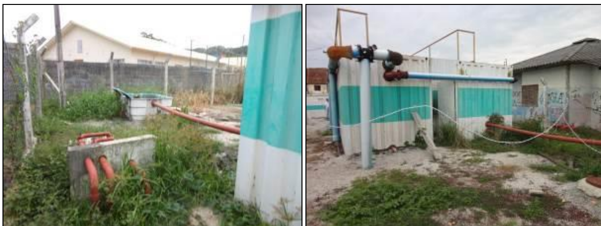
Figura 548 – Aspectos gerais das tubulações da ETE (Acompanhamento)
