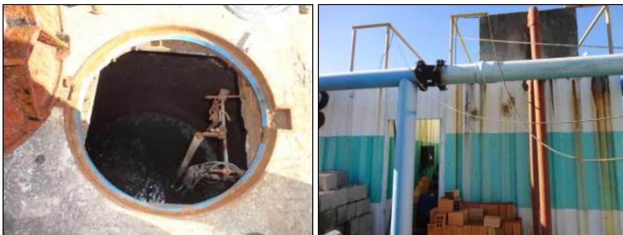
Figura 627- Interior do poço úmido (à esquerda) e tanques da ETE Vila União (à direita)
