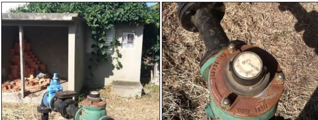
Figura 134 - Medidor de vazão (Inicial)
