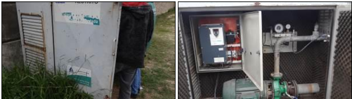
Figura 328- Vista interna e externa do Booster Graciliano Gomes
