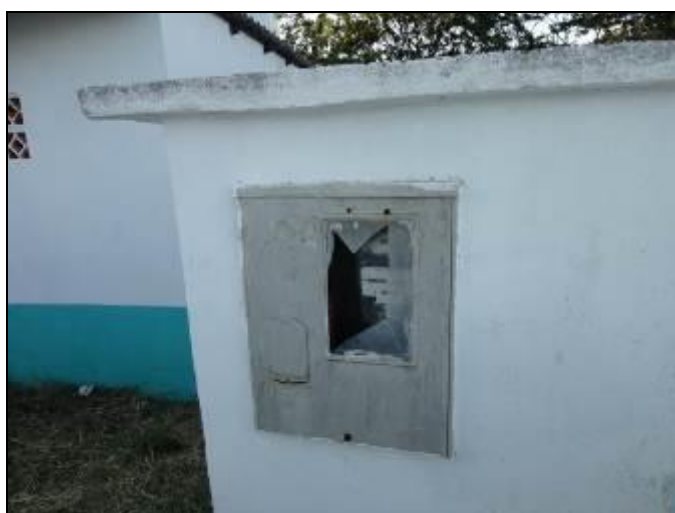
Figura 96 – Poço Moçambique – quadro de energia quebrado (Acompanhamento)
