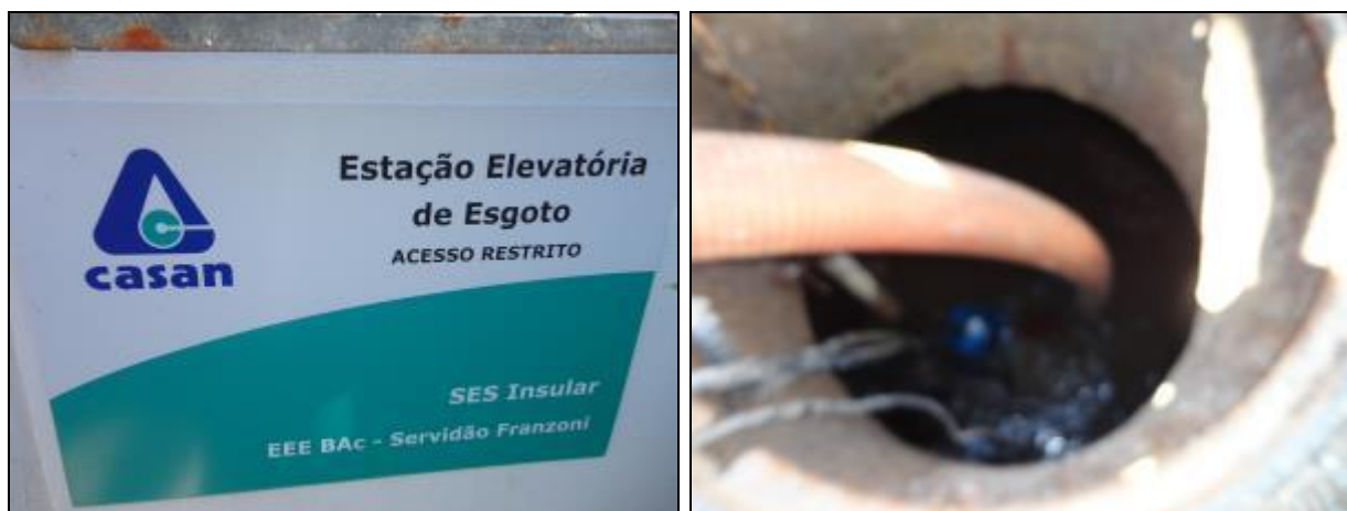
Figura 760- Placa de identificação e restrição de acesso (à esquerda) e interior do poço úmido (à direita)
