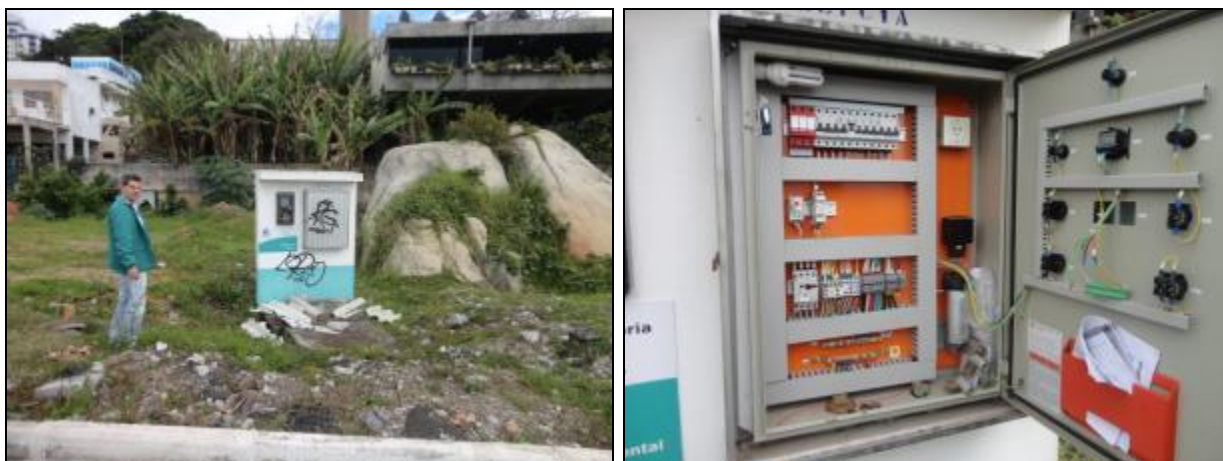
Figura 717- Vista geral da EEE PC1A abandonada, com placa de identificação e restrição de acesso (à esquerda) e quadro de comando (à direita)
