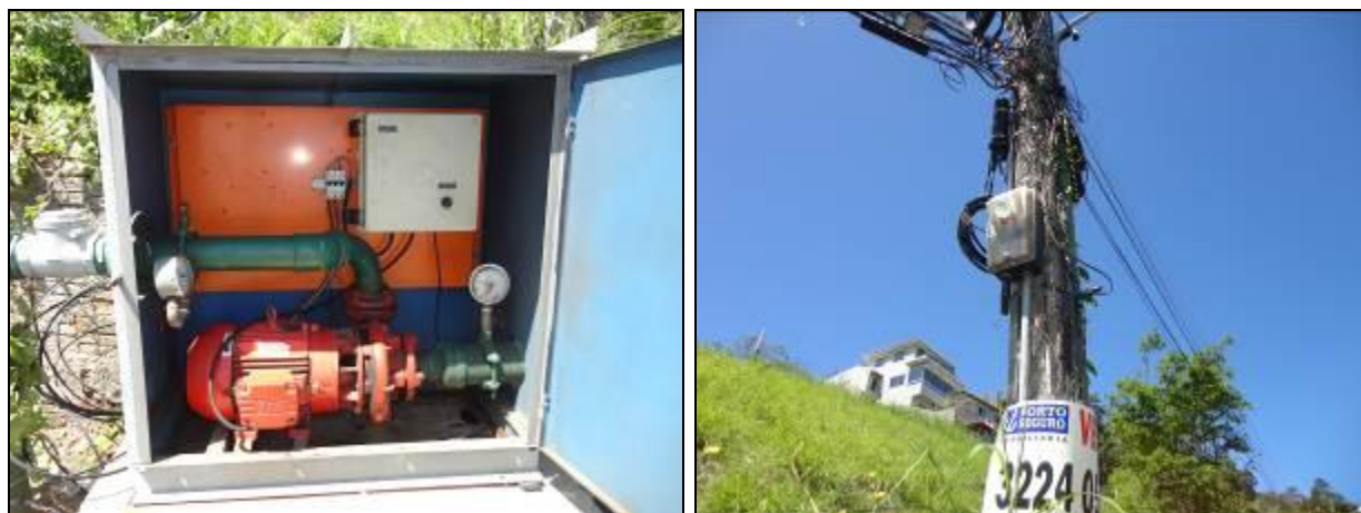
Figura 389- Vista interna com a bomba e quadro de comando (à esquerda) e quadro de energia no poste (à direita)
