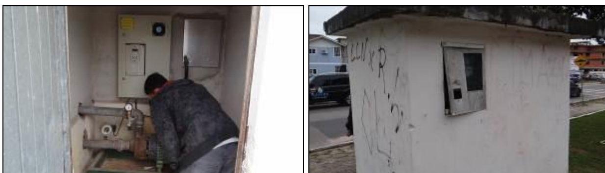
Figura 326- Vista interna com a bomba e painel de controle (à esquerda) e quadro de energia (à direita)
