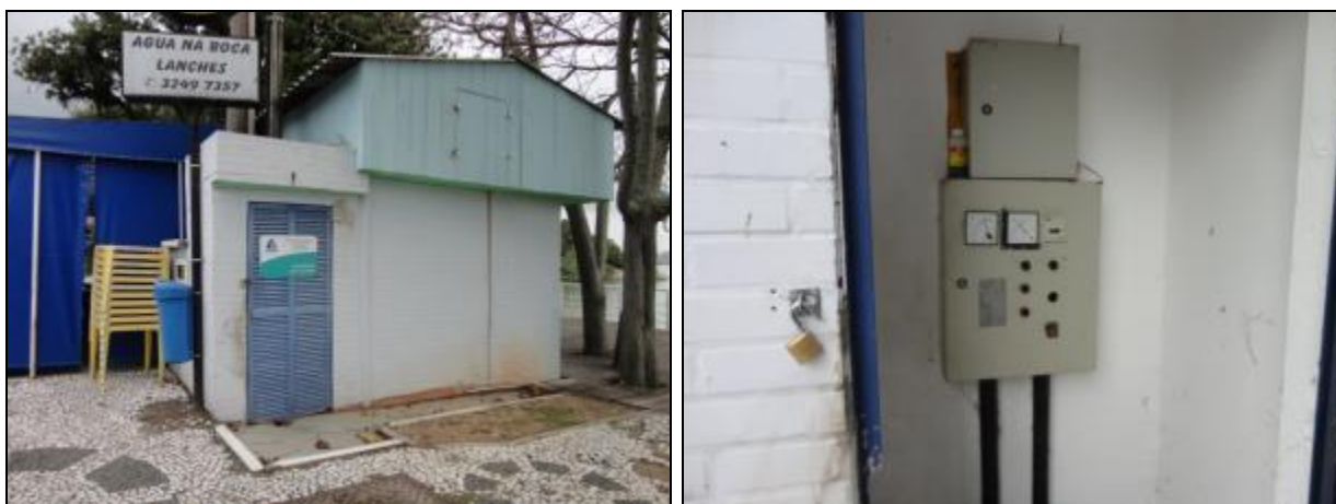
Figura 699- Vista do local da EEE J2 Bom Abrigo, com placa de identificação e restrição de acesso (à esquerda) e quadro de comando (à direita)
