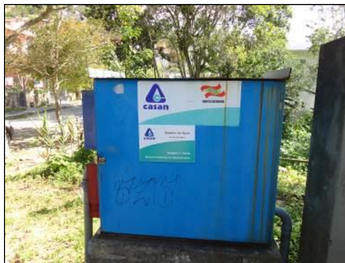
Figura 433- Vista do Booster
