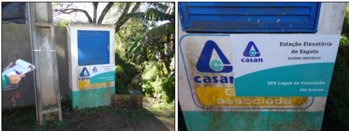
Figura 673- Vista da EEE Acácias com placa de identificação e restrição de acesso
