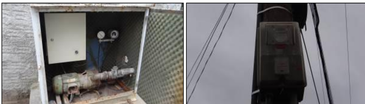
Figura 327- Vista interna com a bomba e quadro de comando (à esquerda) e quadro de energia (à direita)
