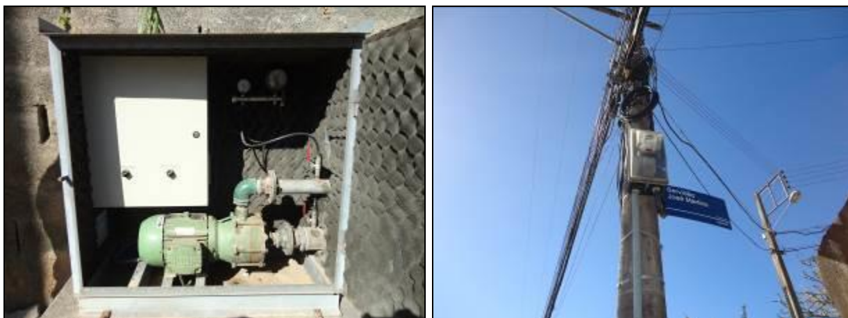
Figura 420- Vista interna com bomba e quadro de comando (à esquerda) e quadro de energia no poste (à direita)
