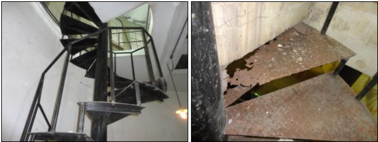
Figura 710- Condições das escadas de acesso
