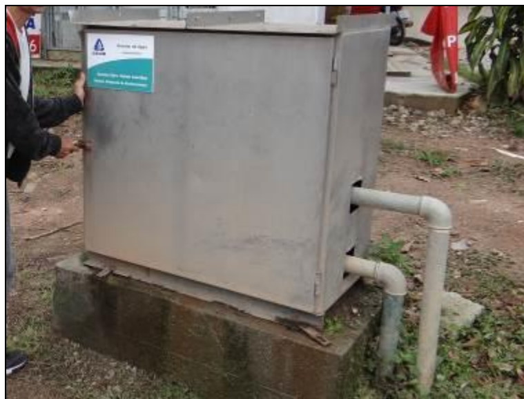
Figura 378- Vista geral do Booster Servidão Valmir Leônidas
