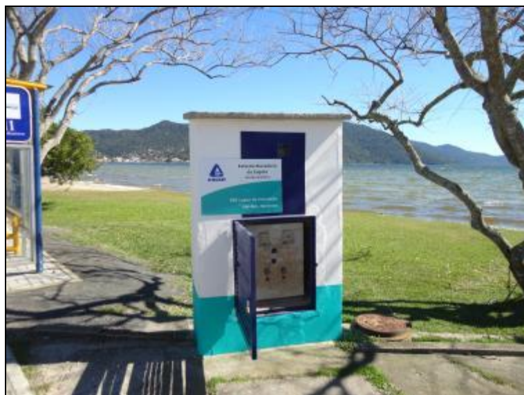
Figura 663- Vista geral da casa de comando e do quadro de energia, bem como a placa de identificação e restrição de acesso
