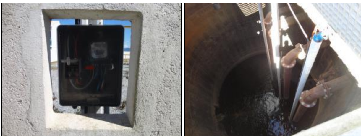
Figura 618- Quadro de energia (à esquerda) e interior do poço úmido (à direita)
