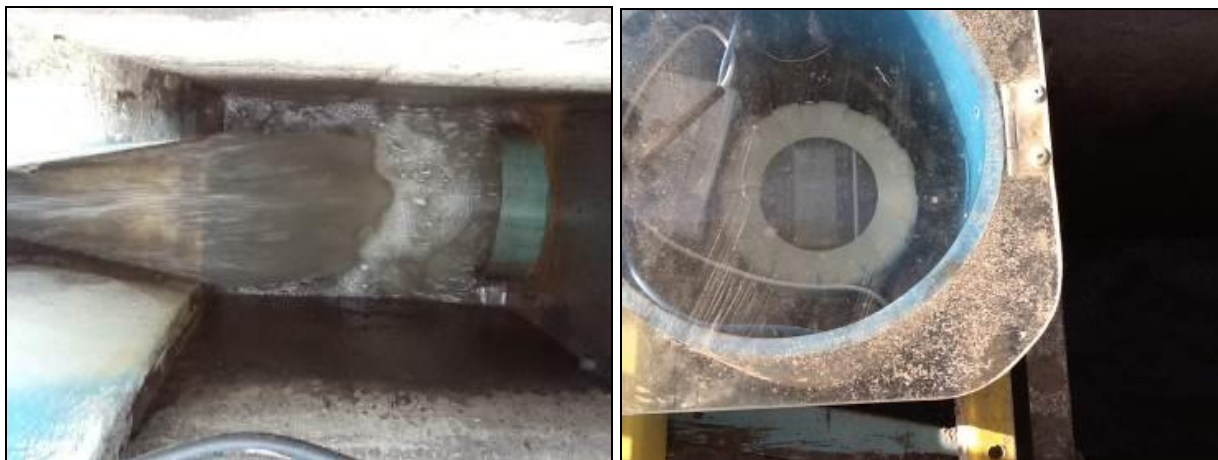
Figura 487 - Entrada do efluente e Medidor de vazão (Inicial)
