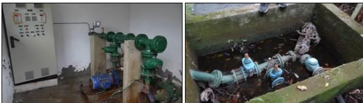
Figura 372- Vista interna com a bomba e o quadro de comando (à esquerda) e válvulas externas (à direita)
