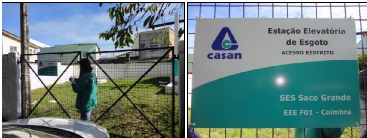
Figura 640- Portão de acesso a EEE F01 Coimbra com placa de identificação e restrição de acesso
