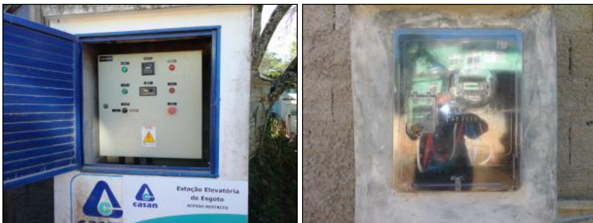
Figura 674- Quadro de comando (à esquerda) e quadro de energia (à direita)
