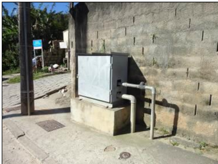
Figura 419- Vista geral do Booster
