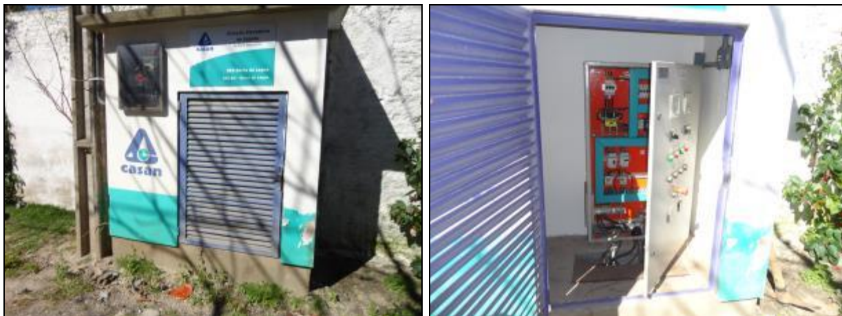
Figura 659- Vista externa e interna da casa de comando, com placas de identificação e restrição
