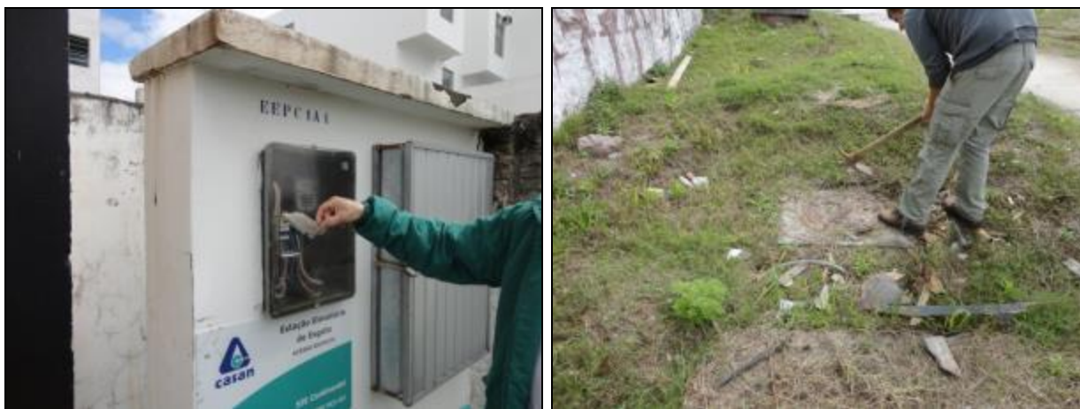
Figura 720- Quadro de energia sem cadeado (à esquerda) e vista externa do poço úmido (à direita)
