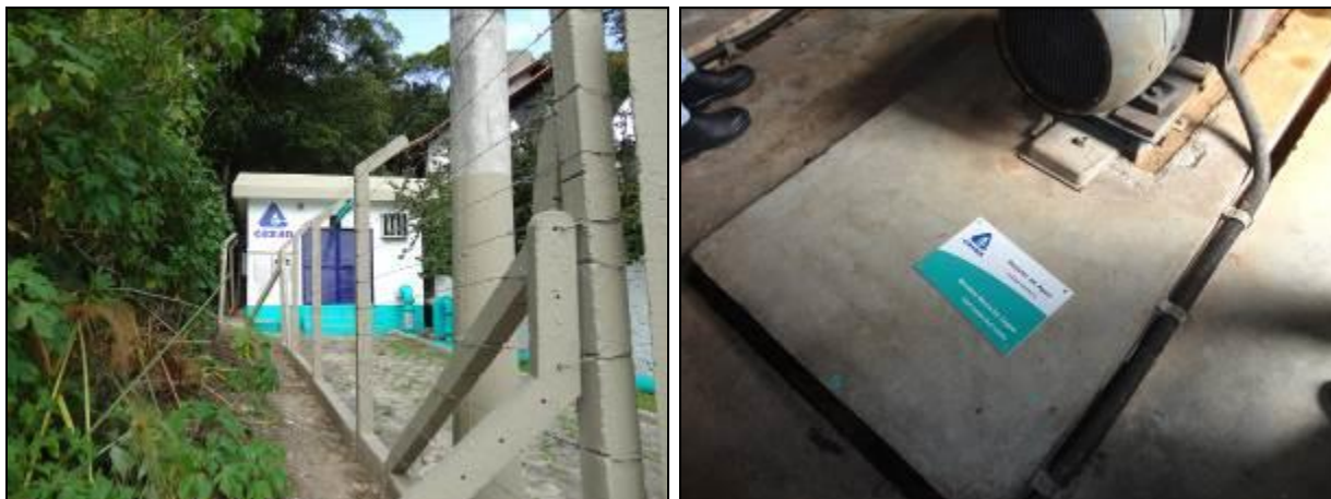
Figura 306- Vista geral do Booster Barra da Lagoa com a placa de identificação caída no chão
