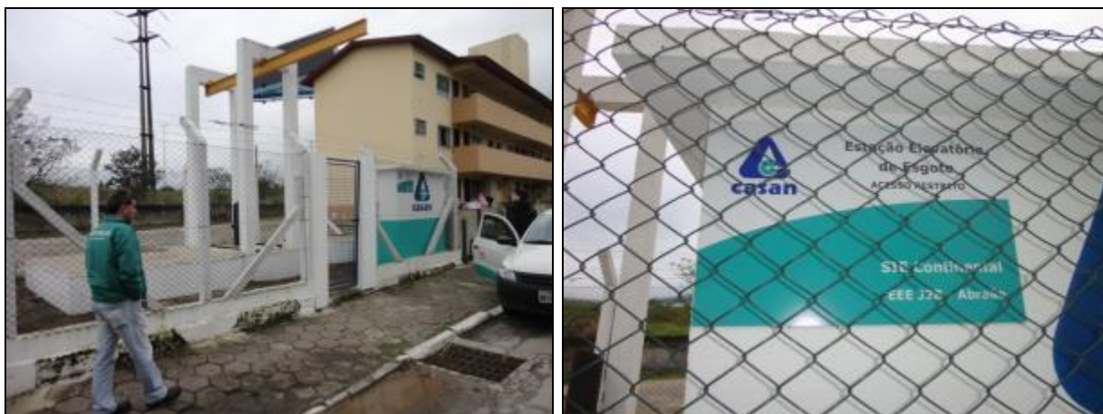
Figura 702- Vista geral da EEE J2B Abraão com placa de identificação e restrição de acesso
