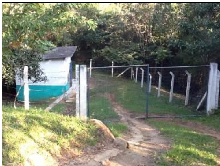
Figura 45 - Área do manancial não dispõe de identificação e isolamento é parcial (Inicial)
