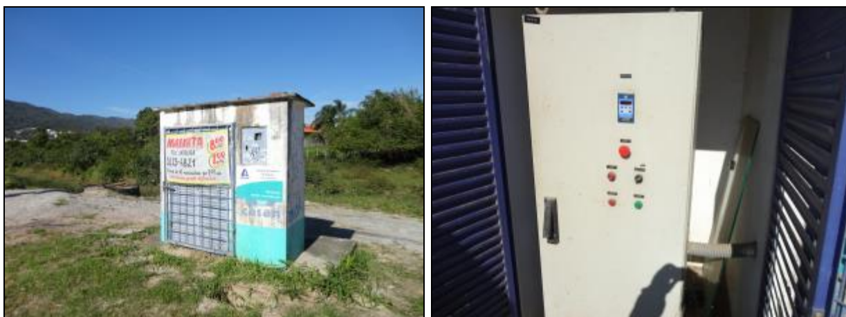
Figura 748- Vista da EEE Parque São Jorge com placa de identificação e restrição de acesso, bem como o quadro de energia (à esquerda) e quadro de comando (à direita). É possível perceber que a estrutura está pichada e com cartazes
