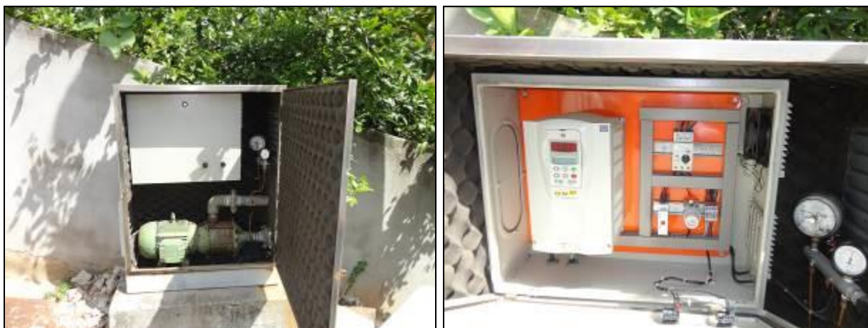
Figura 413- Vista interna do Booster com bomba e quadro de comando
