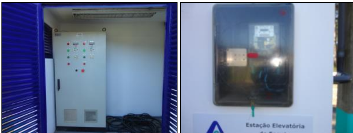
Figura 650- Quadro de comando (à esquerda) e quadro de energia (à direita)
