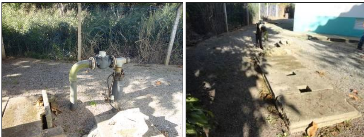
Figura 333- Vista do Poço I da ETA Ingleses
