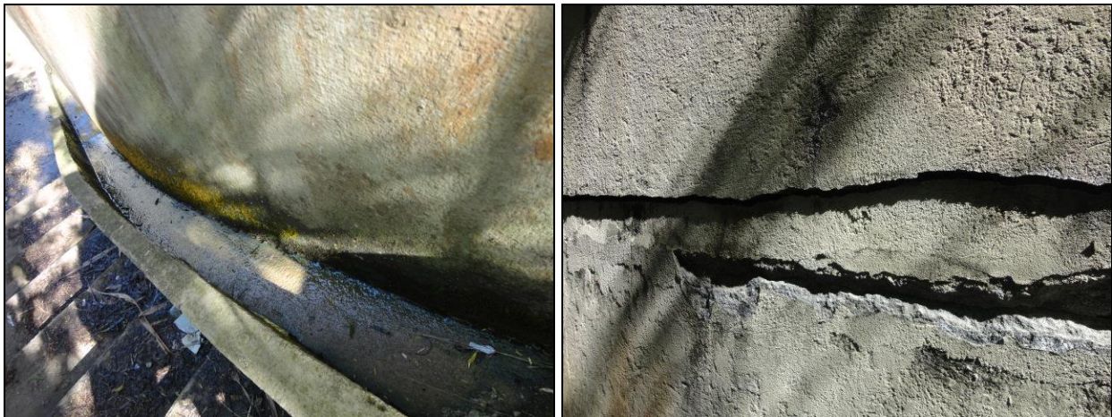
Figura 225 – R-01 – Centro – Reservatório apresenta vazamentos e rachaduras (Acompanhamento)
