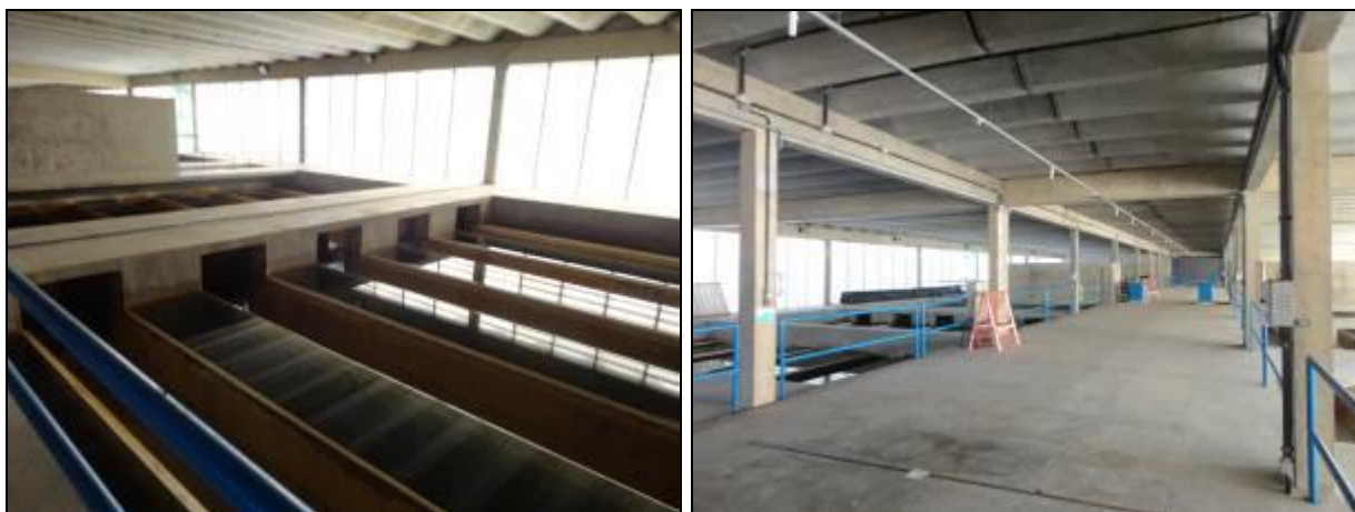
Figura 156 – Áreas de tratamento físico da água (Acompanhamento)
