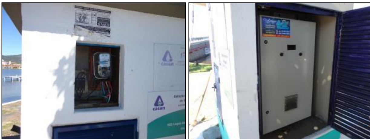
Figura 671- Quadro de energia sem a porta (à esquerda) e quadro de comando (à direita)
