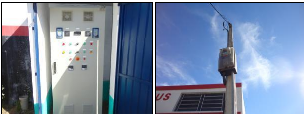
Figura 736- Quadro de comando (à esquerda) e quadro de energia (à direita)
