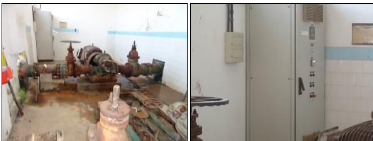
Figura 399- Bomba de 200 CV (à esquerda) e quadro de comando (à direita)
