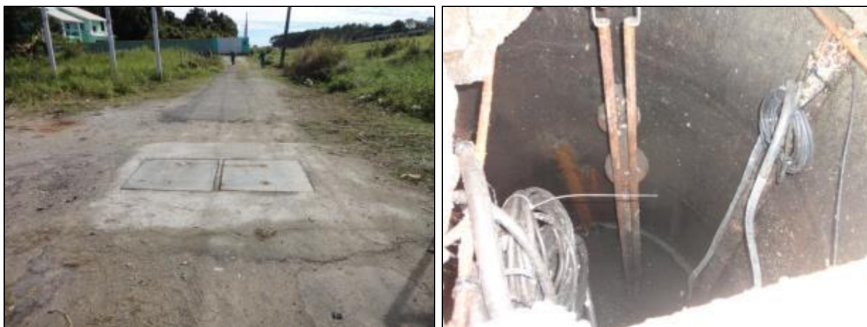
Figura 636- Vista externa e interior do poço úmido
