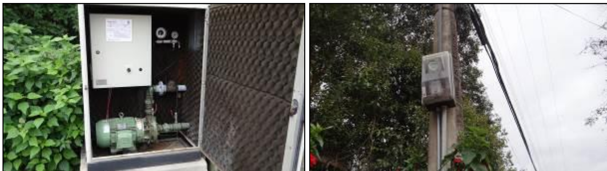
Figura 441- Vista interna com bomba e quadro de comando (à esquerda) e quadro de energia no poste (à direita)
