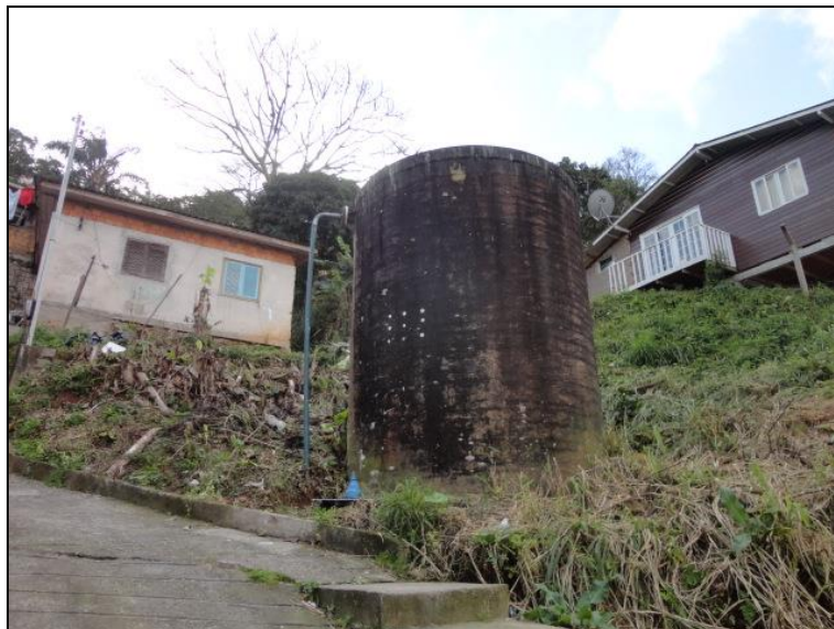
Figura 257 - Caieira – Reservatório abandonado (Acompanhamento)
