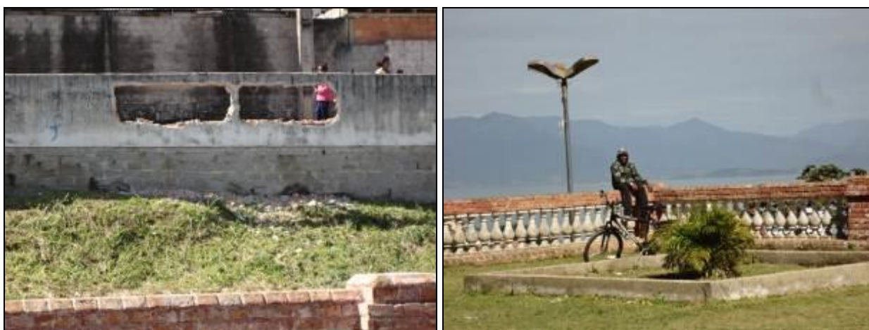
Figura 221 – R-0 - Centro – Imagens de invasão de pessoas estranhas na área do reservatório (Acompanhamento)
