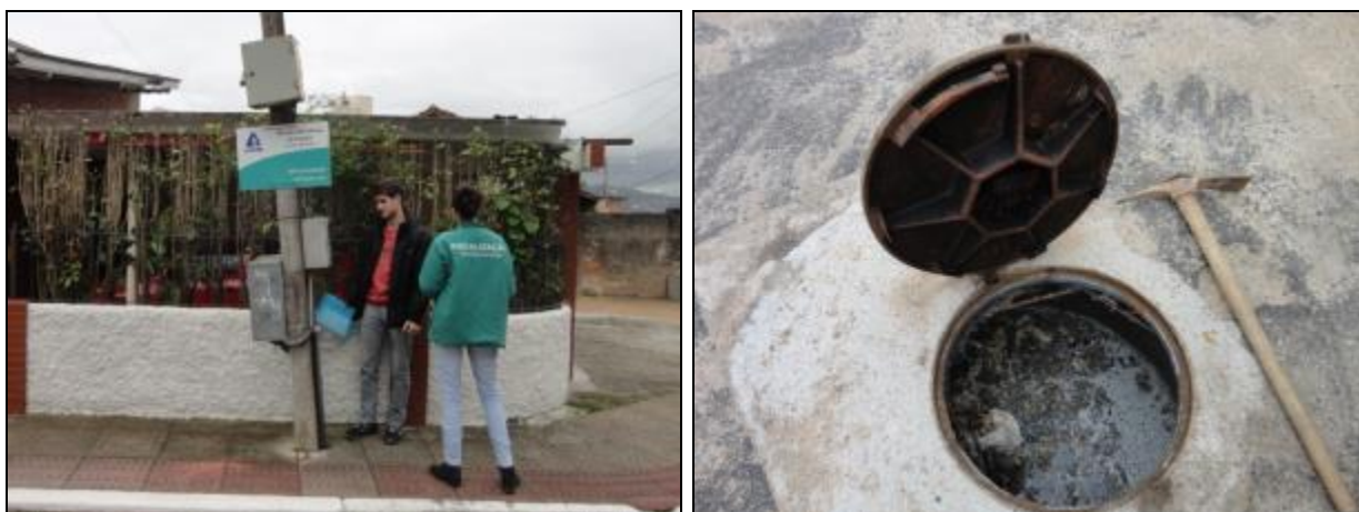
Figura 694- Vista geral da estrutura da EEE Bento Goiás (à esquerda) e interior do poço úmido (à direita)
