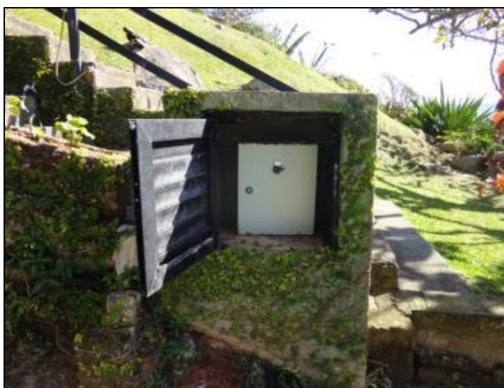
Figura 608- Vista do quadro de comando
