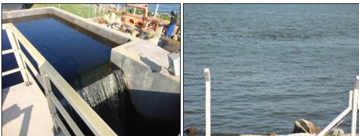
Figura 473 – Imagem do efluente e área de lançamento da ETE (Acompanhamento)
