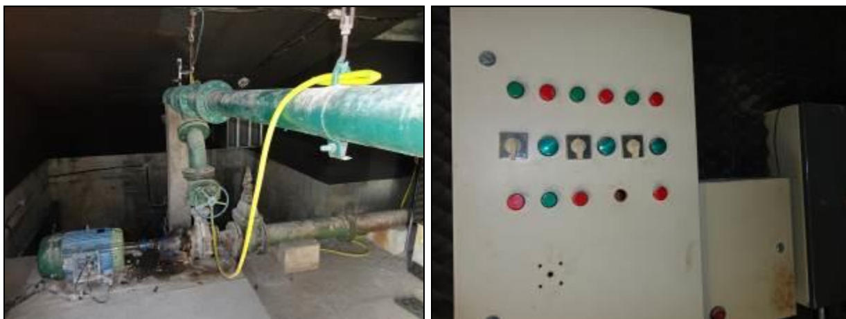
Figura 423- Bombas (à esquerda) e quadro de comando (à direita)
