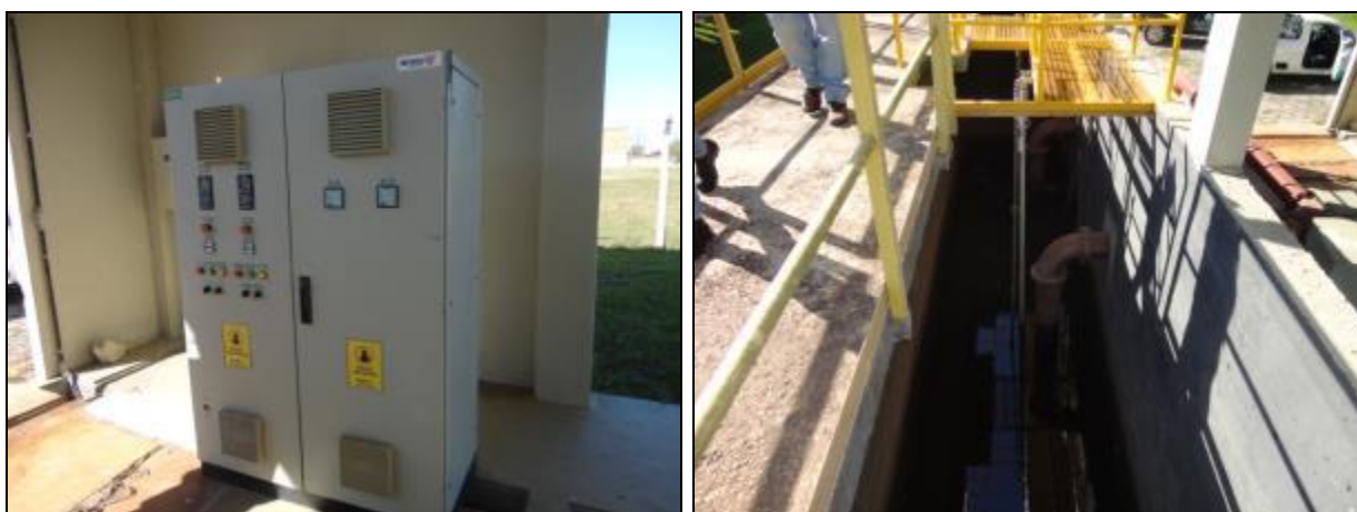
Figura 630- Quadro de comando (à esquerda) e poço úmido (à direita)
