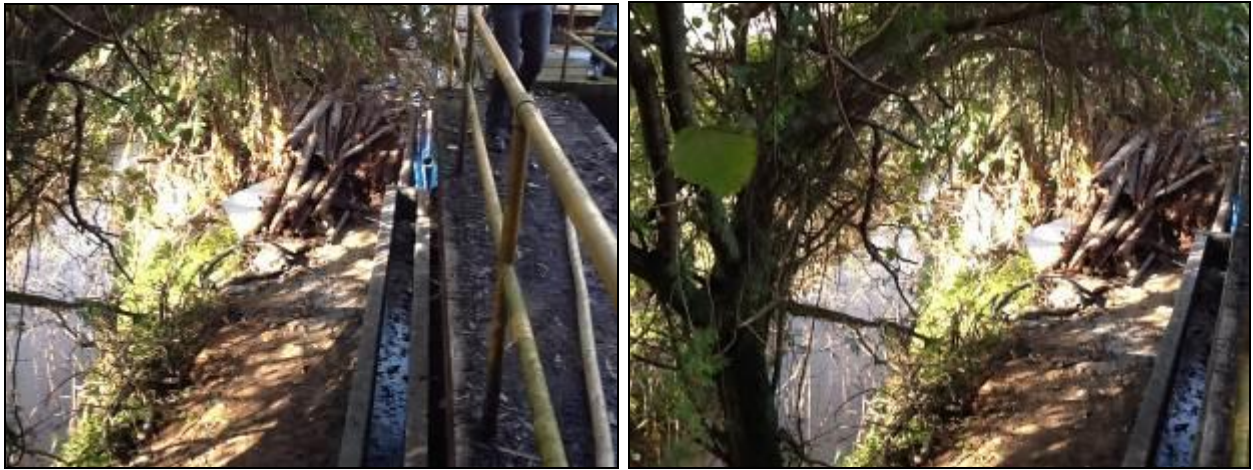
Figura 499 - Estruturas em péssimas condições (Inicial)
