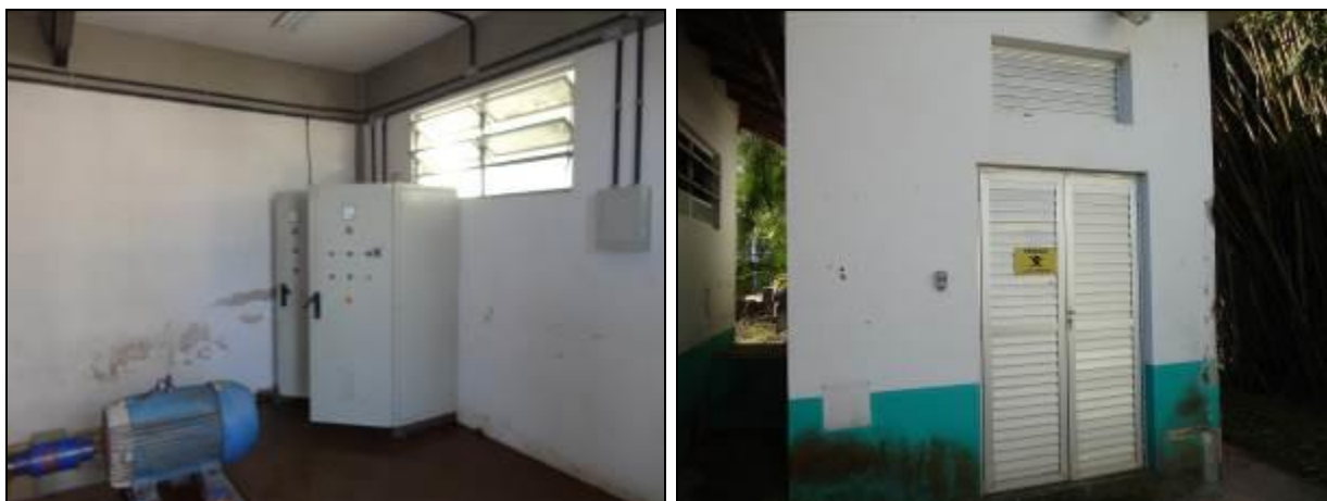
Figura 428- Quadro de comando
