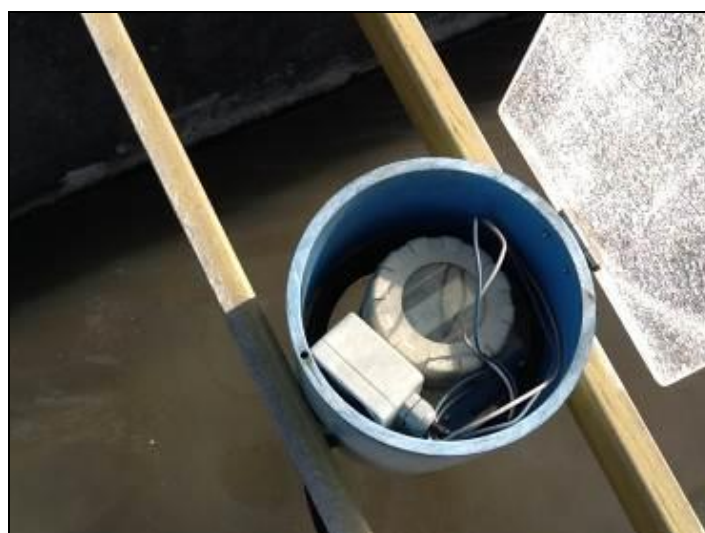
Figura 568 - Medidor de vazão (Inicial)
