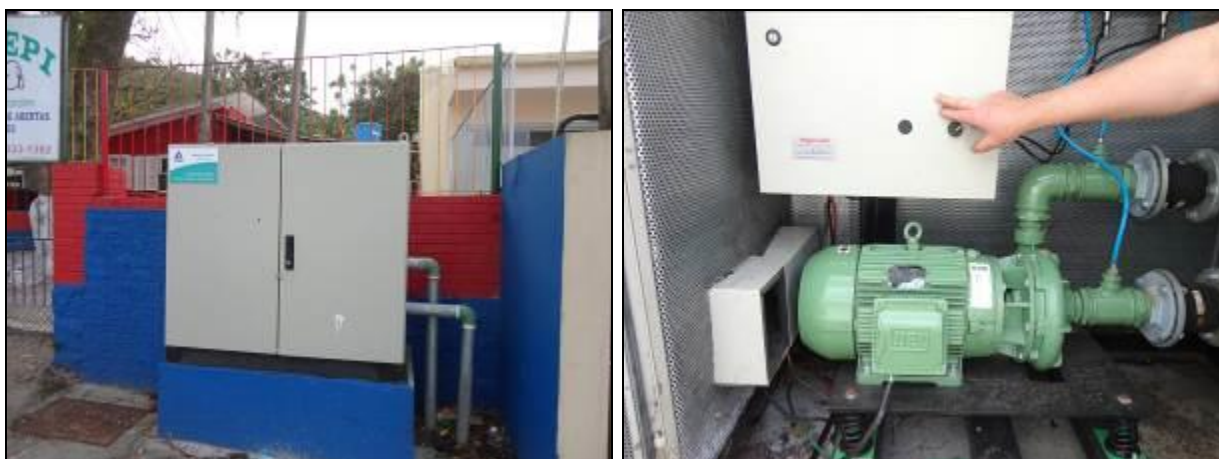
Figura 452- Vista externa e interna do Booster Alvaro Ramos
