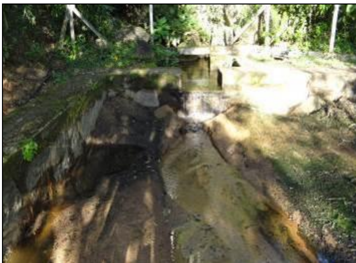
Figura 26 - Área do manancial sem cercas nem placas (Acompanhamento)
