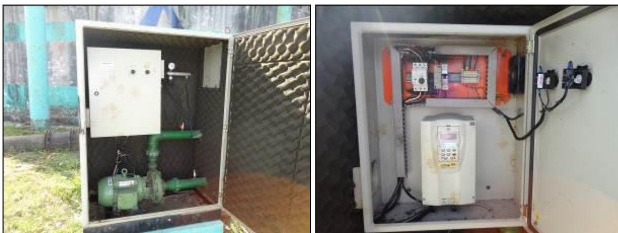
Figura 447- Vista interna com bomba e quadro de comando
