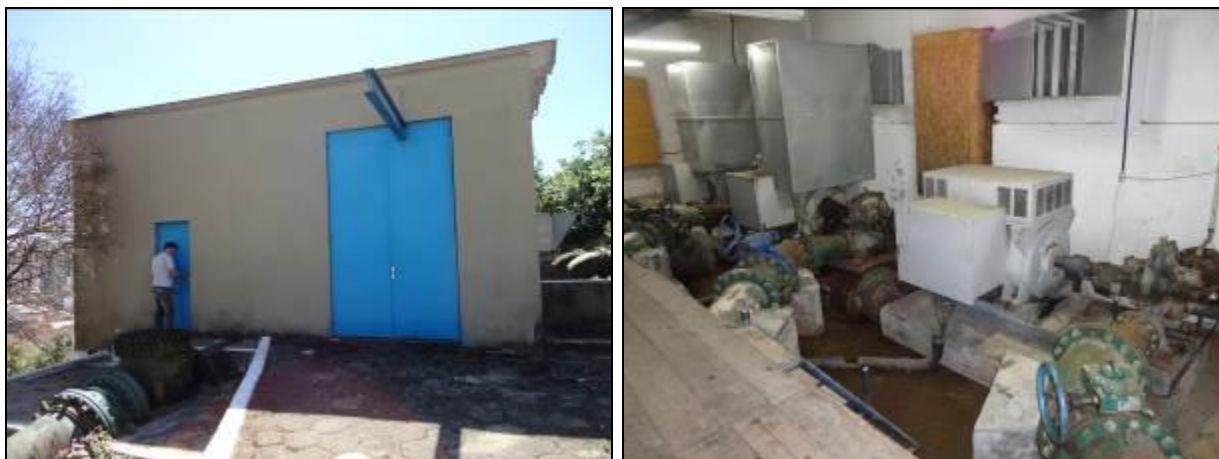
Figura 398- Vista externa e interna da casa de bombas com três bombas de 500CV cada
