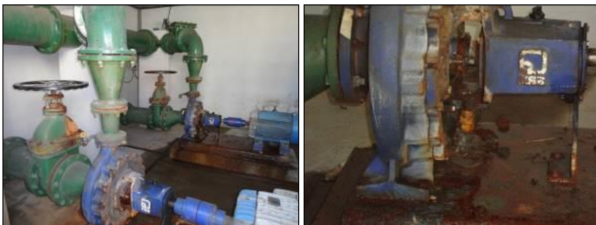
Figura 427- Bombas com vazamento
