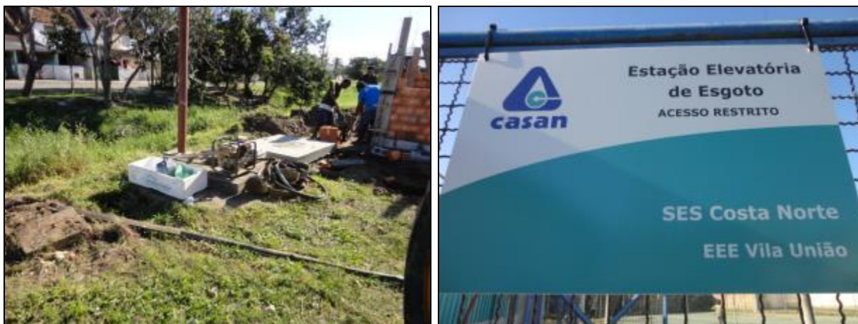
Figura 625- Obras na EEE Vila União (à esquerda) e placa de identifica e restrição de acesso (à direita)
