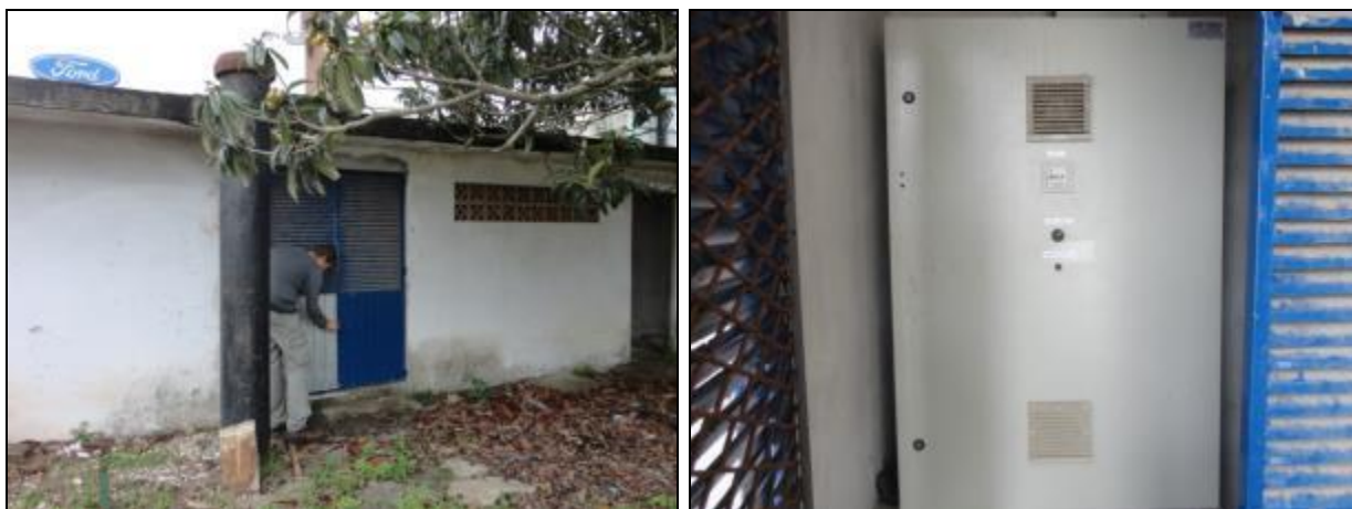
Figura 693- Vista externa e interna do quadro de comando
