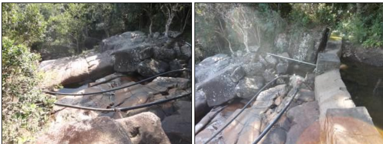
Figura 62 - Equipamentos de captação (Acompanhamento)
