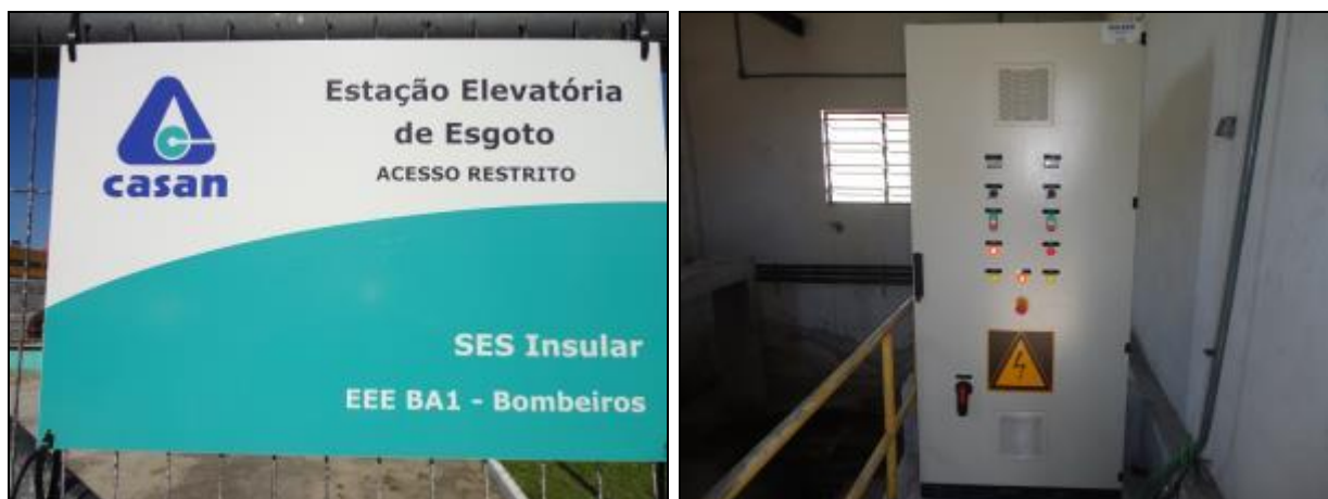
Figura 756- Placa de identificação e restrição de acesso (à esquerda) e quadro de comando (à direita)
