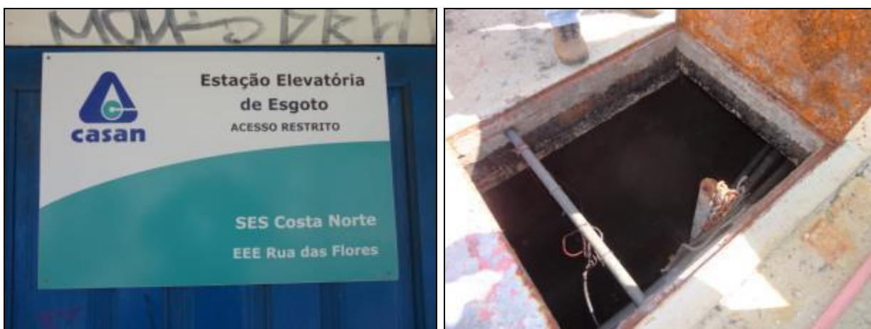
Figura 604- Placa de identificação e restrição de acesso (à esquerda) e poço úmido (à direita)
