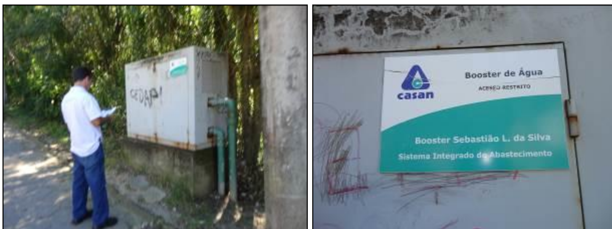
Figura 406- Vista do Booster com placa de identificação
