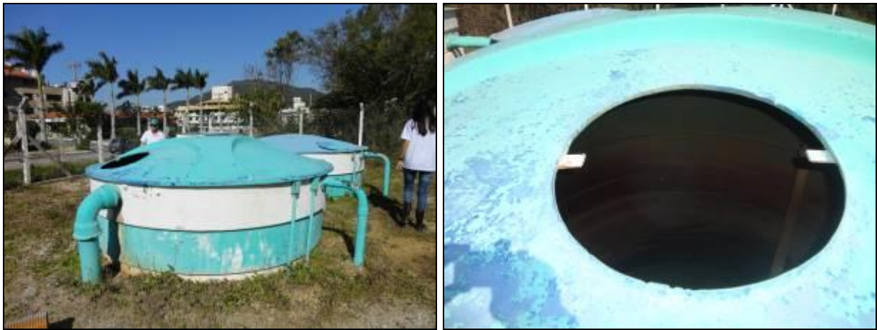
Figura 168 – Reservatório em mau estado de conservação, sem tampa (Acompanhamento)
