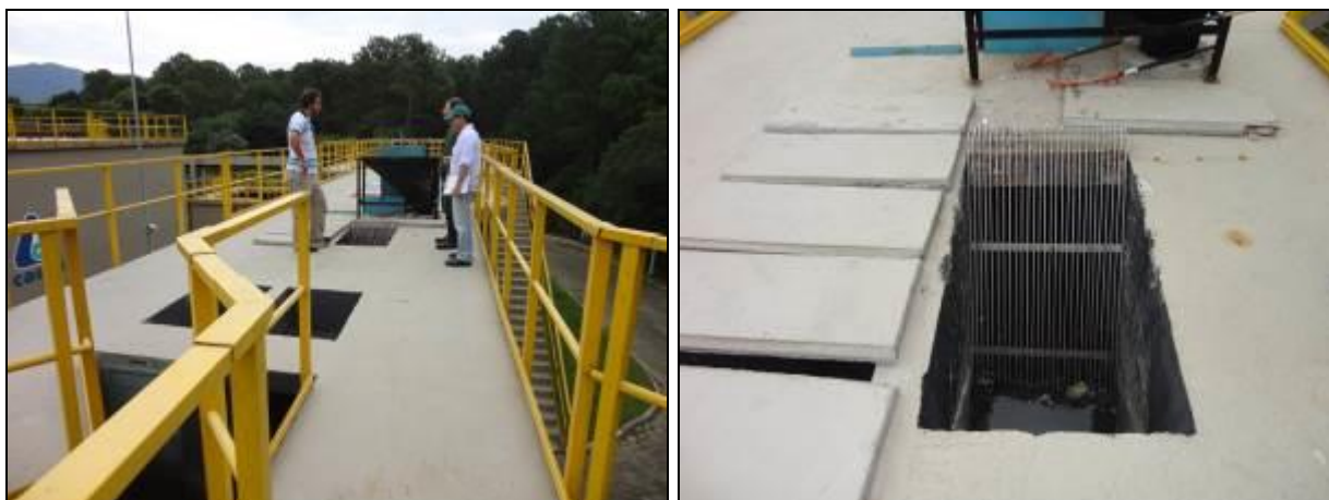
Figura 583 – Área de entrada do Efluente Bruta e Gradeamento (Acompanhamento)
