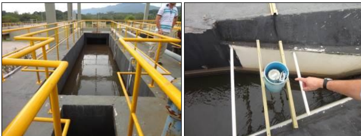
Figura 517 – Efluente bruto e Medidor de Vazão (Acompanhamento)
