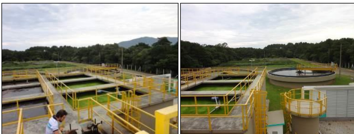
Figura 579 – Lagoa de estabilização (à esquerda) e decantador (à direita) (Acompanhamento)
