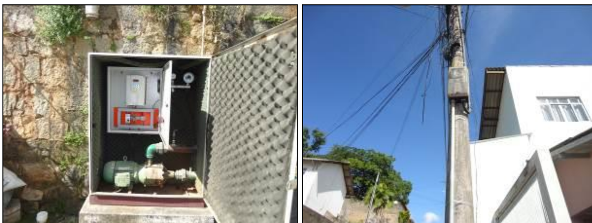
Figura 435- Vista interna com bomba e quadro de comando (à esquerda) e quadro de energia no poste (à direita)
