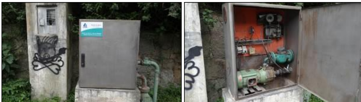
Figura 442- Vista externa e interna do Booster
