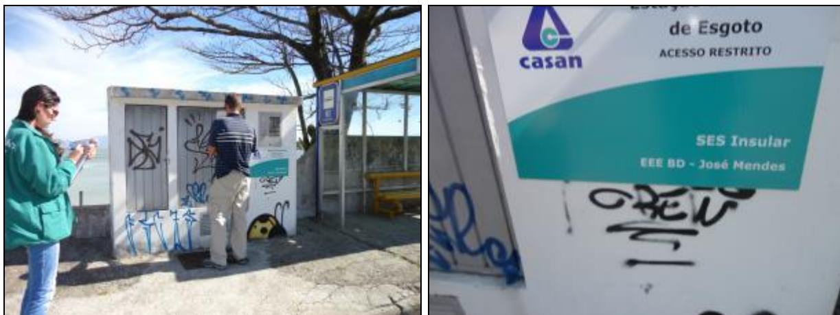
Figura 724- Vista geral da EEE BD José Mendes com placa de identificação e restrição de acesso
