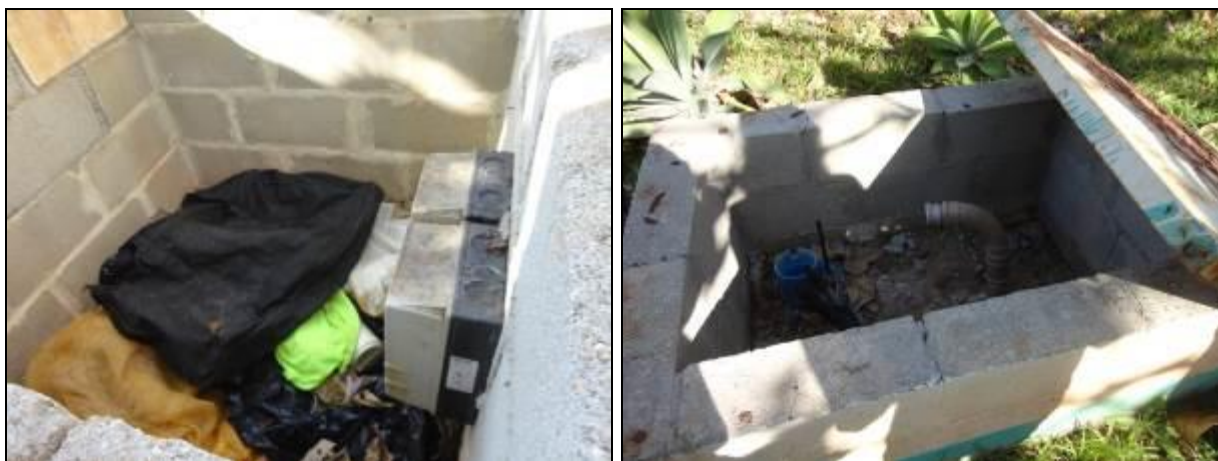
Figura 350- Poço 3 desativado (à esquerda) e Poço 4 (à direita)
