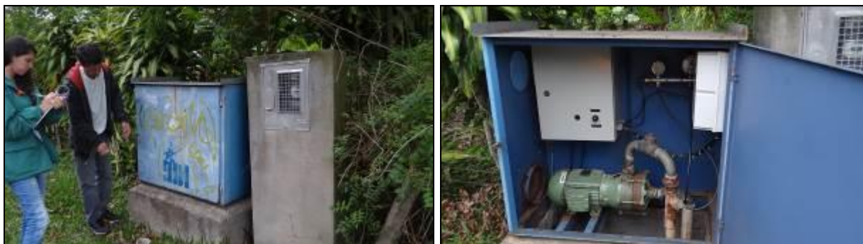
Figura 356- Vista externa e interna do Booster Muquém
