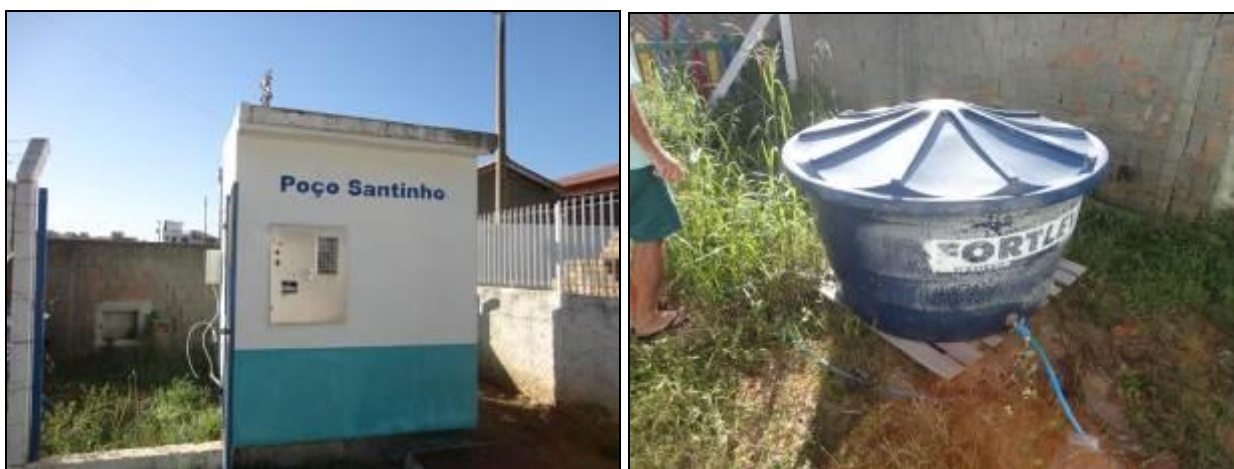
Figura 101 - Área do manancial cercada – Apresenta vazamento na caixa, registro com defeito (Acompanhamento)
