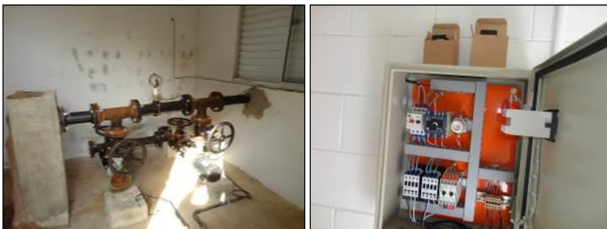
Figura 425- Bomba (à esquerda) e quadro de comando (à direita)
