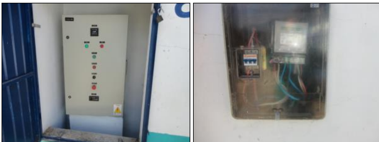
Figura 638- Vista interna da casa de comando (à esquerda) e quadro de energia (à direita)
