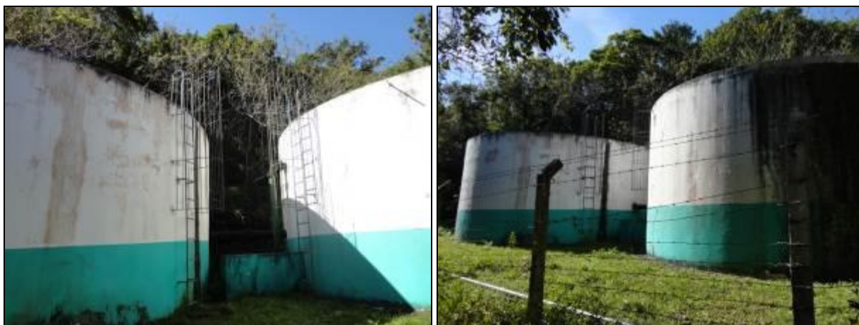
Figura 271 – Reservatório Monte Verde e Reservatório Parque da Figueira (Acompanhamento)
