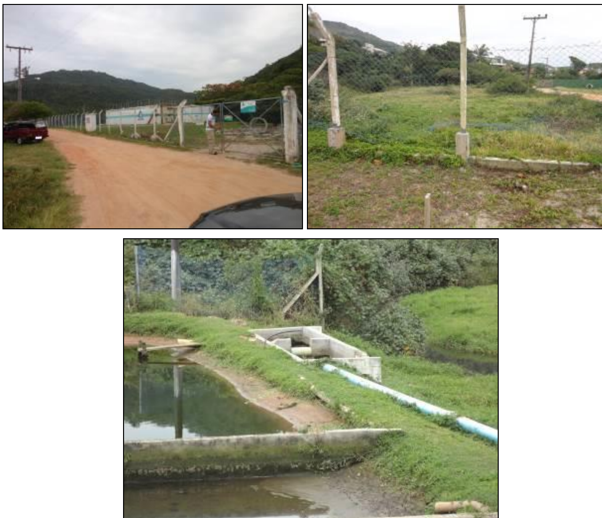
Figura 527 – Área é cercada parcialmente e apresenta danos na cerca (Acompanhamento)
