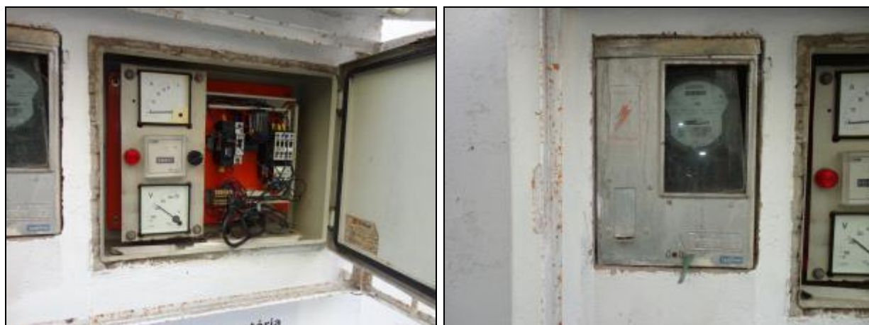
Figura 769- Quadro de comando (à esquerda) e quadro de energia (à direita)
