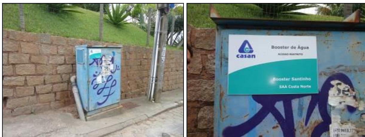
Figura 344- Vista geral do Booster Santinho com placa de identificação
