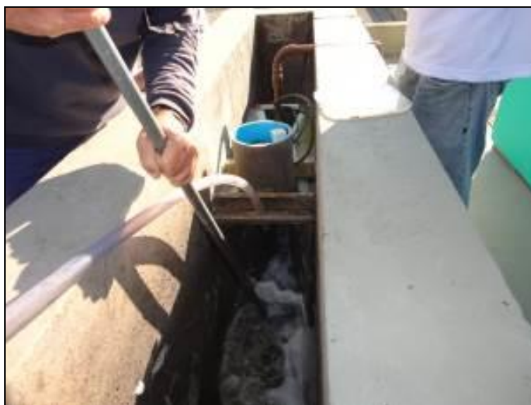
Figura 490 – Área de recepção dos efluentes da ETE (Acompanhamento)
