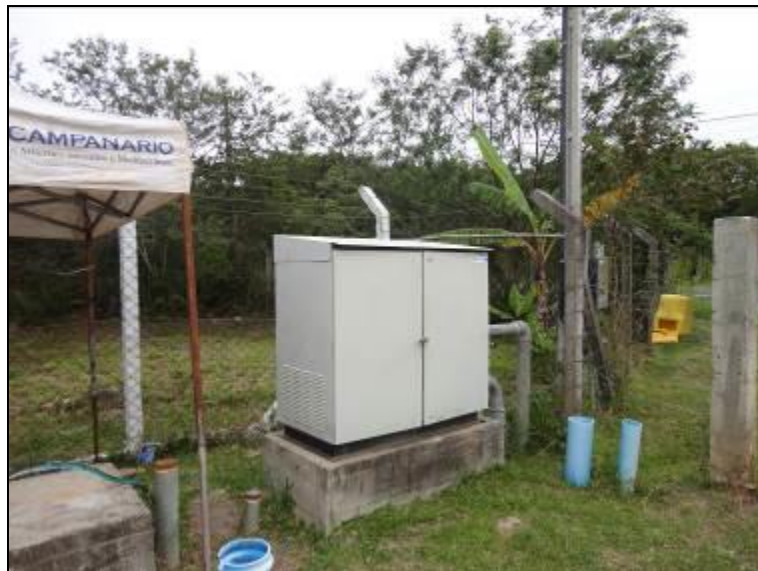
Figura 373- Vista externa do Booster Daniela
