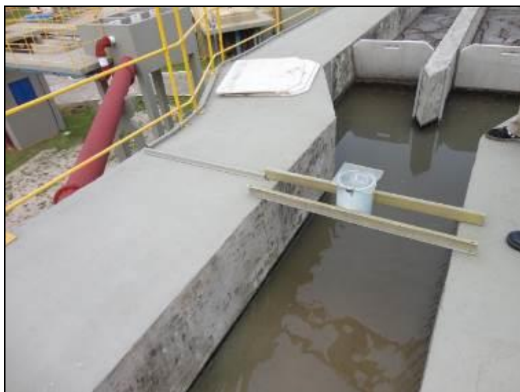
Figura 569 – Medidor de Vazão (Acompanhamento)
