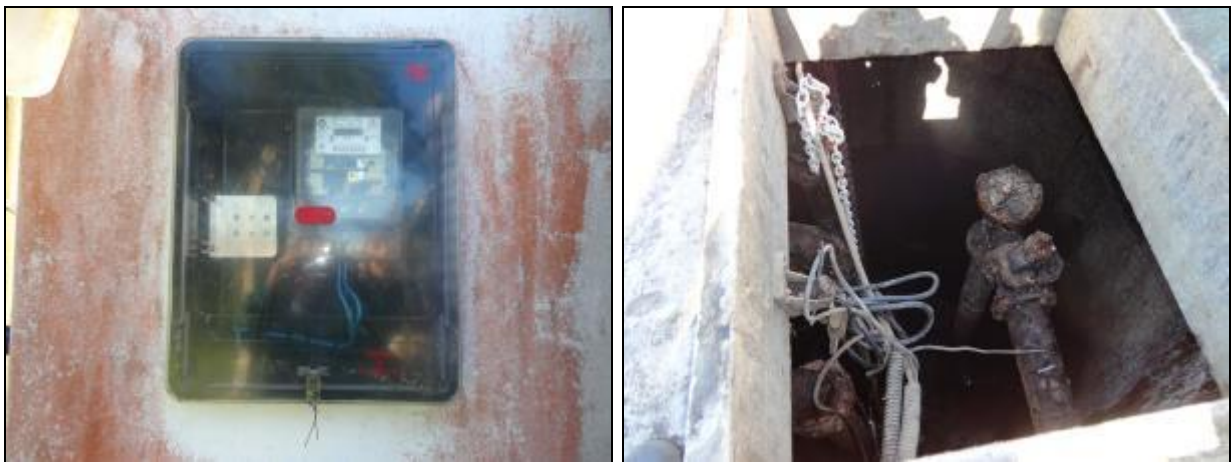
Figura 656- Quadro de energia (à esquerda) e interior do poço úmido (à direita)
