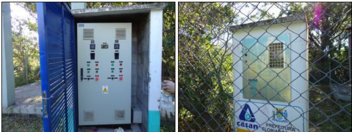
Figura 677- Quadro de comando (à esquerda) e quadro de energia (à direita)
