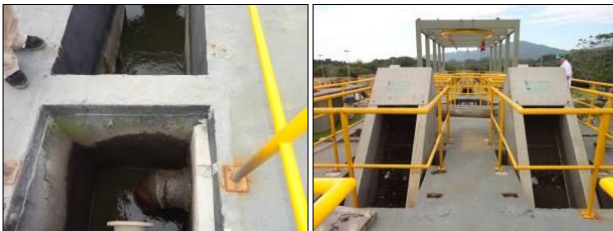
Figura 520 – Efluente bruto e área de recepção com gradeamento (Acompanhamento)
