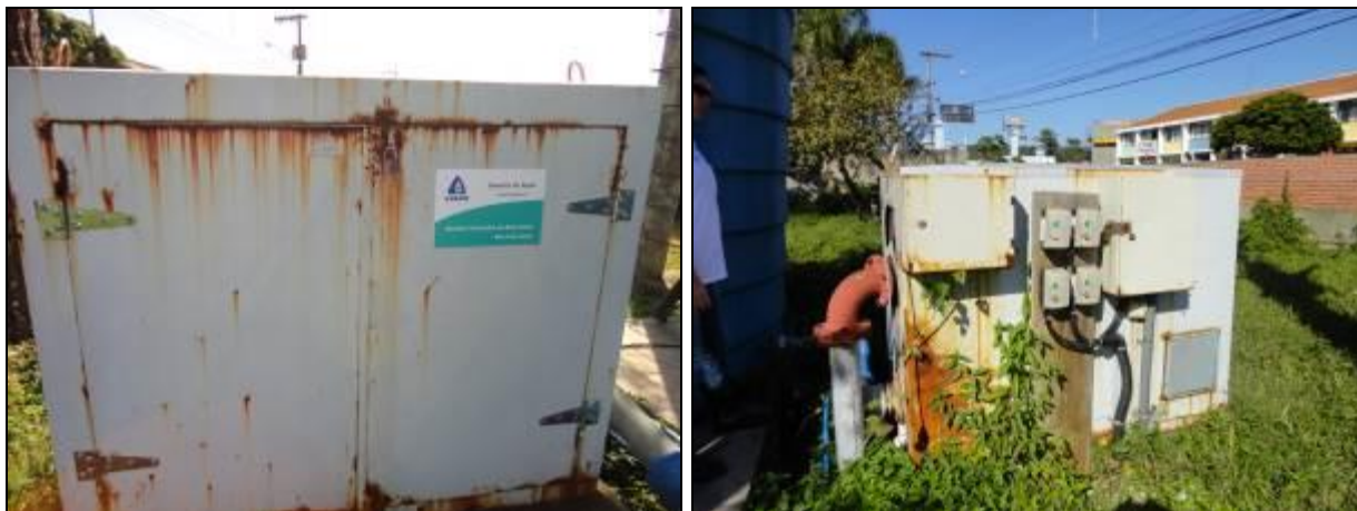
Figura 319- Vista do Booster Cachoeira do Bom Jesus
