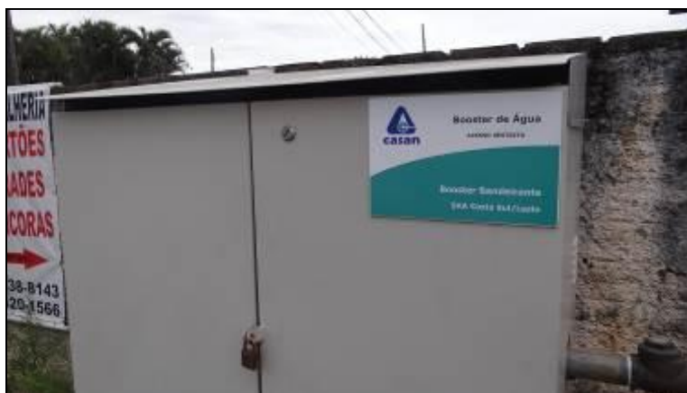
Figura 312- Vista do Booster Bandeirantes com placa de identificação
