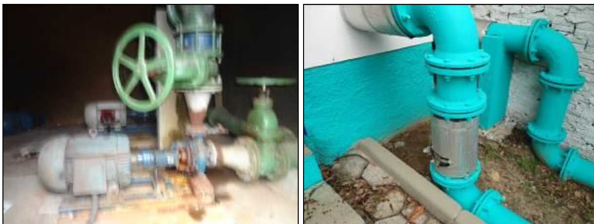
Figura 307- Bombas e recalques
