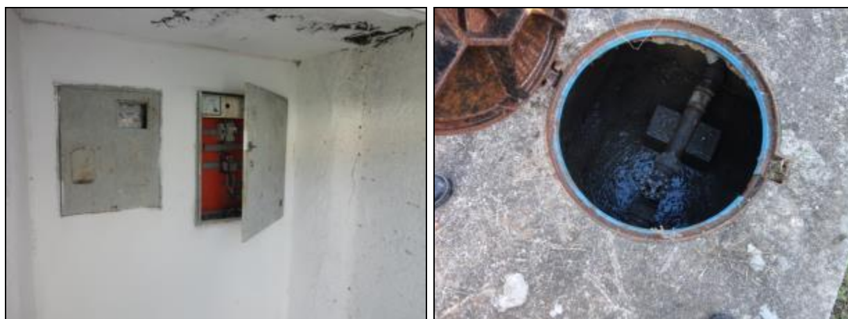
Figura 646- Quadro de comando e energia (à esquerda) e interior do poço úmido (à direita)
