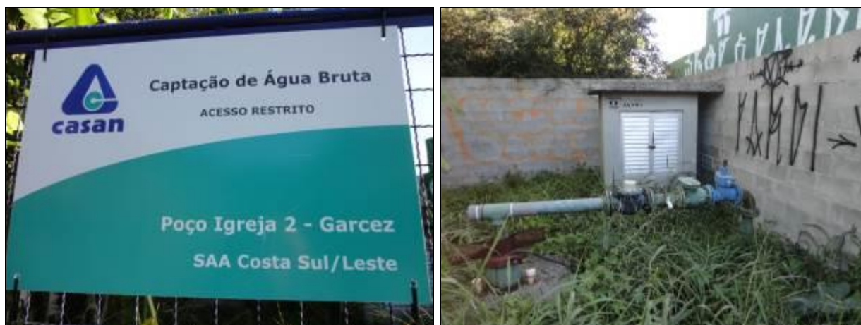
Figura 318- Placa de identificação (à esquerda) e vista da bomba com o quadro de comando (à direita)
