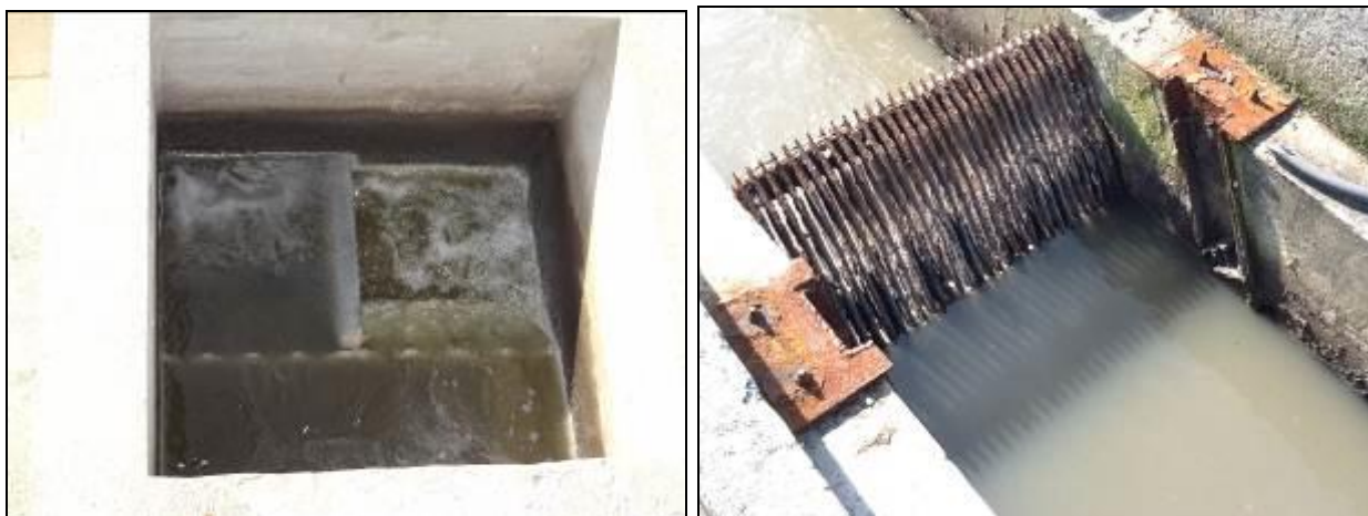
Figura 570 - Entrada do efluente e gradeamento para separação dos sólidos (Inicial)
