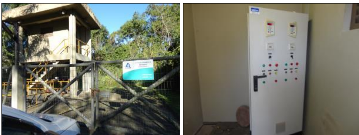
Figura 741- Vista da EEE SB6 HU com placa de identificação e restrição de acesso (à esquerda) e quadro de comando (à direita)
