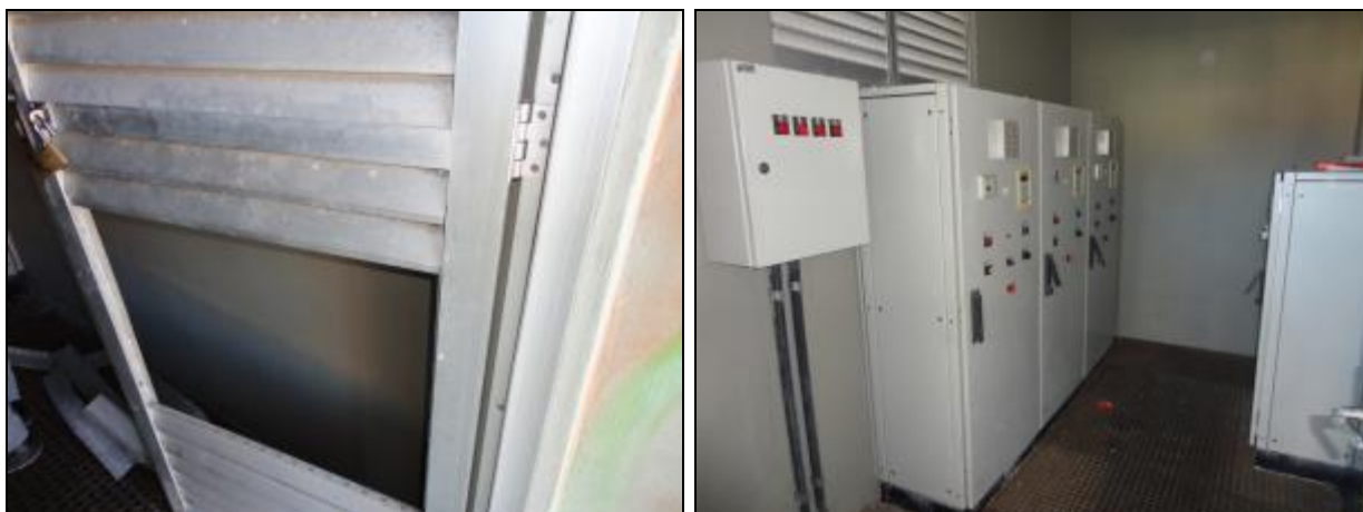
Figura 744- Porta da cada de comando arrombada (à esquerda) e quadros de comando (à direita)
