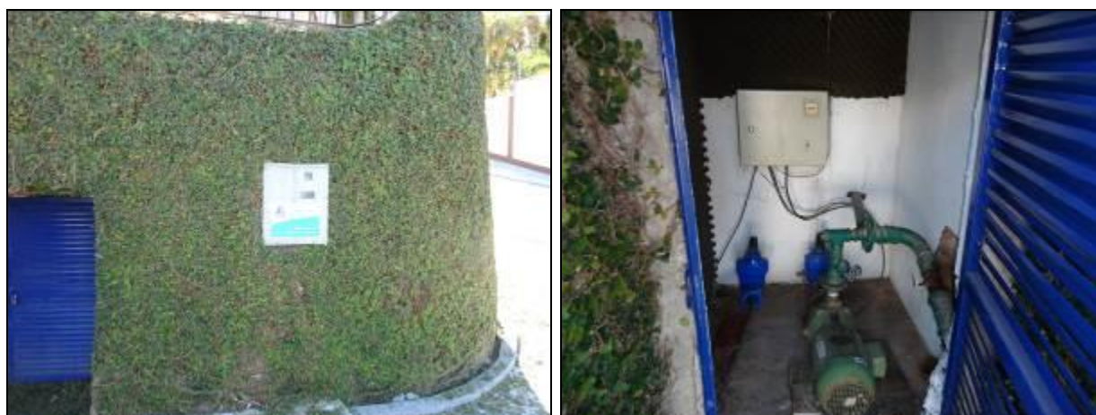
Figura 400- Vista externa e interna do Booster
