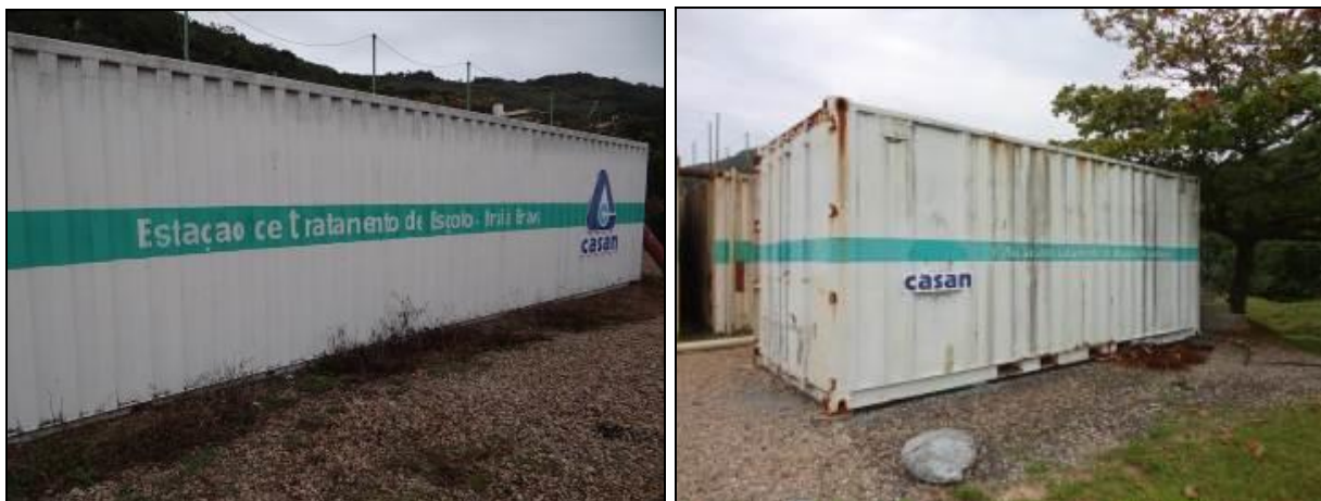
Figura 525 - Estação de Tratamento de Esgotos da Praia Brava (Inicial e Acompanhamento)
