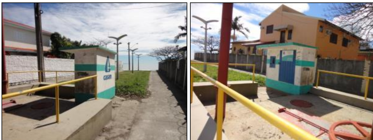
Figura 603- Vista geral da EEE Rua das Flores. É possível verificar a casa de comando e o quadro de energia
