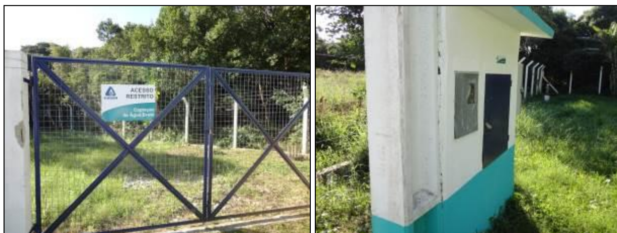
Figura 336- Portão de acesso ao Poço III (à esquerda) e quadros de comando e energia (à direita)
