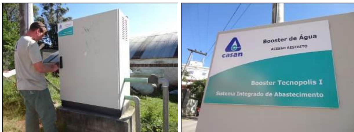
Figura 429- Vista do Booster com placa de identificação
