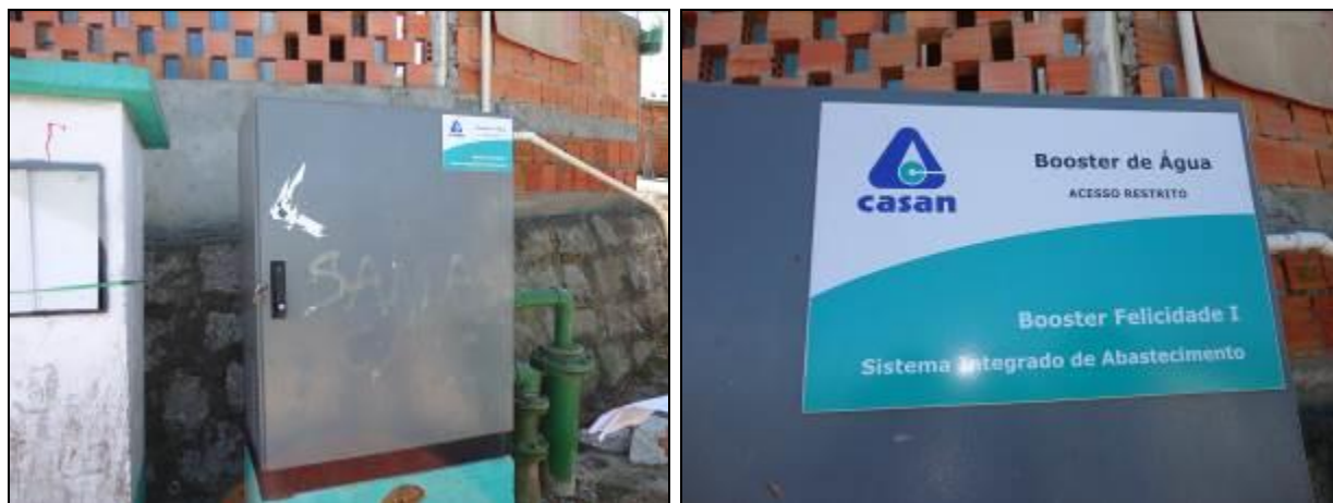
Figura 390- Vista geral do Booster e placa de identificação
