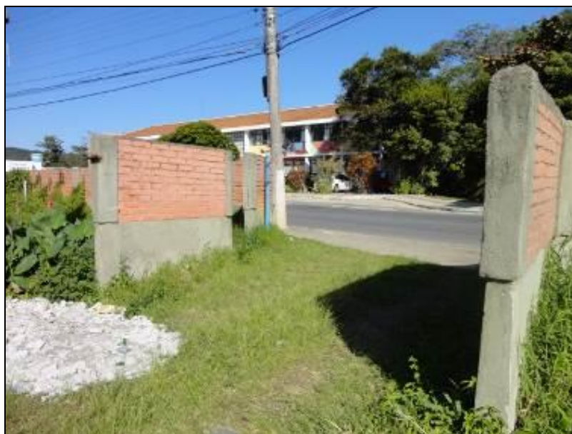
Figura 172 – Sem portão de acesso à ETA (Acompanhamento)
