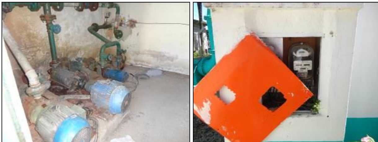
Figura 382- Bombas (à esquerda) e quadro de energia (à direita)
