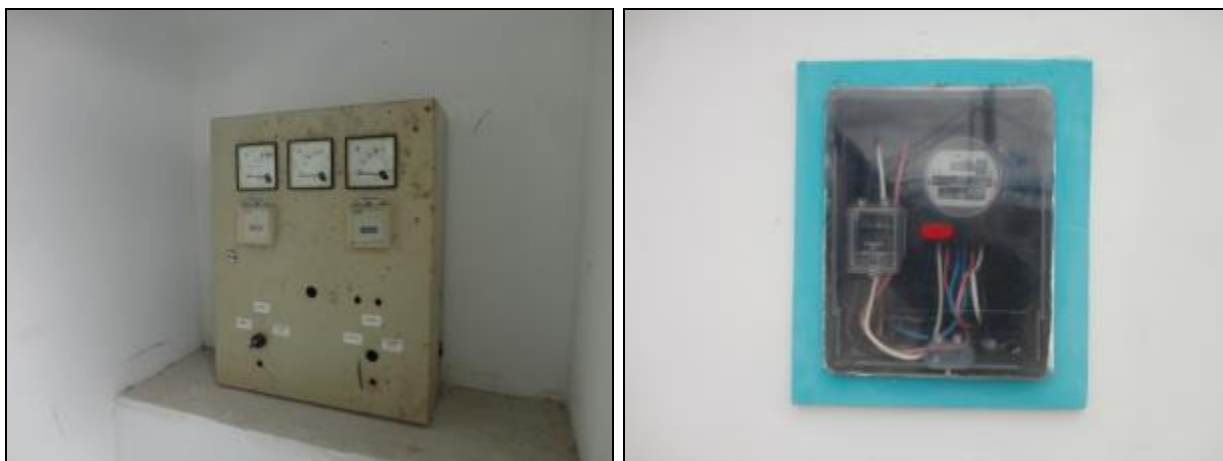
Figura 690- Quadro de comando (à esquerda) e quadro de energia (à direita)
