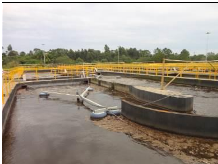
Figura 508 – Lodos Ativados (Valos de Oxidação) (Acompanhamento)
