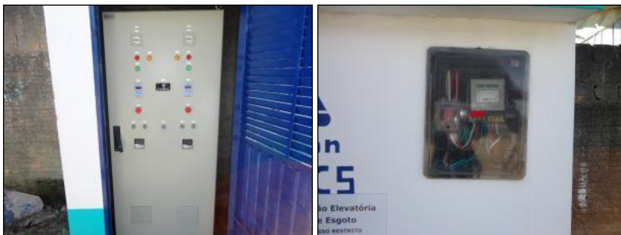
Figura 739- Quadro de comando (à esquerda) e quadro de energia (à direita)
