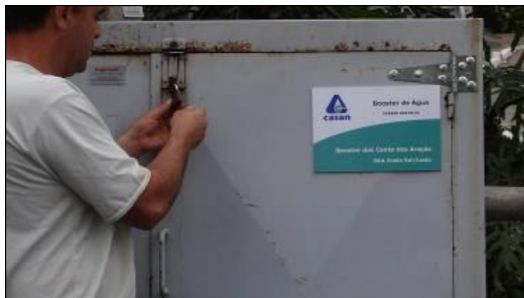
Figura 311- Vista externa do Booster Canto dos Araças
