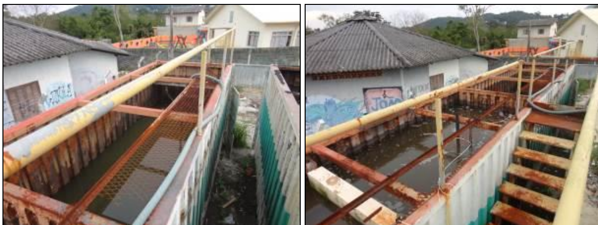
Figura 546 – Visões gerais dos equipamentos/instalações da ETE (Acompanhamento)
