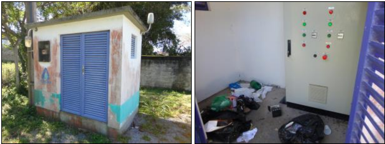
Figura 655- Vista externa e interna da casa de comando. É possível perceber entulho no interior da mesma
