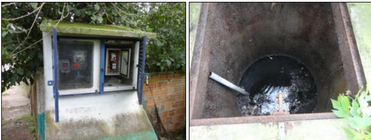
Figura 716- Local onde fica os quadros de comando e energia (à esquerda) e poço úmido sem bomba (à direita)
