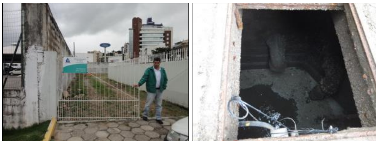
Figura 692- Portão de acesso à EEE I1 Coqueiros com placa de identificação e restrição de acesso (à esquerda) e interior do poço úmido (à direita)
