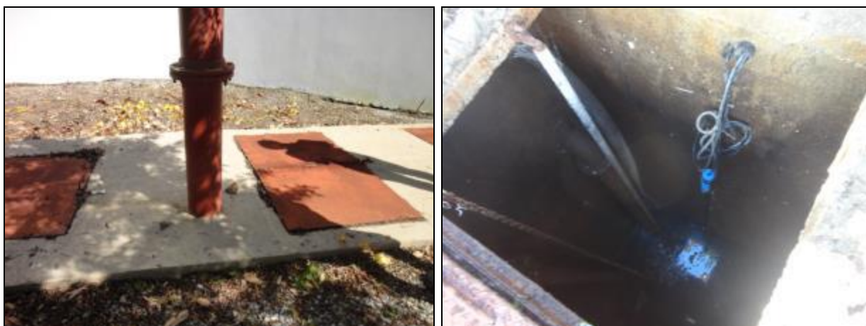
Figura 611- Visão externa e interna do poço úmido
