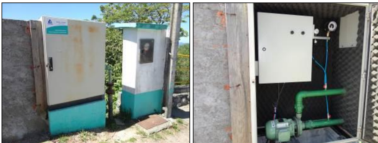
Figura 393- Vista interna e externa do Booster
