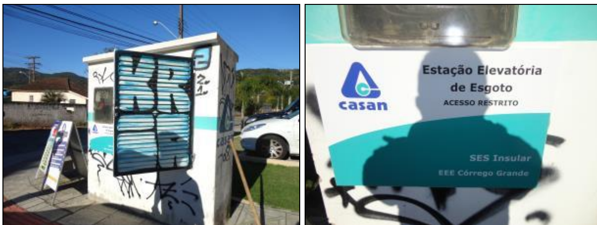
Figura 753- Vista da EEE Córrego Grande com placa de identificação e restrição de acesso. É possível perceber a estrutura pichada
