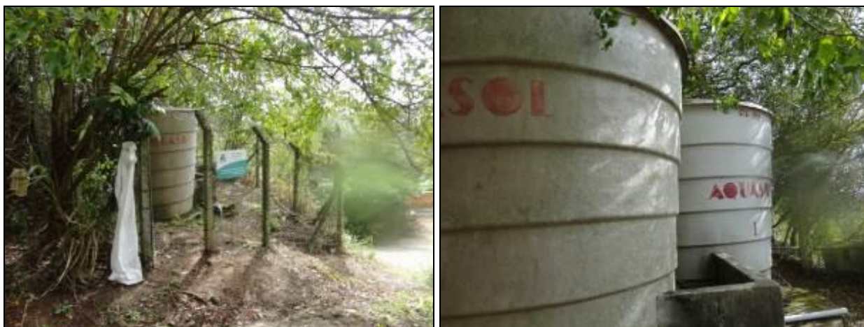
Figura 259 – Aldo Krieger – Córrego Grande – Vista da área dos reservatórios com placa de identificação (Acompanhamento)
