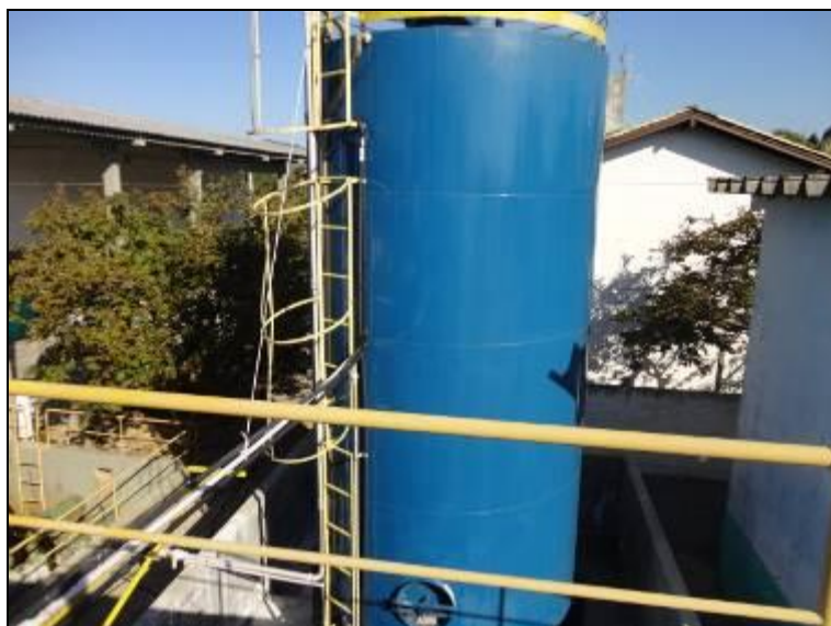
Figura 213 – Áreas de tratamento físico da água (Acompanhamento)
