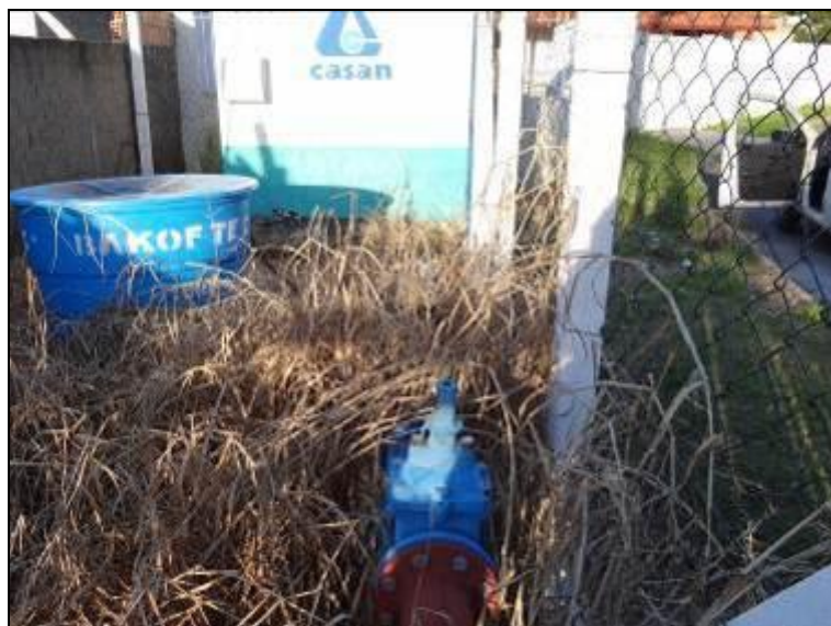
Figura 98 - Poço de captação do Santinho (Inicial)
