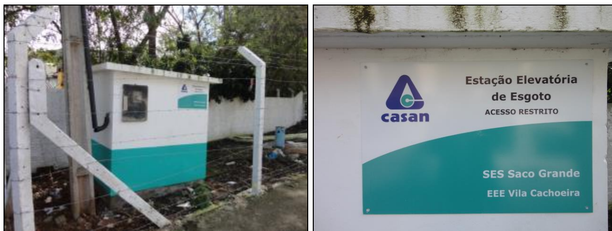
Figura 643- Vista geral da EEE Vila Cachoeira com placa de identificação e restrição de acesso
