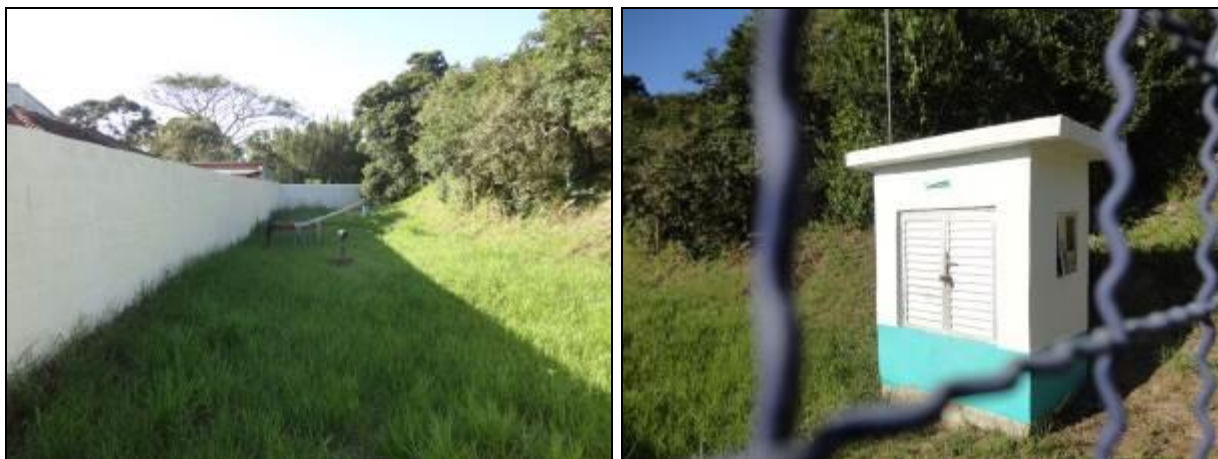
Figura 342- Vista da área do Poço Oficina e quadro s de comando e energia
