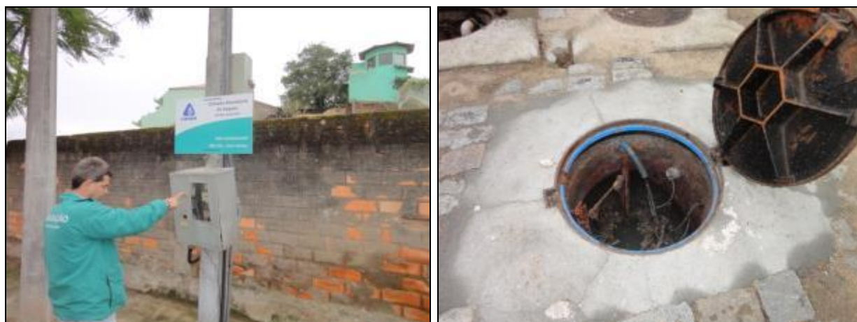
Figura 701- Vista geral da EEE J2A Bom Abrigo II (à esquerda) e interior do poço úmido (à direita)
