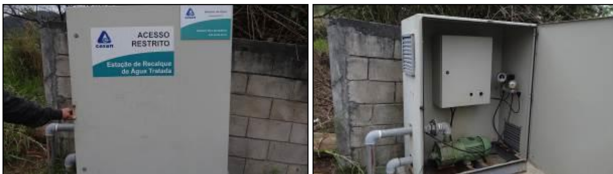
Figura 331- Vista externa e interna do Booster Pico da Neblina
