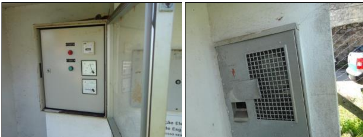
Figura 766- Quadro de comando (à esquerda) e quadro de energia (à direita)
