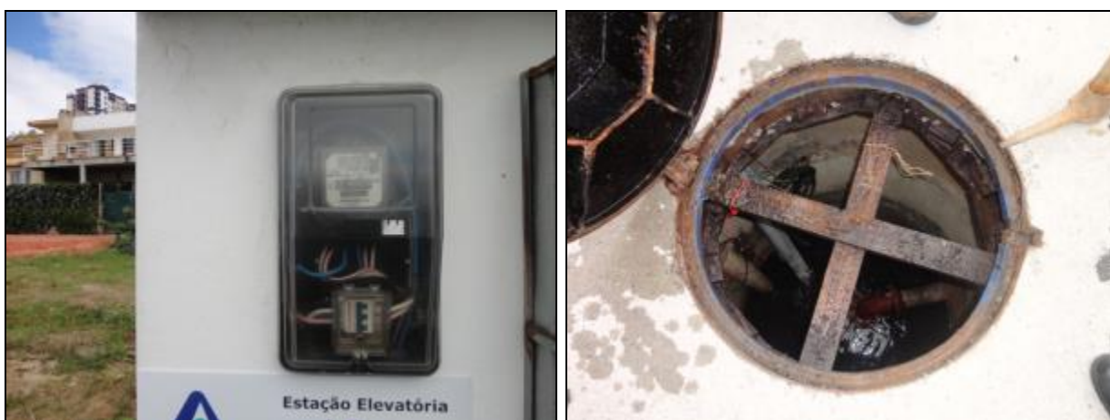
Figura 718- Quadro de energia sem cadeado (à esquerda) e interior do poço úmido (à direita)
