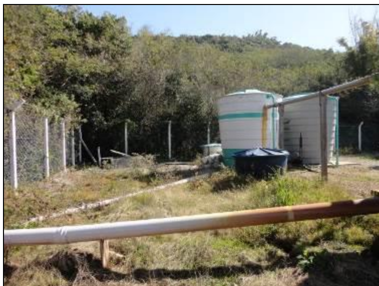
Figura 165 – Alguns trechos de cercamento da ETA (Acompanhamento)
