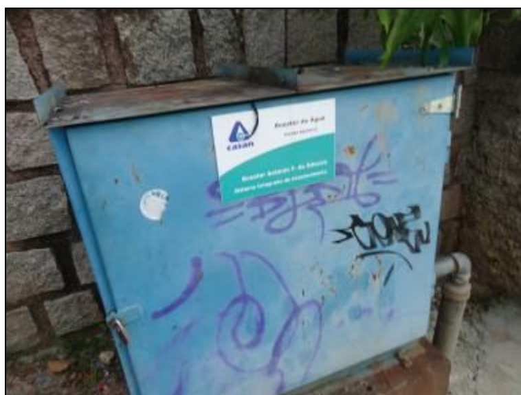
Figura 431- Vista do Booster
