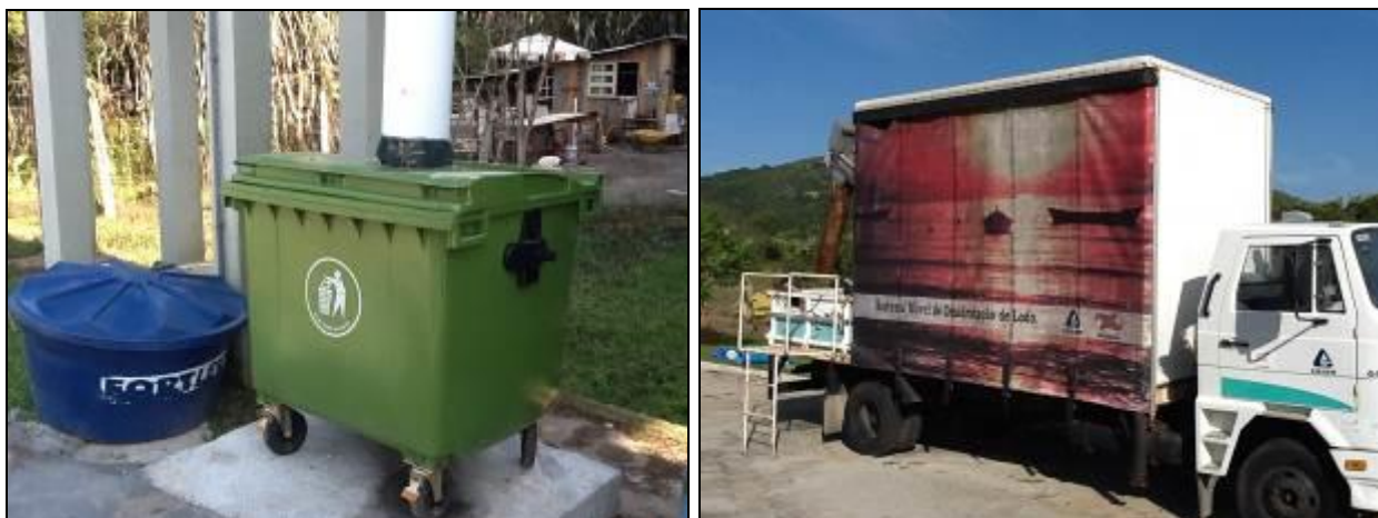
Figura 566 - Caixa receptora de sólidos gradeados e caminhão desidratador de lodo (Inicial)
