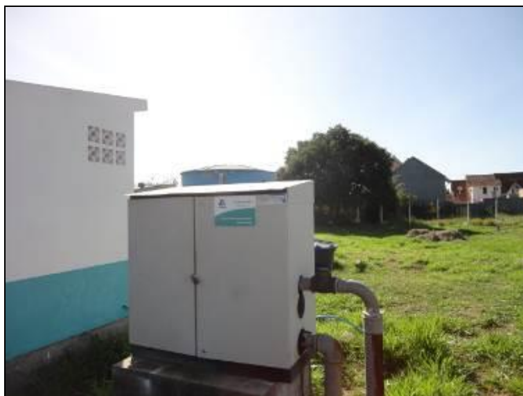
Figura 322- Vista geral do Booster Vargem Grande que está desativado
