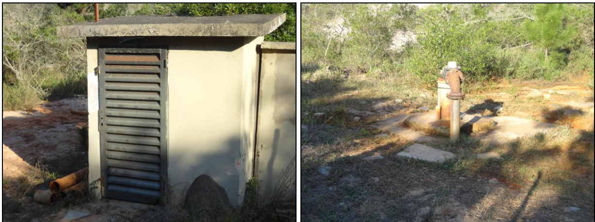
Figura 343- Vista da área do Poço Bianco e quadros de comando e energia
