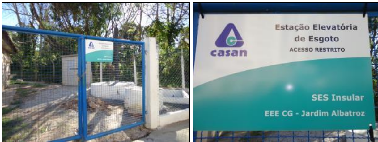
Figura 750- Vista da EEE CG Jardim Albatroz com placa de identificação e restrição de acesso
