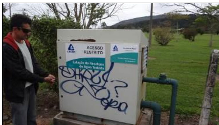
Figura 369- Vista externa do Booster Vargem Pequena com placa de identificação
