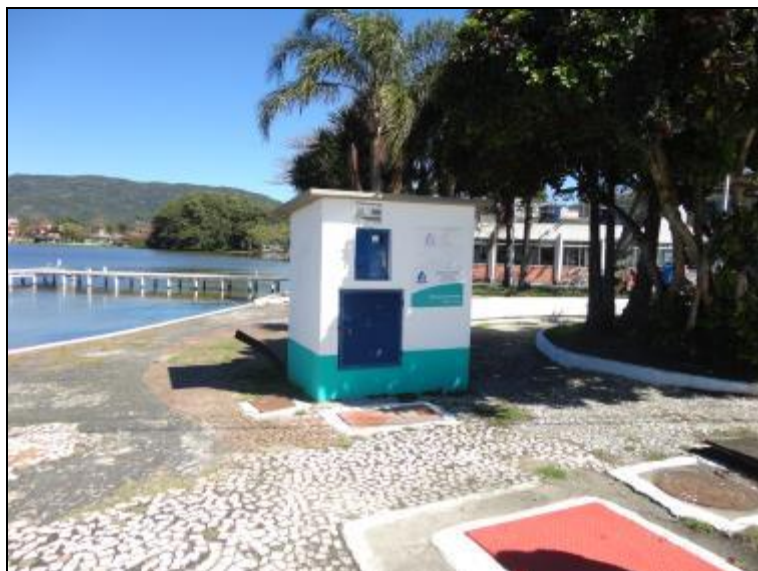
Figura 670- Vista geral da EEE B01 Ponte. É possível perceber os quadros de comando e energia, a placa de identificação e restrição de acesso, bem como o poço úmido localizado na calçada
