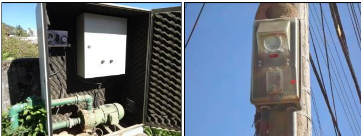
Figura 417- Vista interna com bomba e quadro de comando (à esquerda) e quadro de energia no poste (à direita)
