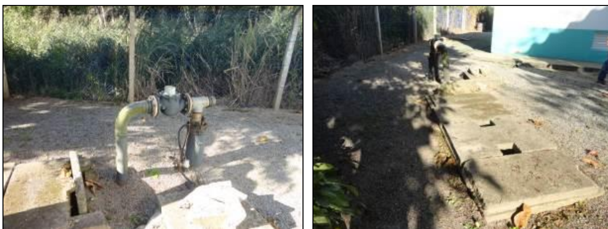
Figura 80 – Poço 1 da ETA (Acompanhamento)
