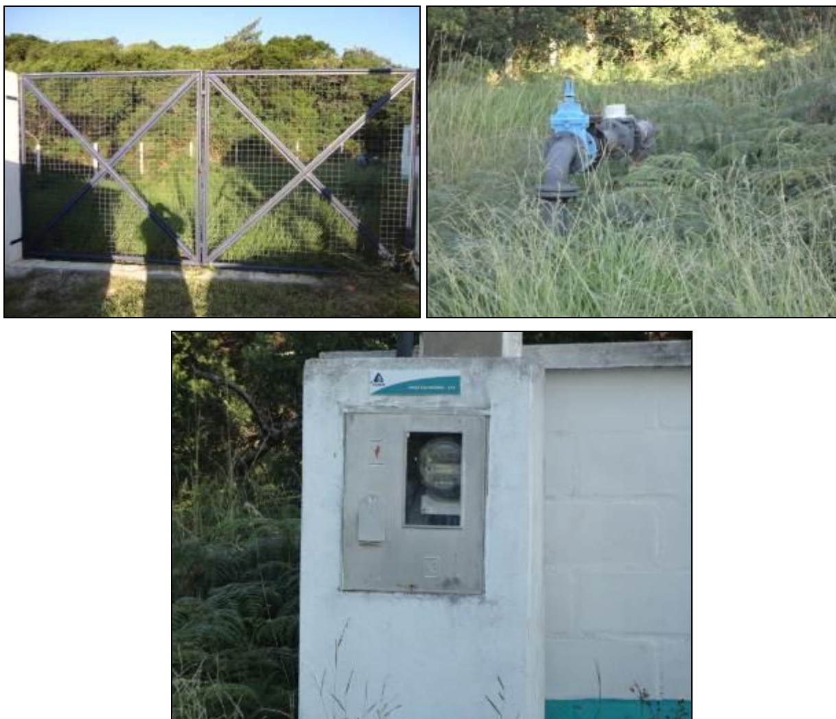
Figura 97 – Poço Palmeiras, sem cadeado no portão (Acompanhamento)
