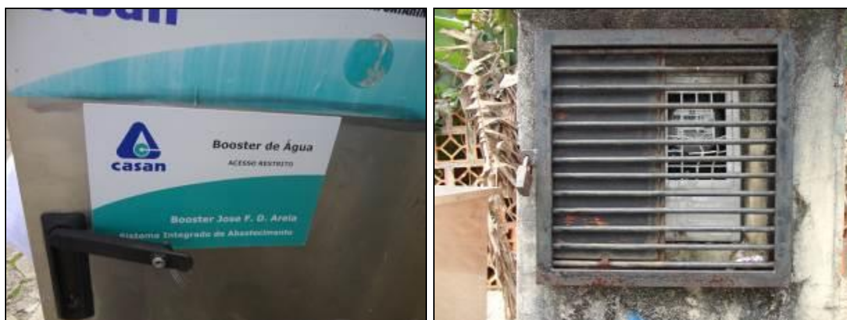
Figura 449- placa de identificação (à esquerda) e quadro de energia (à direita)
