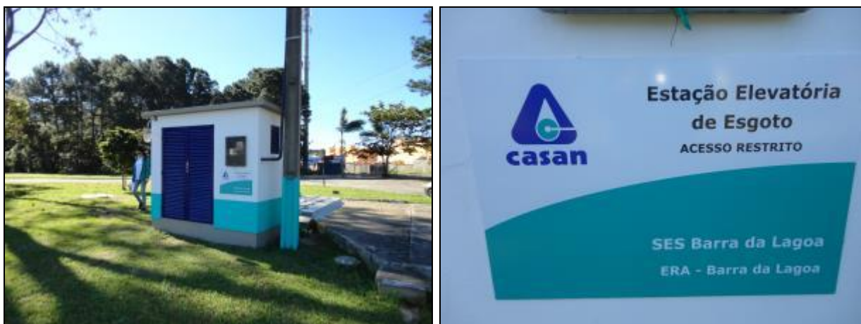
Figura 649- Vista geral da EEE ERA Barra da Lagoa com placas de identificação e restrição
