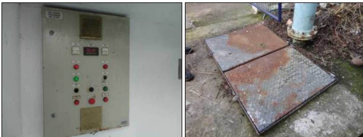
Figura 644- Quadro de comando (à esquerda) e vista externa do poço úmido que estava parafusado
