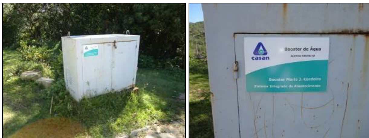
Figura 404- Vista do Booster com placa de identificação
