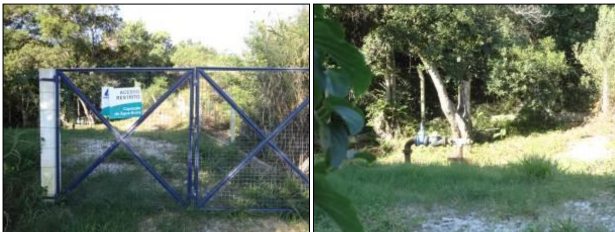
Figura 81 – Poço 2 da ETA (Acompanhamento)
