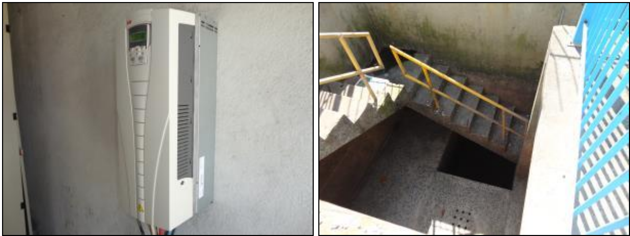
Figura 723- Novo inversor de frequência (à esquerda) e sistema de grades para reter sólidos grosseiros (à direita)
