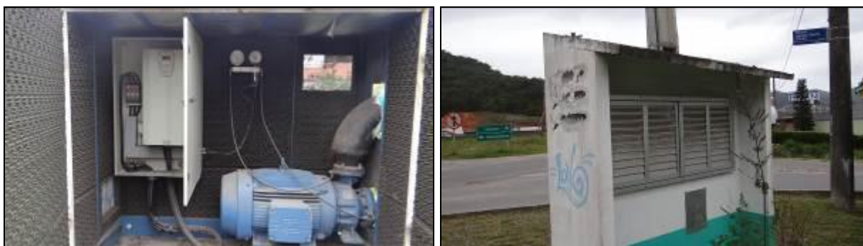
Figura 376- Vista interna com a bomba e o quadro de comando (à esquerda) e quadro de energia (à direita)
