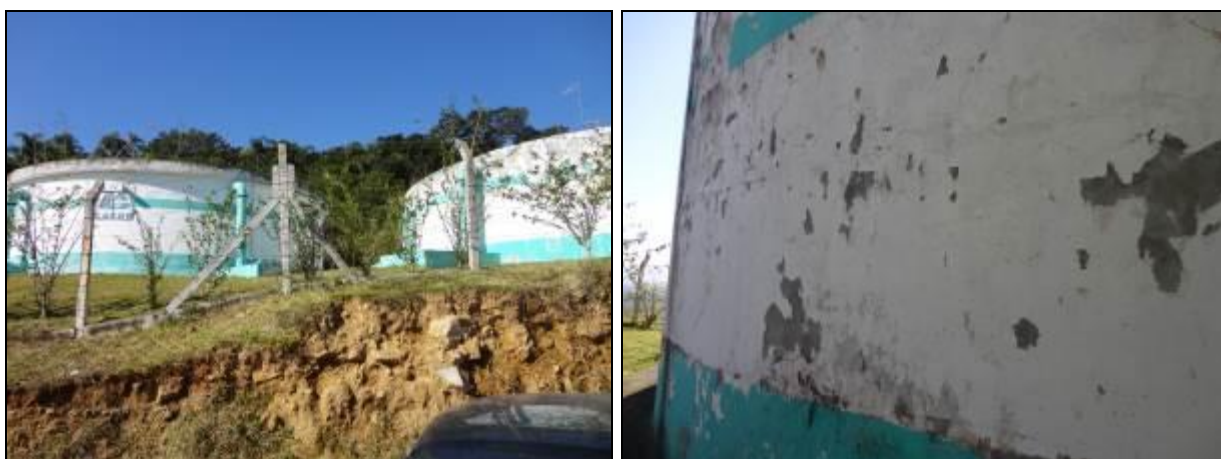
Figura 276 – Reservatório Ingleses – pintura danificada (Acompanhamento)
