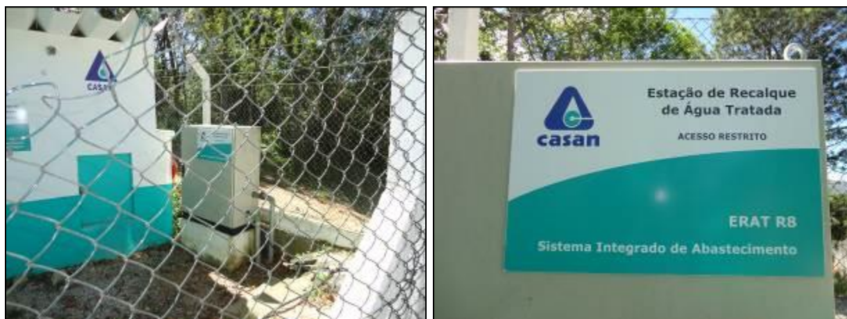
Figura 380- Vista geral do Booster R8 com placa de identificação
