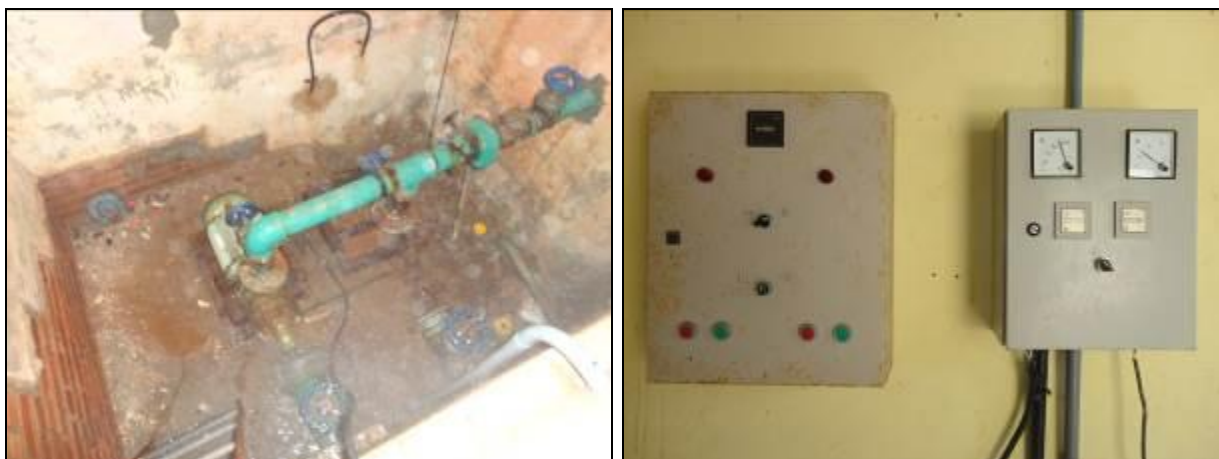
Figura 395- Bomba (à esquerda) e quadro de comando (à direita)
