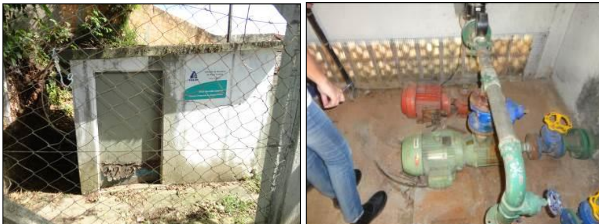
Figura 436- Vista da área do Booster (à esquerda) e bomba (à direita)
