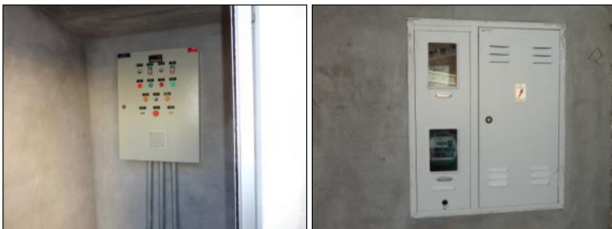
Figura 751- Quadro de comando (à esquerda) e quadro de energia (à direita)
