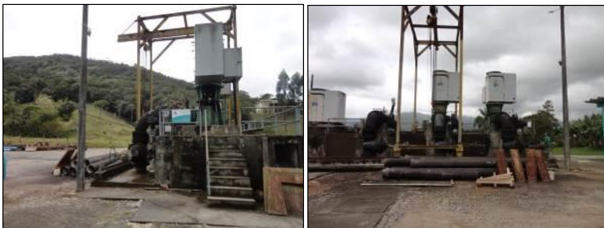
Figura 19 – Estação de Recalque de Água Bruta (Acompanhamento)
