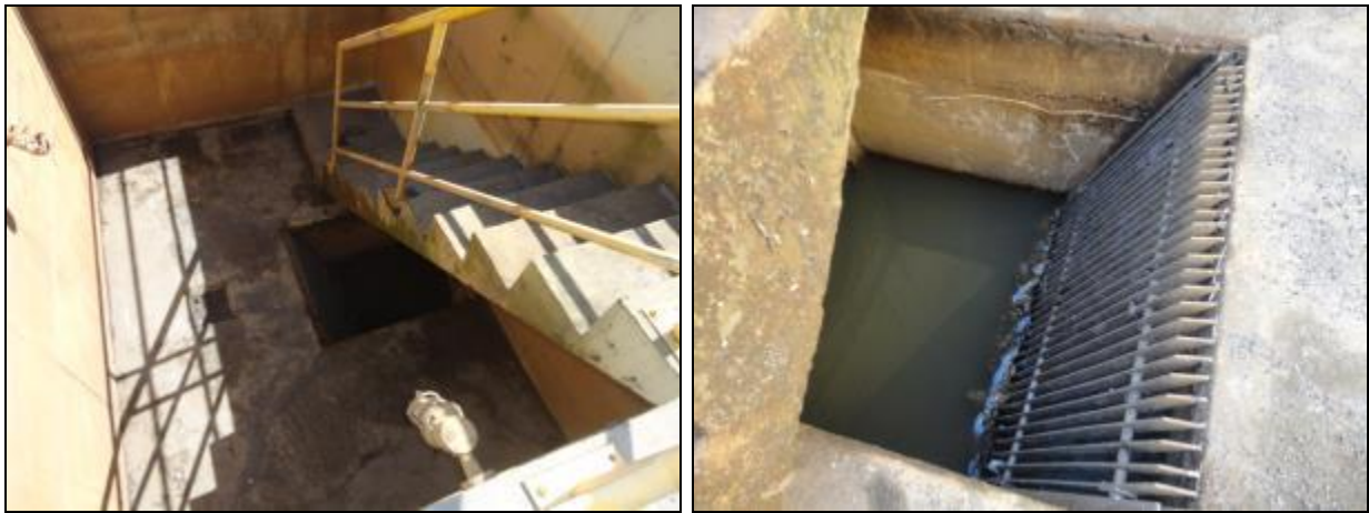
Figura 599- Sistema de grades que retêm os sólidos grosseiros
