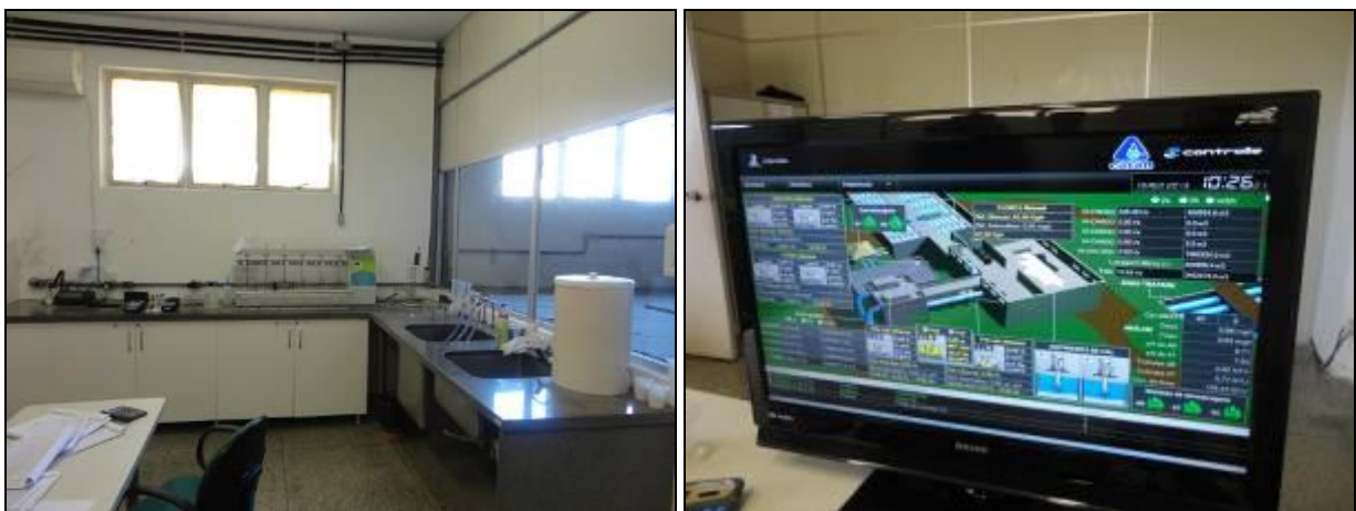
Figura 154 – Laboratório e painel de controle da ETA (Acompanhamento)
