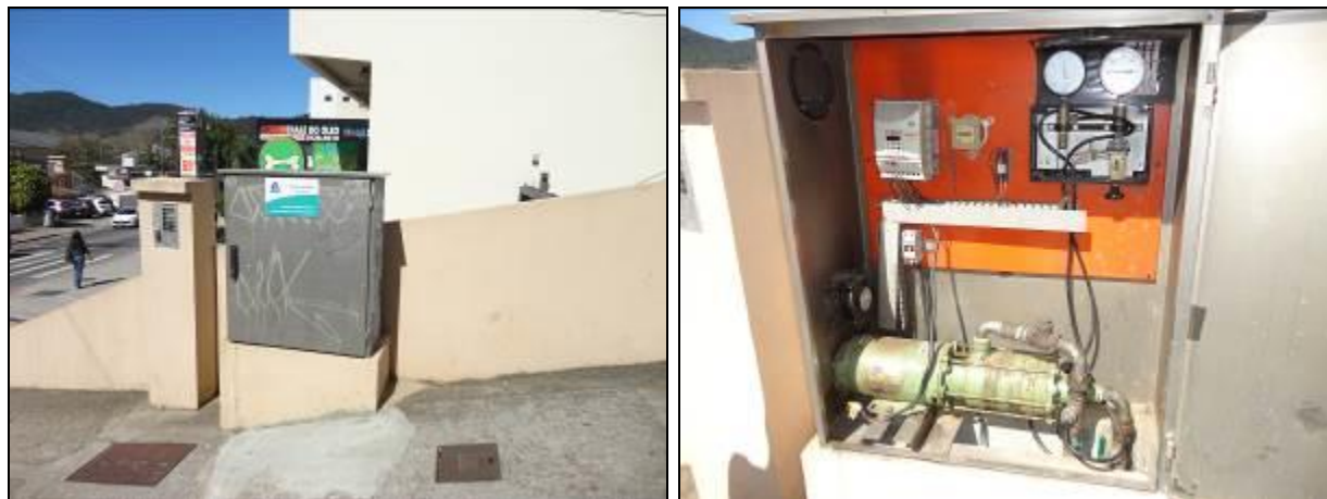
Figura 403- Vista externa e interna do Booster
