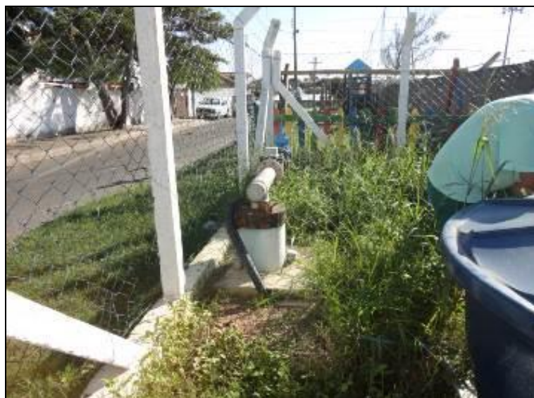
Figura 99 - Poço de captação do Santinho (Acompanhamento)
