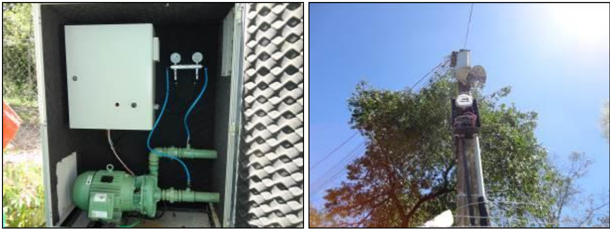
Figura 381- Vista interna com bomba e quadro de comando (à esquerda) e quadro de energia no poste (à direita)
