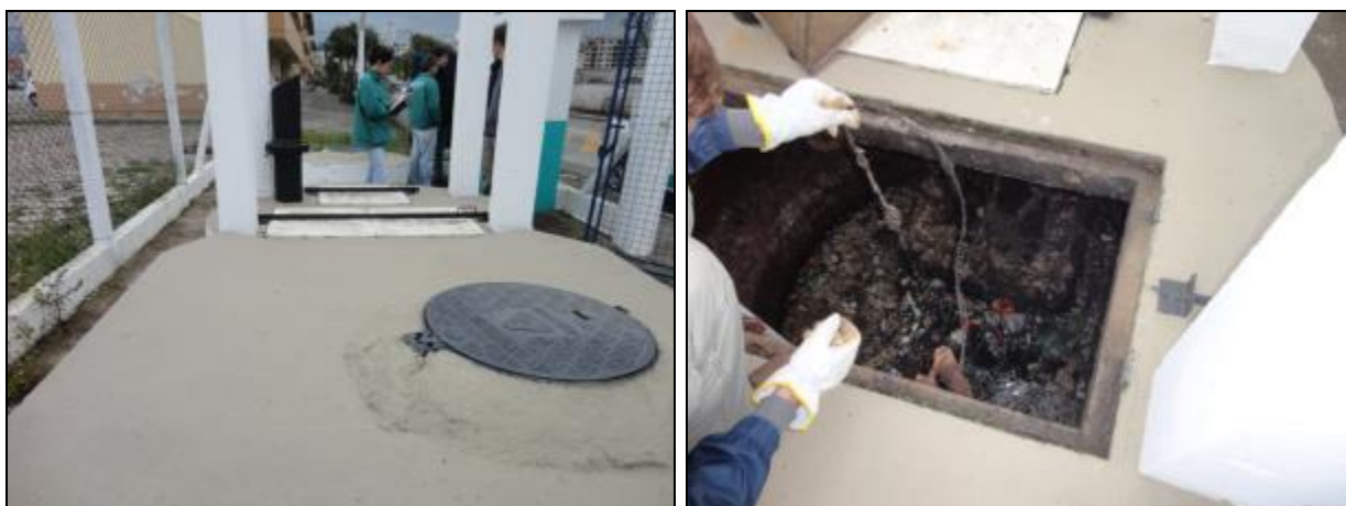
Figura 703- Vista externa e interna do poço úmido. É possível perceber bastante gordura e sujeira no interior
