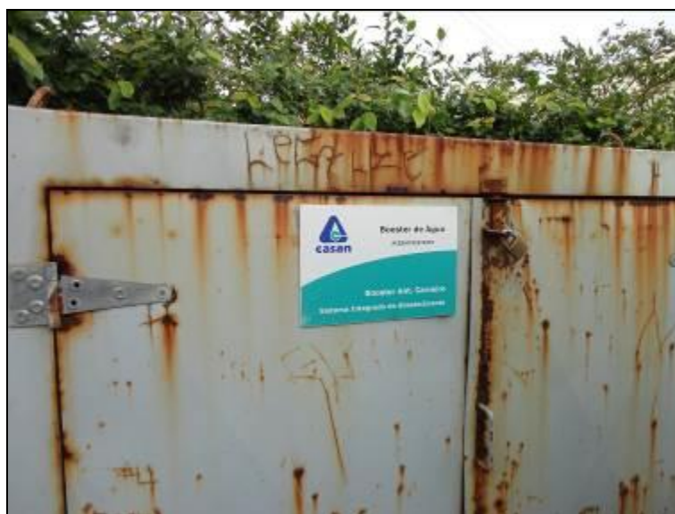
Figura 438- Estrutura enferrujada e placa de identificação
