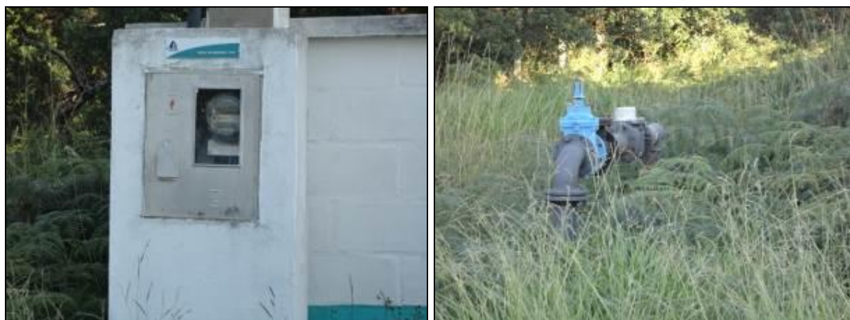
Figura 363- Quadro de energia (à esquerda) e Poço Palmeiras (à direita)
