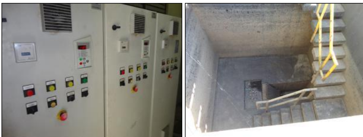
Figura 728- Quadro de comando (à esquerda) e sistema de grades para reter sólidos grosseiros (à direita)
