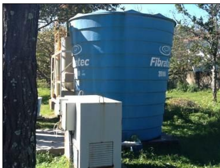
Figura 173 - Pátio da ETA (Inicial)
