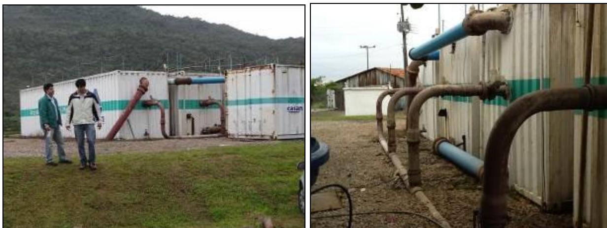
Figura 531 - Visão geral com as tubulações de chegada em evidência (à direita) (Inicial)
