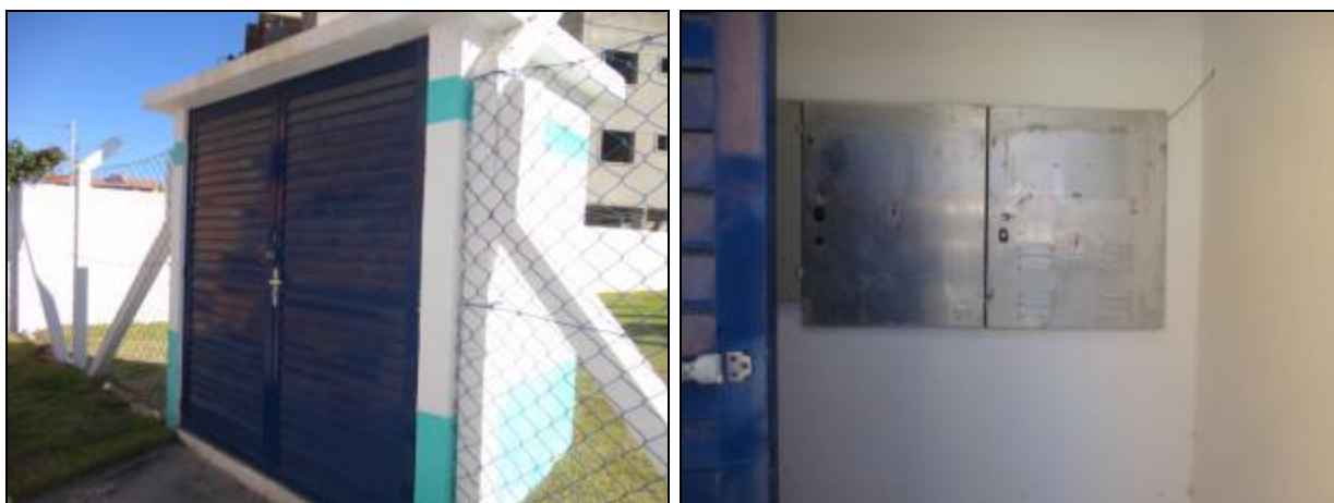
Figura 633- Vista externa e interna do quadro de energia
