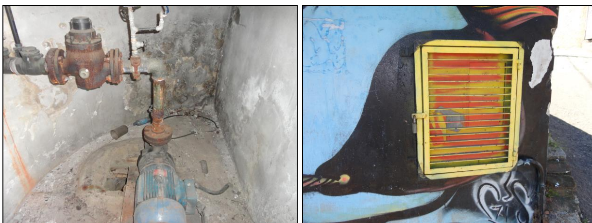
Figura 384- Vista da bomba (à esquerda) e quadro de energia (à direita)
