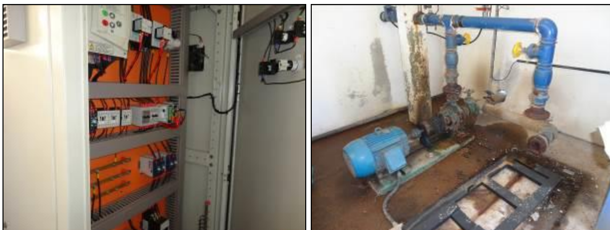
Figura 415- Quadro de comando (à esquerda) e bomba (à direita)
