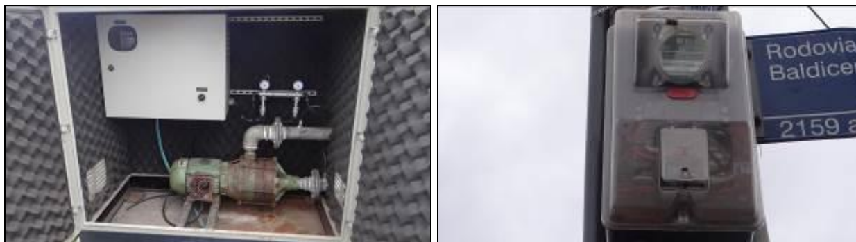
Figura 313- Vista da bomba e quadro de comando (à esquerda) e quadro de energia no poste (à direita)
