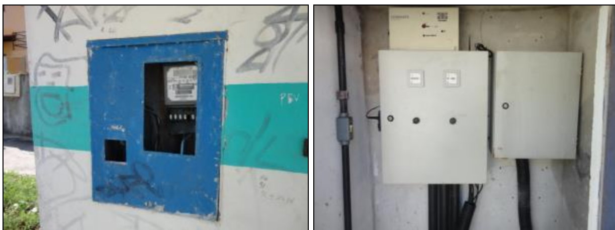
Figura 605- Quadro de energia danificado e sem proteção (à esquerda) e vista interna do quadro de comando (à direita)
