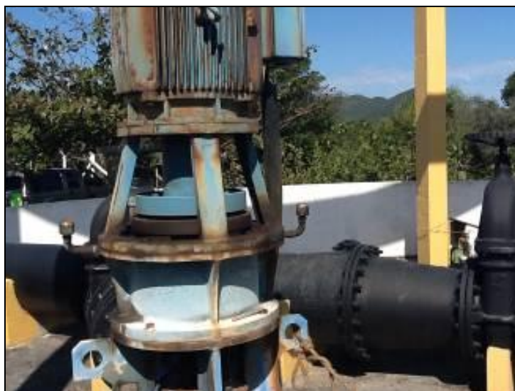
Figura 75 - Casa das máquinas onde é feito o recalque para a ETA (Inicial)
