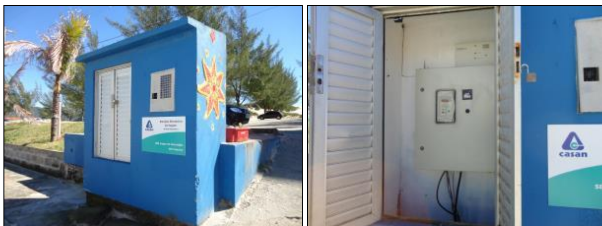
Figura 661- Vista externa e interna da casa de comando e do quadro de energia, bem como a placa de identificação e restrição de acesso
