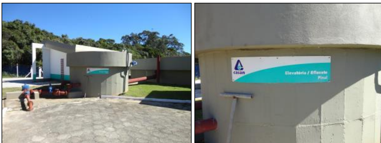
Figura 665- Vista geral da EEE ETE Lagoa da Conceição com placa de identificação
