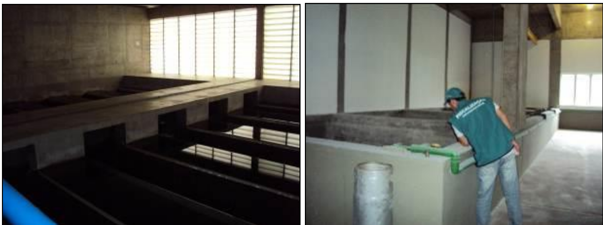
Figura 155 - As áreas de tratamento físico da água (Inicial)
