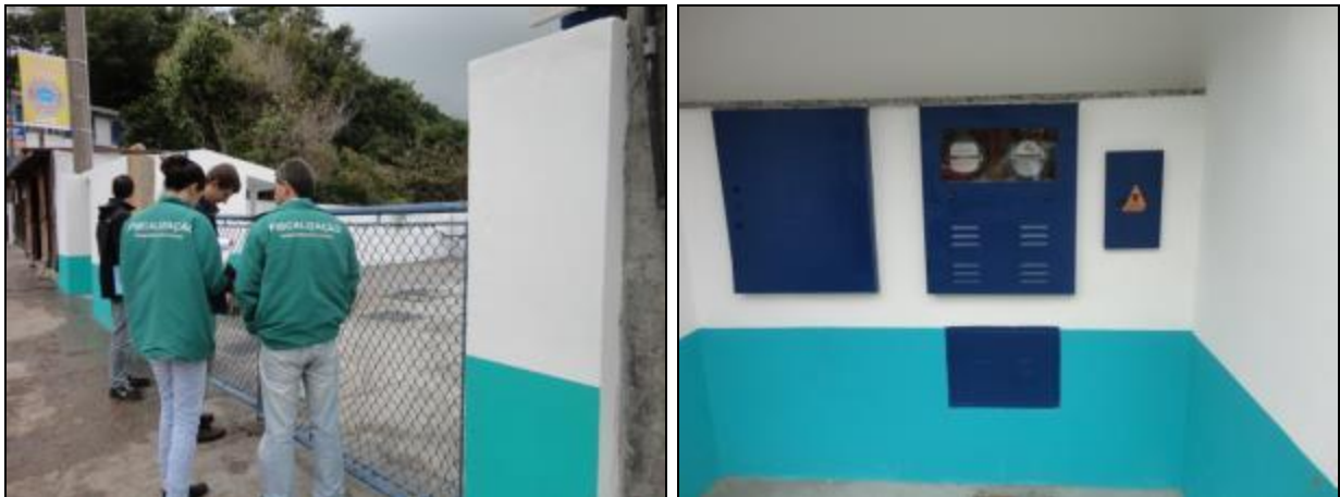
Figura 695- Portão de acesso à EEE J4 Praia do Meio, sem nenhuma identificação (à esquerda) e quadro de energia (à direita)
