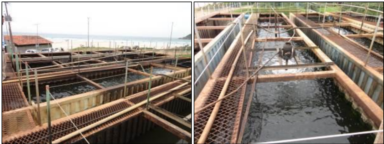
Figura 536 – Equipamento de tratamento físico do esgoto (Acompanhamento)
