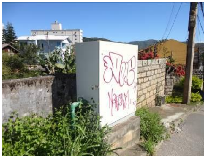
Figura 416- Vista geral do Booster
