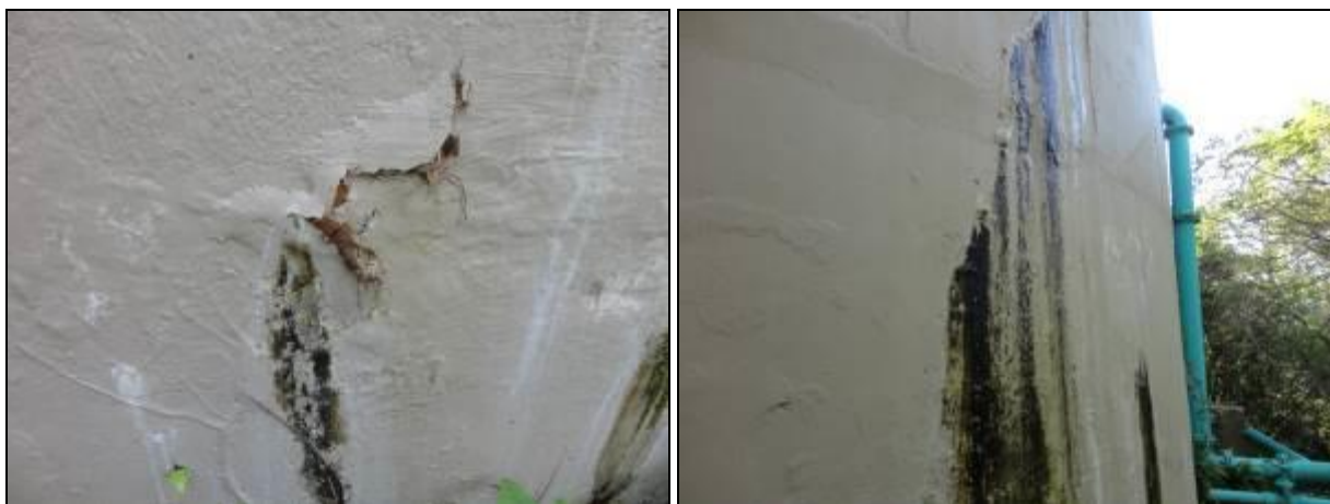
Figura 289 – Vazamentos no Reservatório Praia Brava (Acompanhamento)
