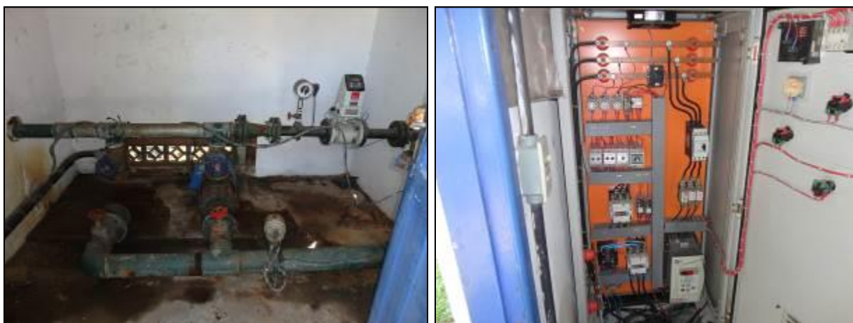
Figura 387- Bomba (à esquerda) e quadro de energia (à direita)
