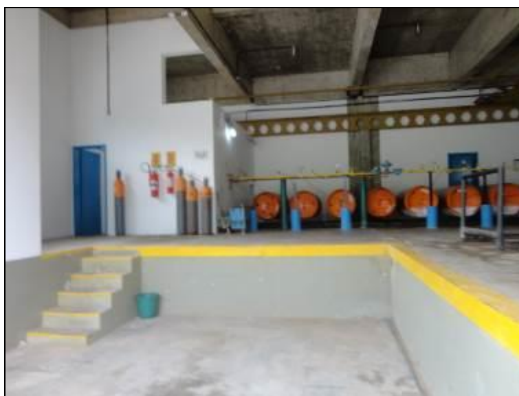
Figura 158 – Armazenamento do cloro em gás (Acompanhamento)
