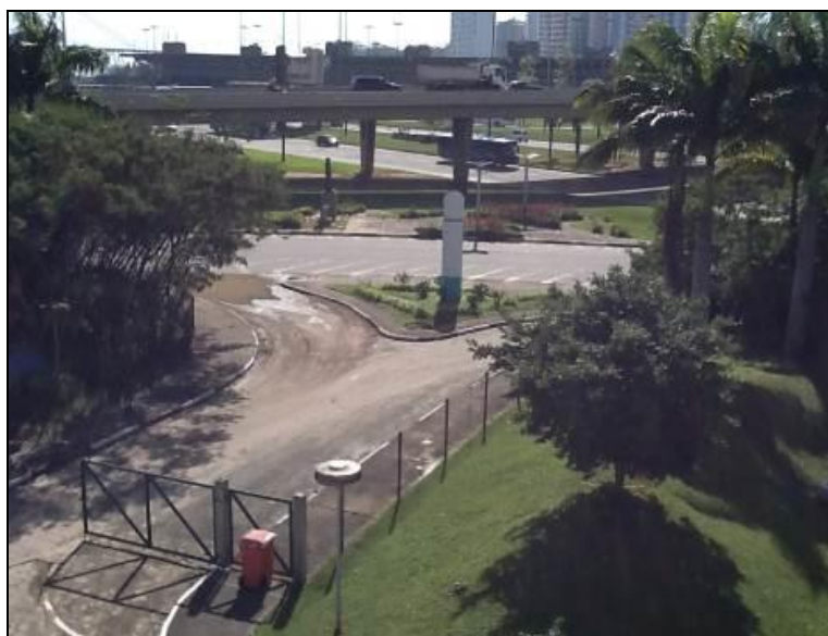
Figura 457 - Acesso com muitos buracos (Inicial)
