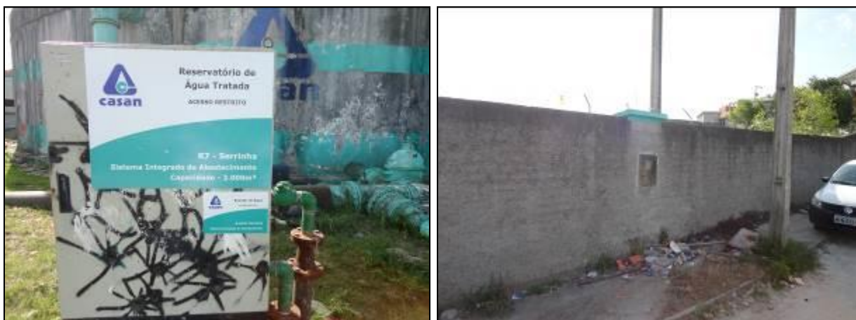
Figura 446- Vista externa com placa de identificação (à esquerda) e quadro de energia (à direita)
