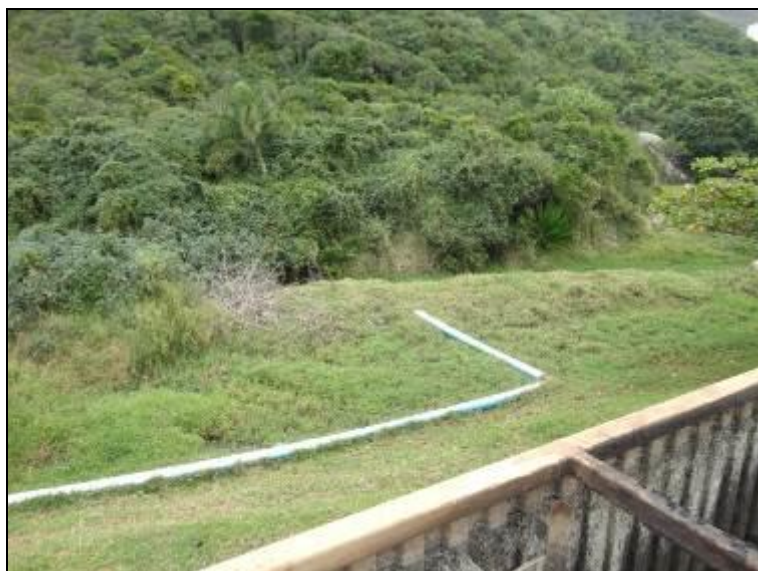
Figura 538 – Tubulação que leva o efluente final ao corpo receptor (Acompanhamento)
