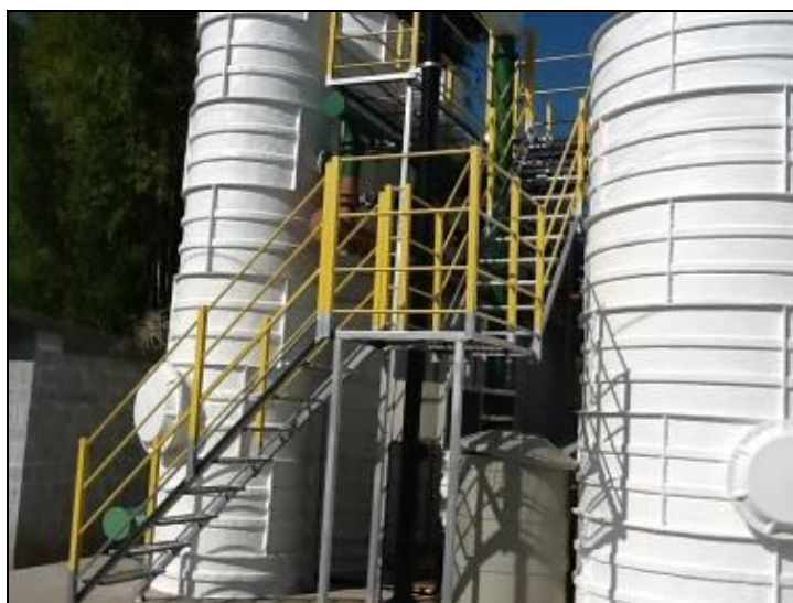
Figura 185 - Fachada e panorâmica geral da ETA Coord. Geográficas: 27°27'4.26"S 48°31'2.62"O (Inicial)
