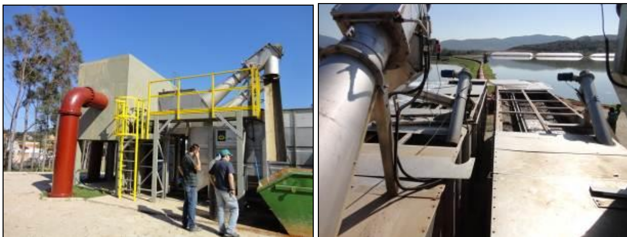
Figura 590 - Equipamento de tratamento inicial do esgoto na entrada da ETE: separação de sólidos (Inicial)
