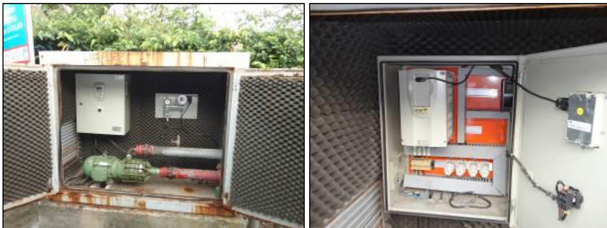
Figura 439- Vista interna com bomba e quadro de comando
