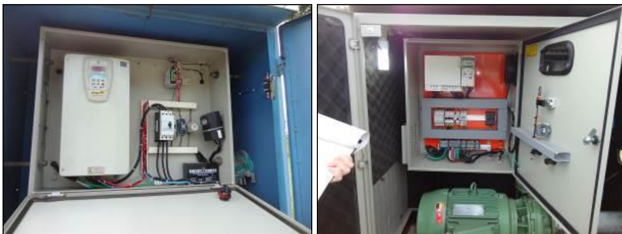
Figura 445- Quadros de comando dos dois Boosters
