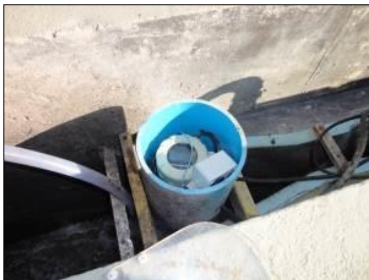
Figura 488 – Medidor de vazão (Acompanhamento)
