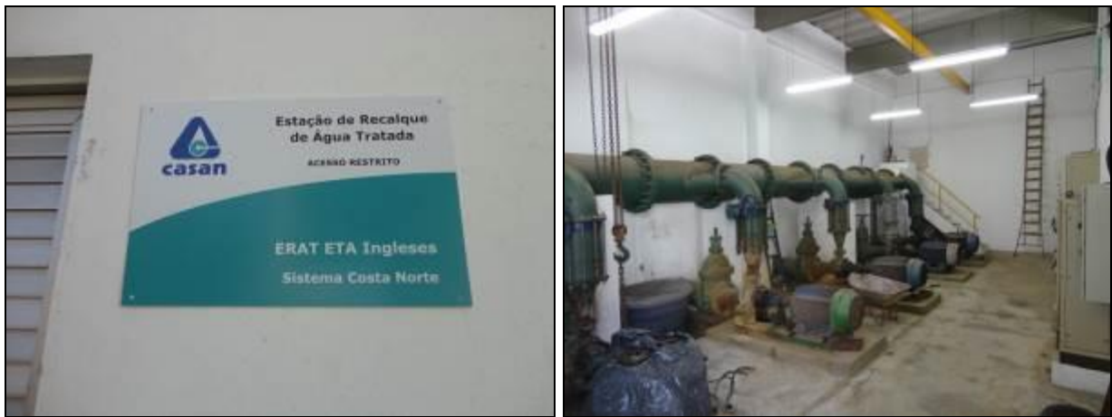
Figura 332- Placa de identificação (à esquerda) e área interna onde ficam as bombas (à direita)
