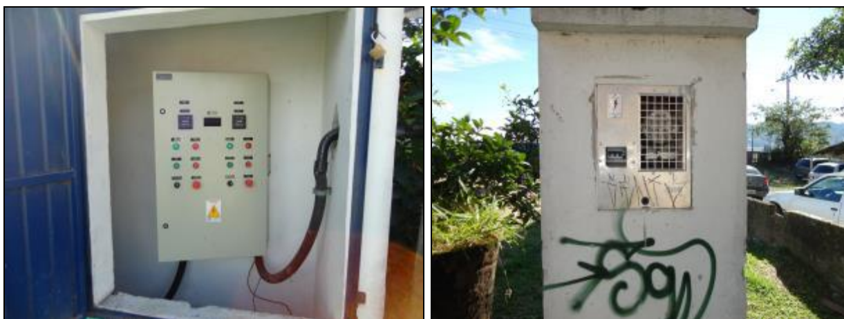
Figura 731- Quadro de comando (à esquerda) e quadro de energia (à direita)
