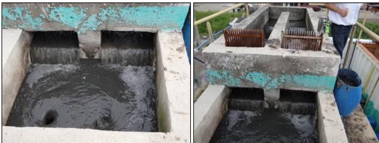
Figura 545 - Visões gerais dos equipamentos/instalações da ETE (Inicial)
