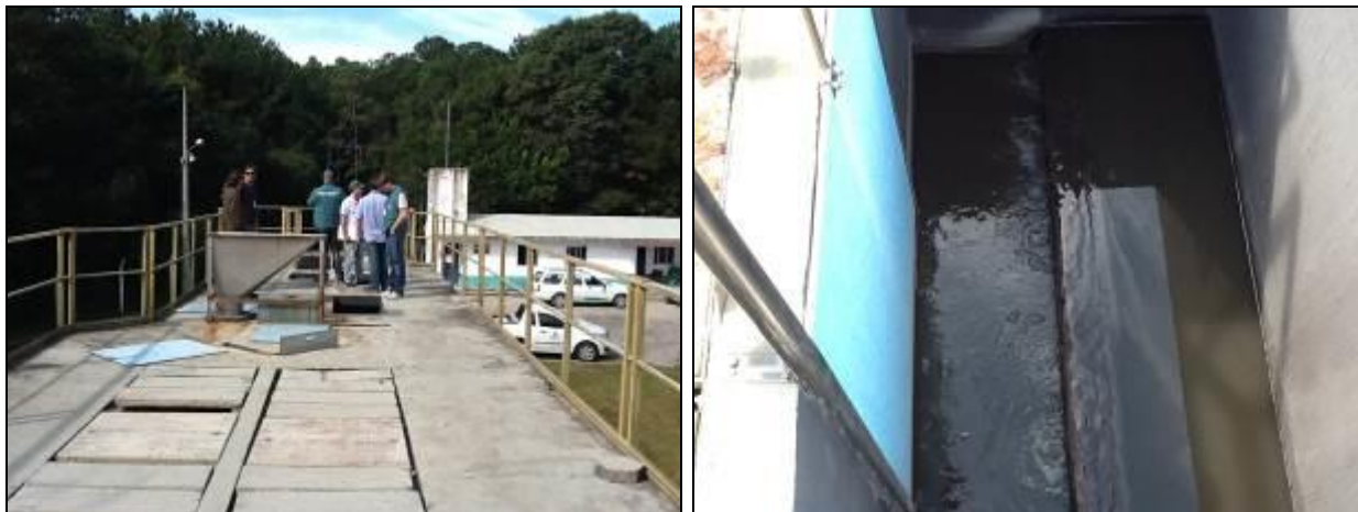
Figura 582 - Áreas de entrada do efluente bruto (Inicial)
