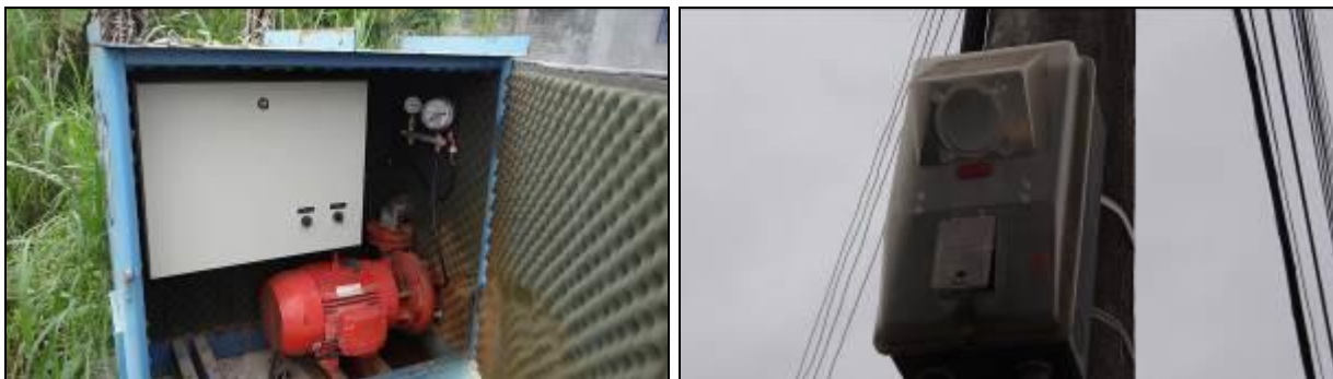
Figura 355- Vista interna com a bomba e quadro de comando (à esquerda) e quadro de energia no poste (à direita)
