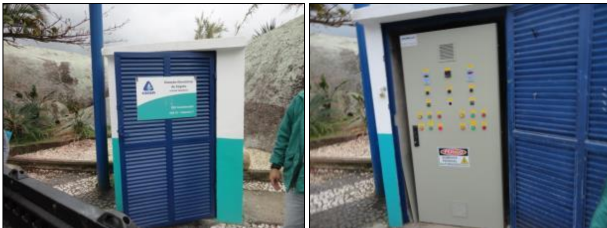
Figura 697- Vista externa e interna do quadro de comando, bem com placa de identificação e restrição de acesso
