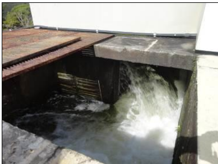
Figura 147 – Entrada da água bruta (Acompanhamento)
