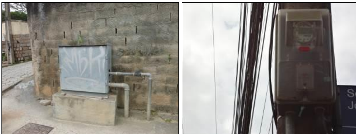
Figura 418- Vista externa do Booster Itacorubi (à esquerda) e quadro de energia no poste (à direita)
