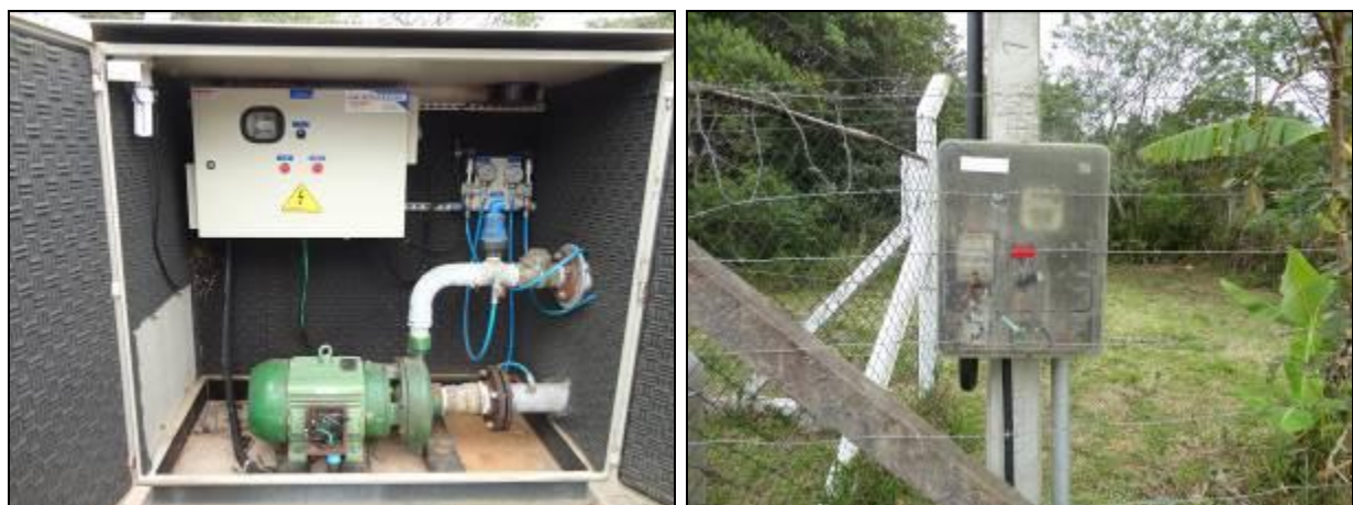
Figura 374- Vista interna com bomba e quadro de comando (à esquerda) e quadro de energia (à direita)
