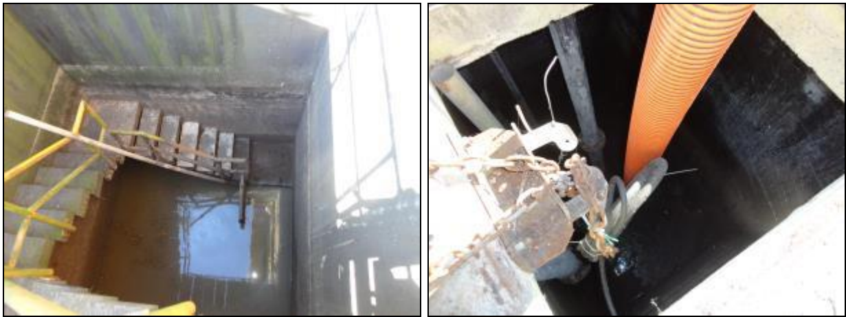
Figura 742- Sistema de grades entupido (à esquerda) e interior do poço úmido (à direita)
