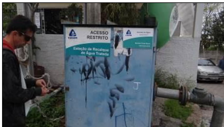
Figura 346- Vista externa do Booster com placa de identificação
