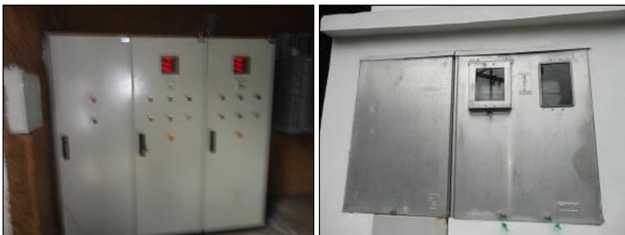
Figura 308- Quadro de comando (à esquerda) e quadro de energia (à direita)
