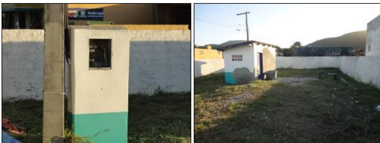
Figura 368- Quadro do relógio sem tampa (à esquerda) e Poço Ciro (à direita)
