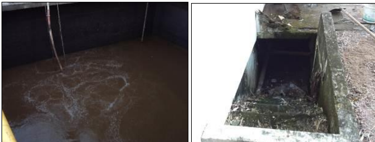
Figura 500- Estruturas necessitando de cuidados (Inicial)
