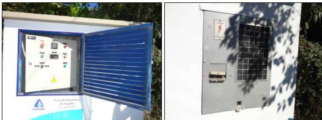
Figura 685- Quadro de comando (à esquerda) e quadro de energia (à direita)
