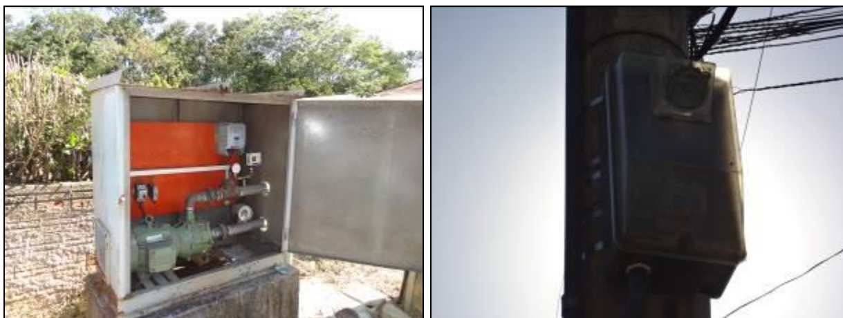
Figura 421- Vista interna do Booster (à esquerda) e quadro de energia no poste (à direita)
