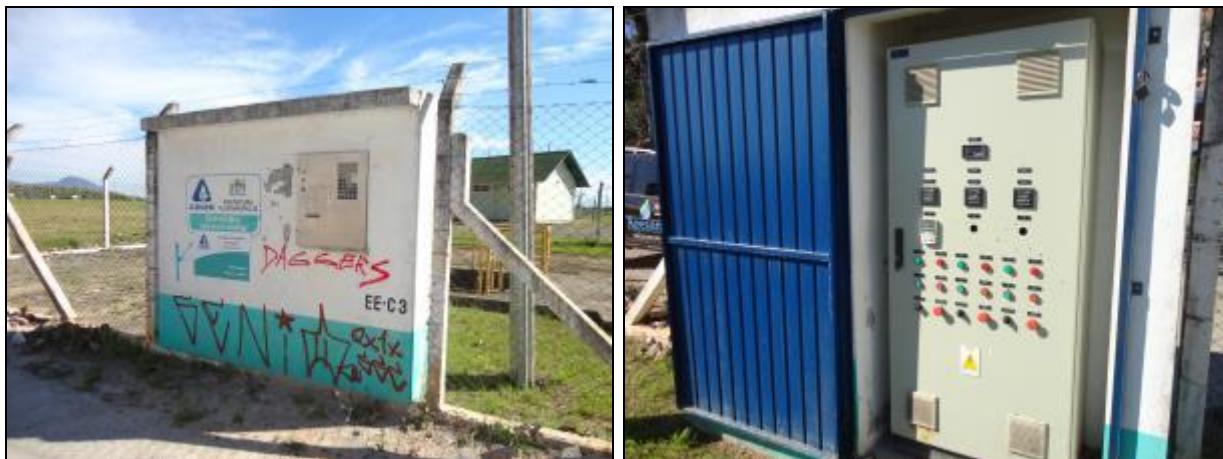
Figura 733- Vista geral da EEE C3 Costeira com placa de identificação e restrição de acesso, é possível perceber o quadro de energia (à esquerda) e o quadro de comando (à direita)
