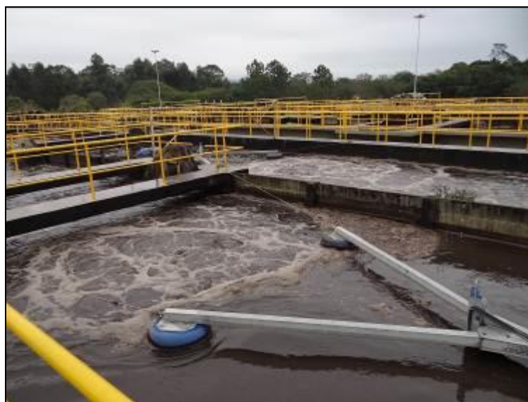
Figura 507 - Lodos Ativados (Valos de Oxidação) (Inicial)
