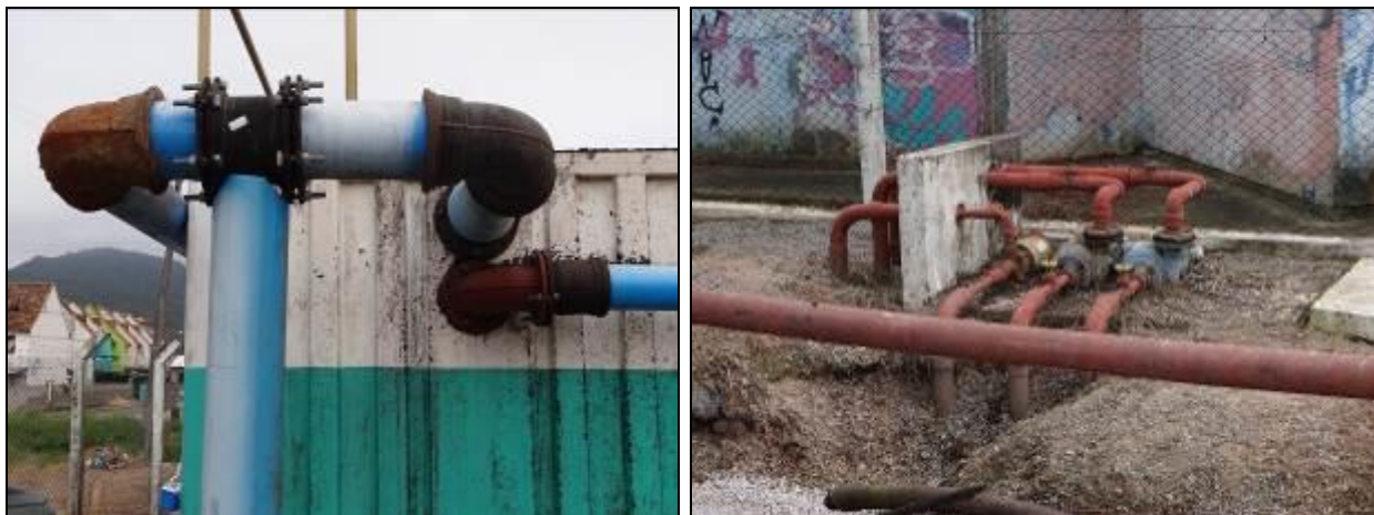
Figura 547 - Aspectos gerais das tubulações da ETE (Inicial)
