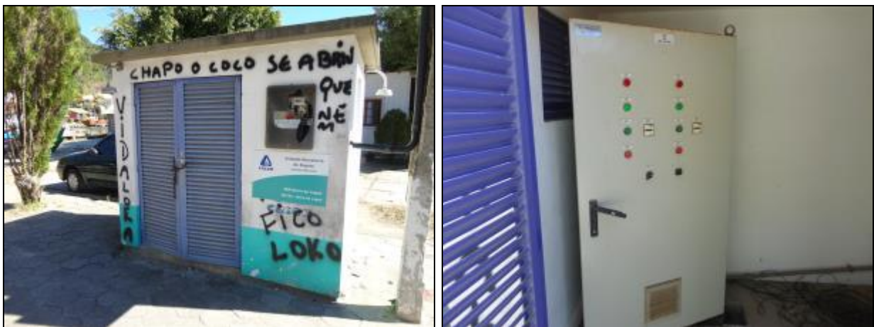
Figura 657- Vista externa e interna da casa de comando com placa de identificação. É possível perceber os danos na estrutura, bem como o quadro de energia quebrado.
