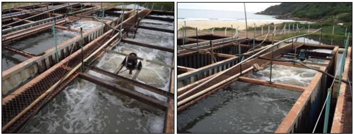
Figura 535 - Equipamentos de tratamento físico do esgoto (Inicial)
