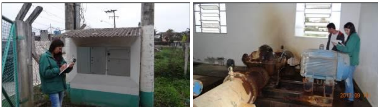
Figura 330- Quadros de energia (à esquerda) e vista interna da estrutura com a bomba (à direita)
