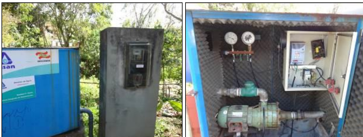
Figura 434- Quadro de energia parafusado (à esquerda) e vista interna com bomba e quadro de comando (à direita)
