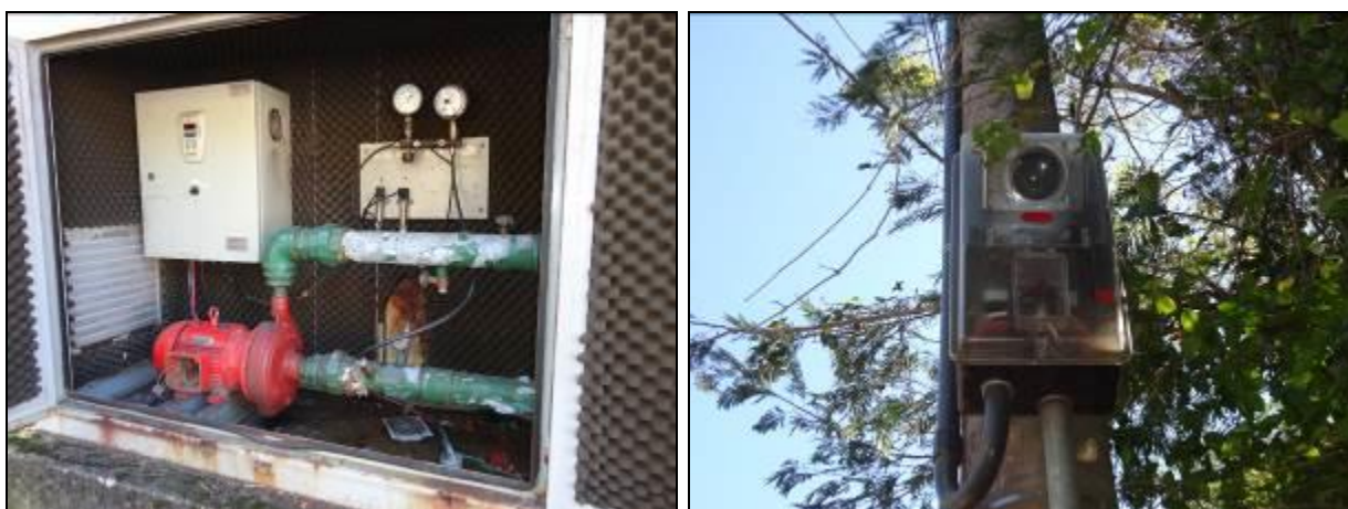
Figura 407- Vista interna com bomba e quadro de comando (à esquerda) e quadro de energia no poste (à direita)
