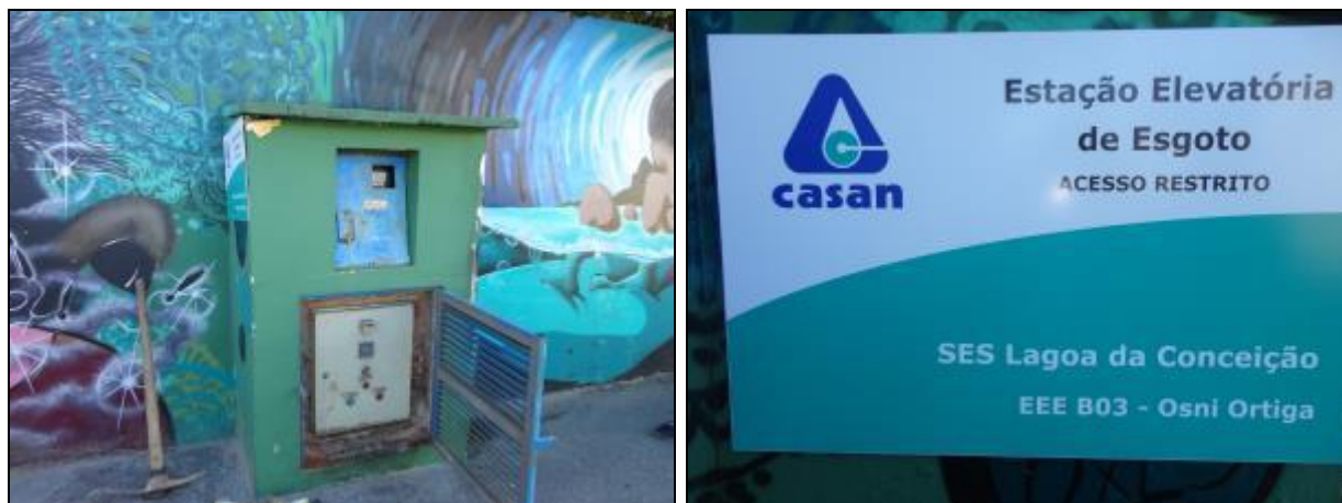
Figura 668- Quadro de comando e quadro de energia (à esquerda) e placa de identificação e restrição de acesso (à direita)
