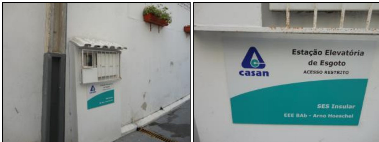
Figura 768- Vista da EEE Bab Arno Hoeschel com placa de identificação e restrição de acesso
