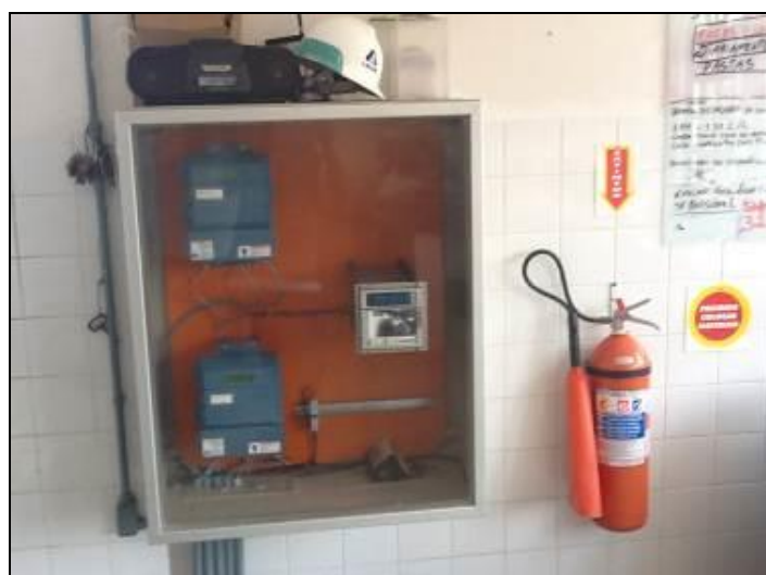
Figura 193 - Outros equipamentos de acompanhamento da ETA (Inicial)
