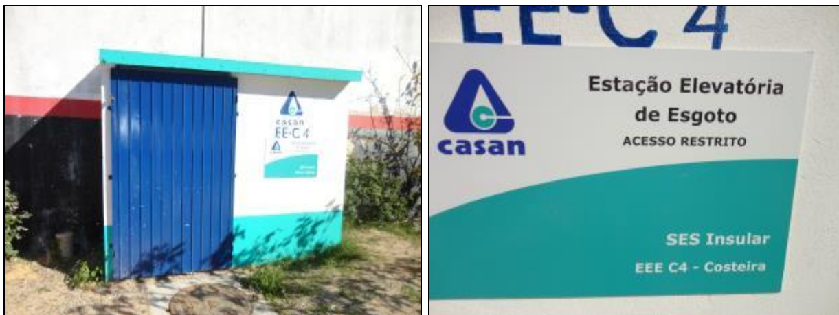
Figura 735- Vista da EEE C4 Costeira com placa de identificação e restrição de acesso
