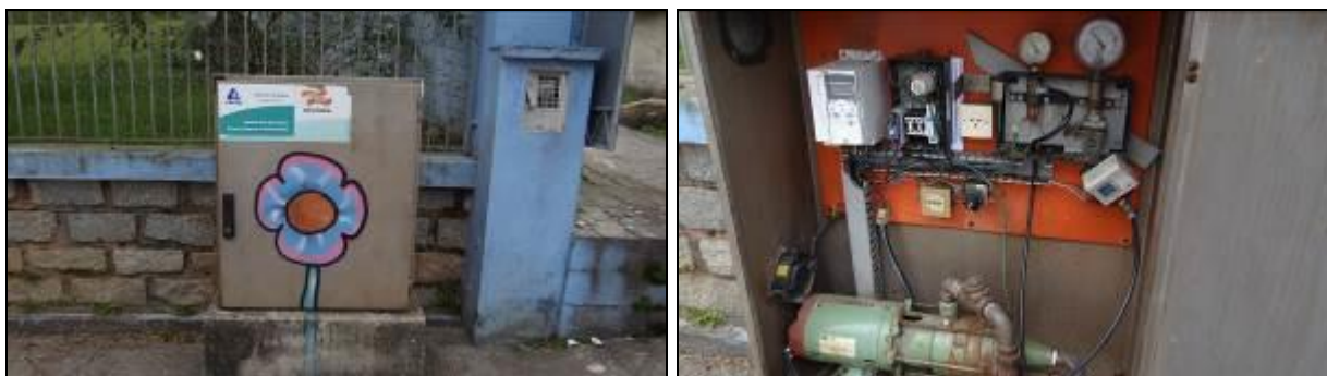
Figura 440- Vista geral da área (à esquerda) e quadro de comando (à direita)
