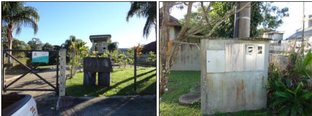
Figura 743- Vista da EEE SB9 Santa Mônica com placa de identificação e restrição de acesso (à esquerda) e quadro de energia (à direita)
