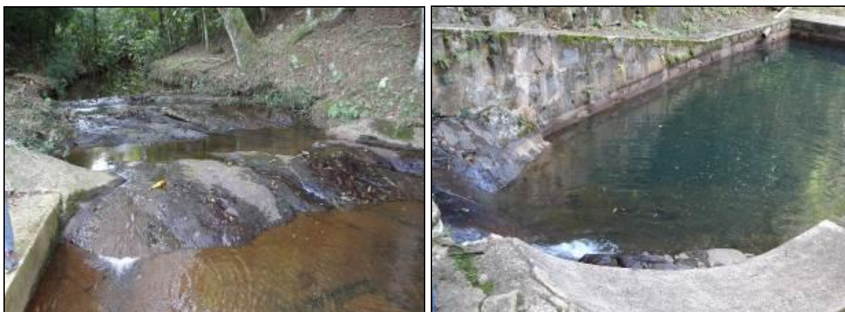
Figura 38 - Área do manancial não está cercada nem identificada (Acompanhamento)
