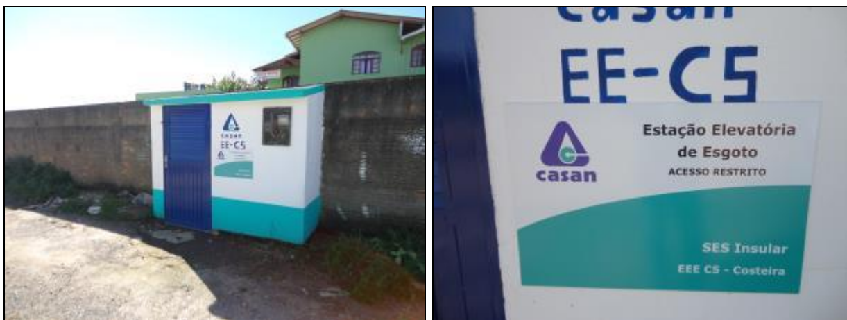
Figura 738- Vista da EEE C5 Costeira com placa identificação e restrição de acesso
