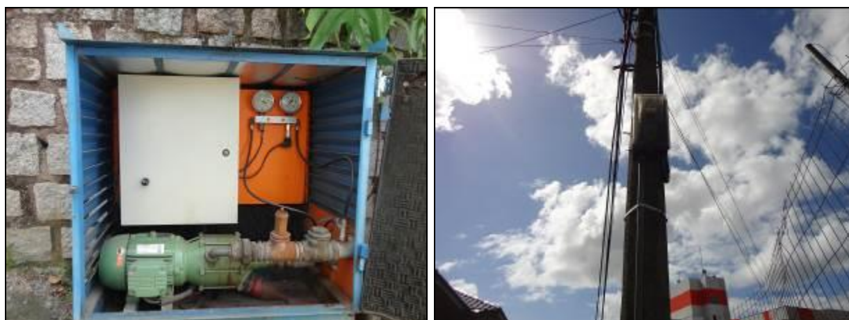
Figura 432- Vista interna com bomba e quadro de comando (à esquerda) e quadro de energia no poste (à direita)
