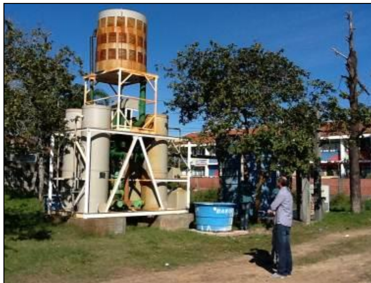
Figura 169 - Fachada e panorâmica geral da ETA Coord. Geográficas: 27°25'30.47"S 48°25'33.62"O (Inicial)
