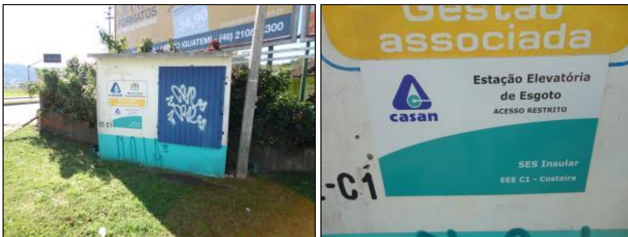
Figura 730- Vista geral da EEE C1 Costeira com placa de identificação e restrição de acesso
