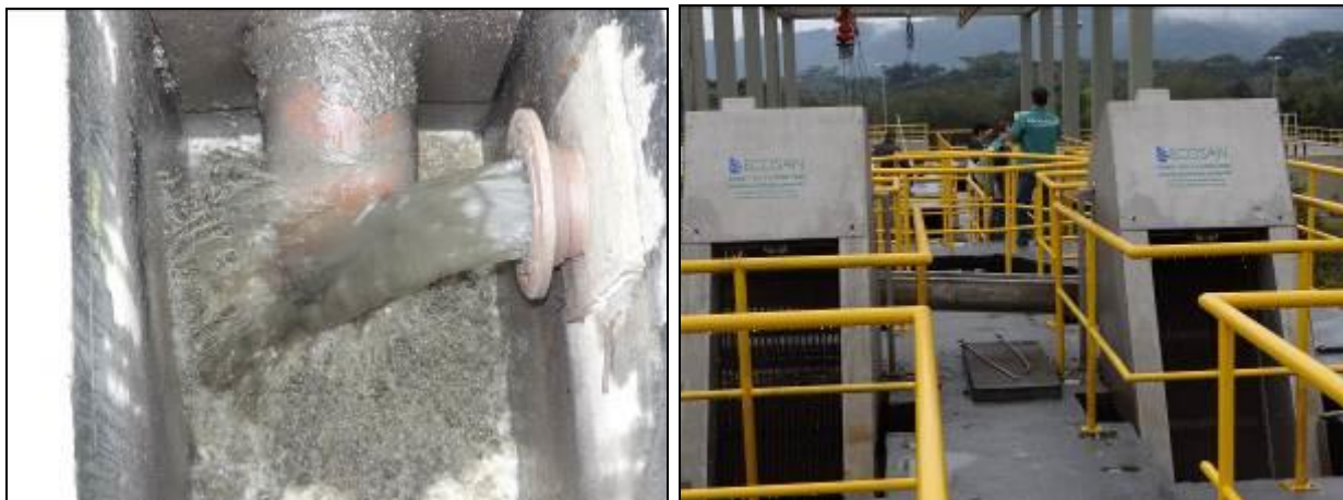
Figura 519 - Efluente bruto e área de recepção com gradeamento (Inicial)
