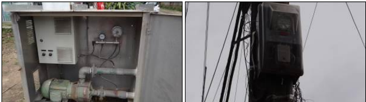
Figura 379- Vista interna com a bomba e quadro de comando (à esquerda) e quadro de energia (à direita)
