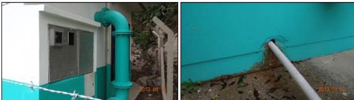
Figura 310- Quadro de energia (à esquerda) e vazamento (à direita)
