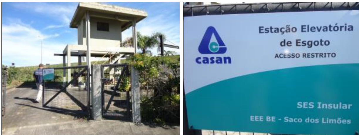
Figura 727- Vista geral da EEE BE Saco dos Limões com placa de identificação e restrição de acesso
