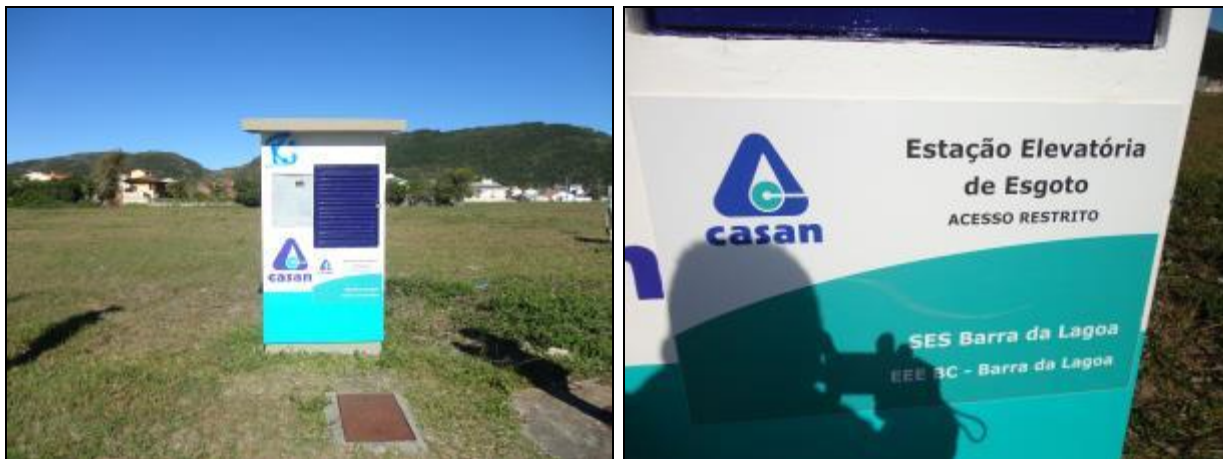
Figura 652- Vista geral da EEE BC Barra da Lagoa com placa de identificação e restrição de acesso
