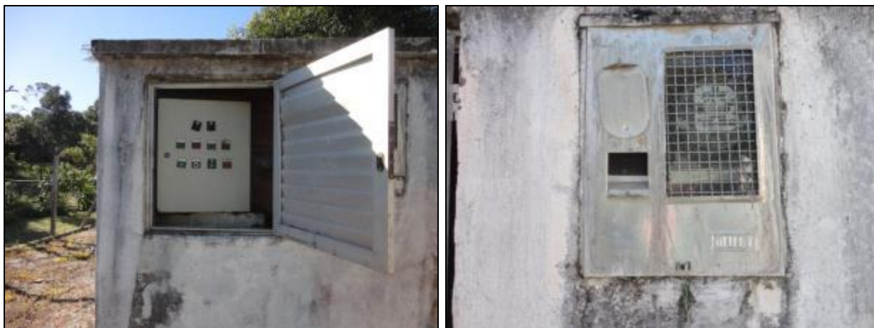
Figura 623- Quadro de comando (à esquerda) e quadro de energia (à direita)
