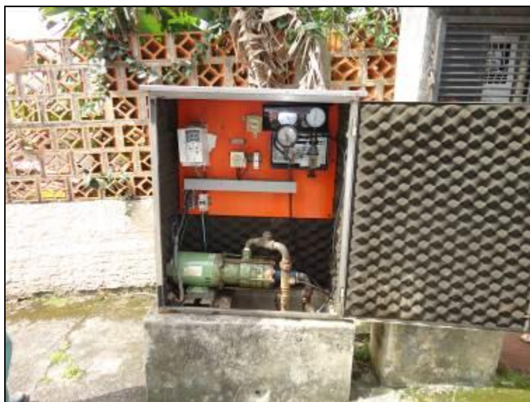
Figura 448- Vista interna do Booster com bomba e quadro de comando
