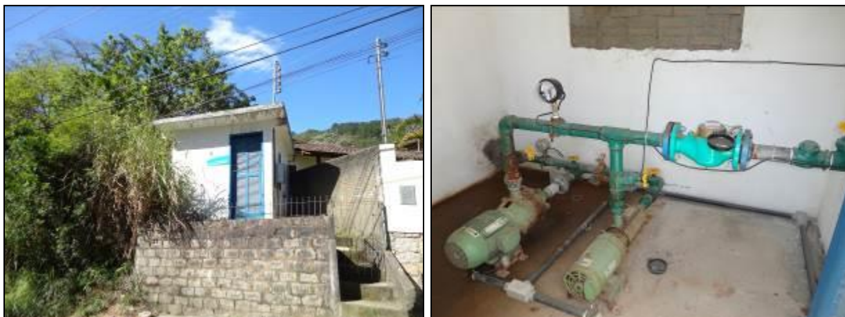
Figura 408- Vista da área do Booster (à esquerda) e das bombas (à direita)
