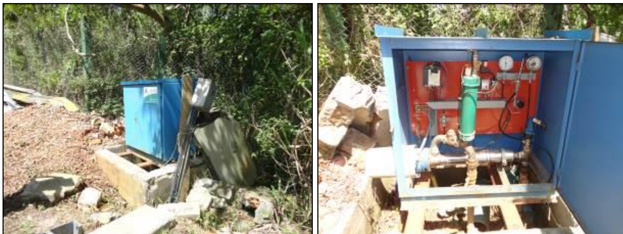
Figura 397- Vista interna e externa do Booster
