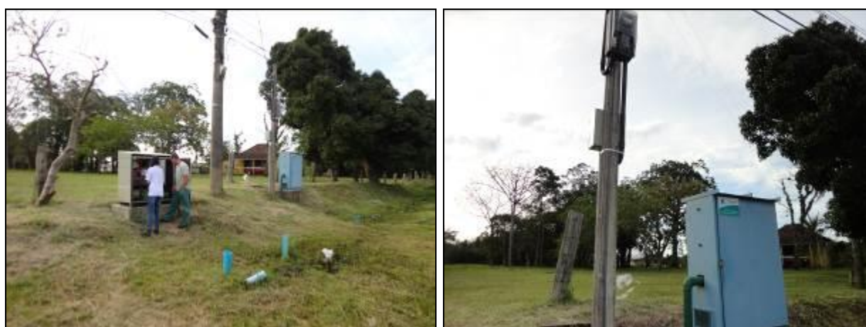
Figura 444- Vista geral dos Boosters
