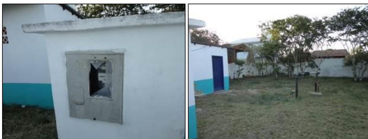
Figura 362- Vidro quebrado do quadro de energia (à esquerda) e Poço Moçambique (à direita)
