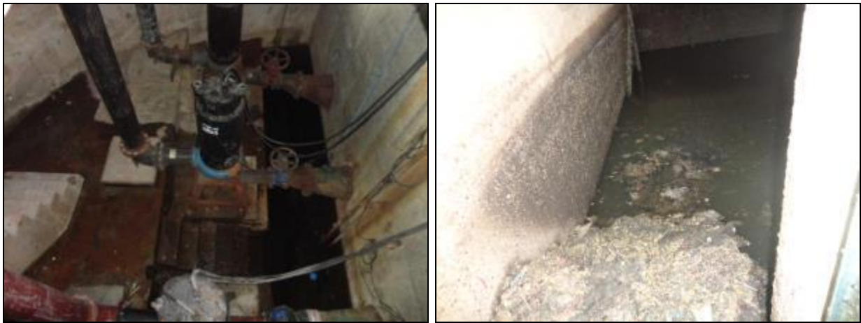
Figura 714- Bombas submersíveis de poço seco (à esquerda) e poço úmido com excesso de gordura e sujeira (à direita)
