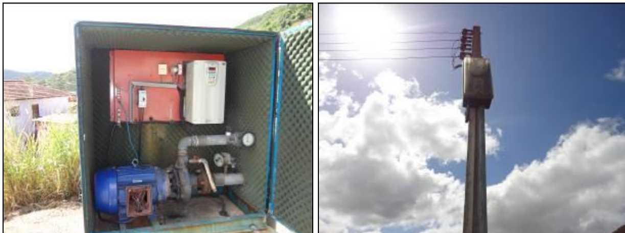
Figura 411- Vista interna da bomba e quadro de comando (à esquerda) e quadro de energia no poste (à direita)
