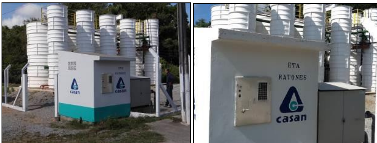
Figura 180 - Fachada e panorâmica geral da ETA Coord. Geográficas: 27°30'34.68"S 48°28'12.52"O (Inicial)
