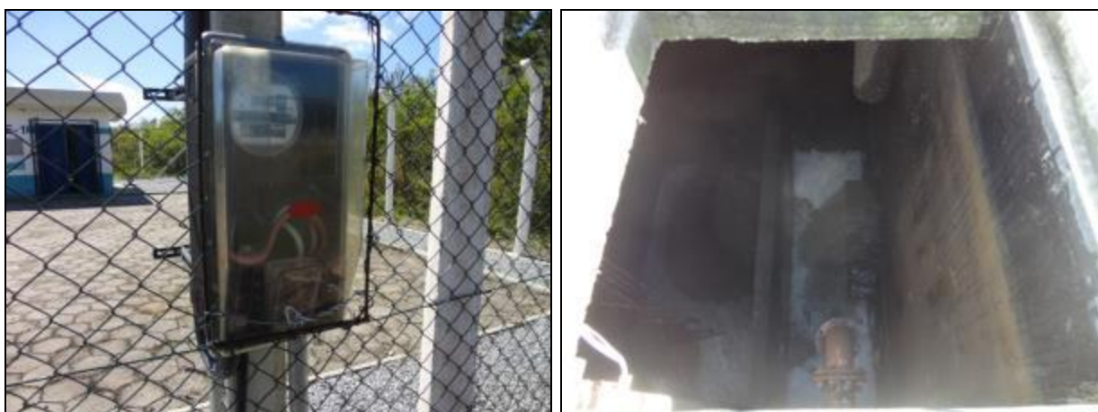
Figura 598- Quadro de energia (à esquerda) e poço úmido (à direita)
