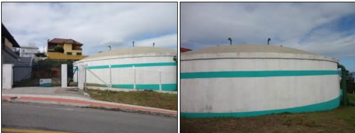
Figura 231 – R-03 – Coqueiros – Vista geral do reservatório com placa de identificação (caída) e portão de acesso (Acompanhamento)
