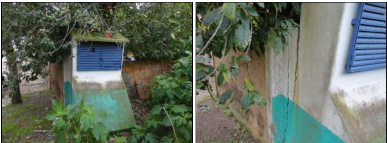
Figura 715- Estrutura degradada com rachaduras
