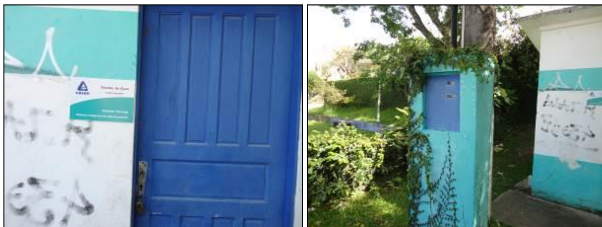
Figura 385- Placa de identificação (à esquerda) e quadro de energia (à direita)
