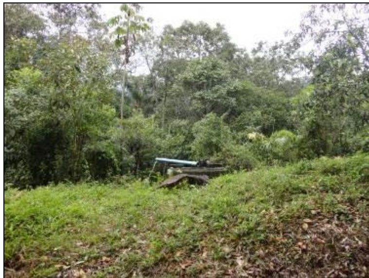
Figura 14 – Válvula que retira o ar das adutoras (Acompanhamento)
