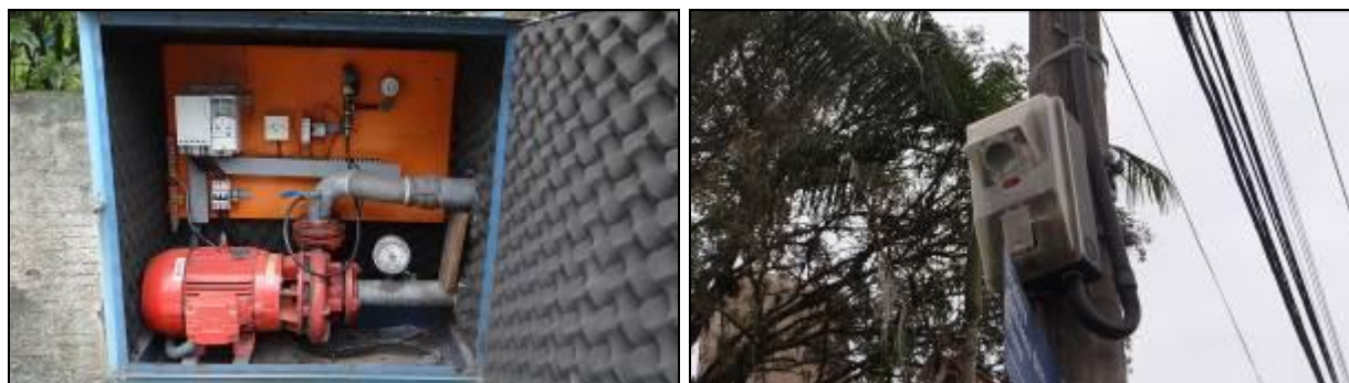
Figura 324- Vista interna da bomba e quadro de comando (à esquerda) e quadro de energia no poste (à direita)
