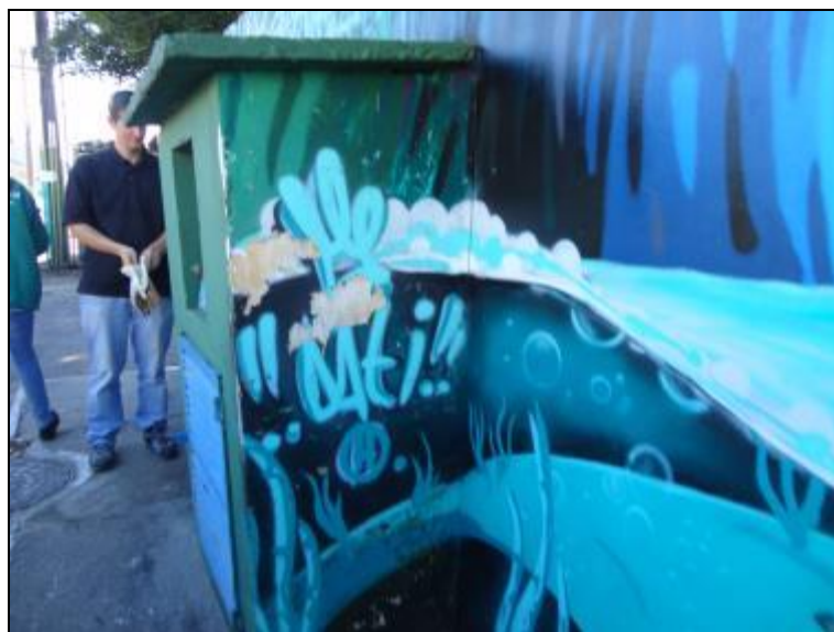
Figura 667- Vista da estrutura pichada
