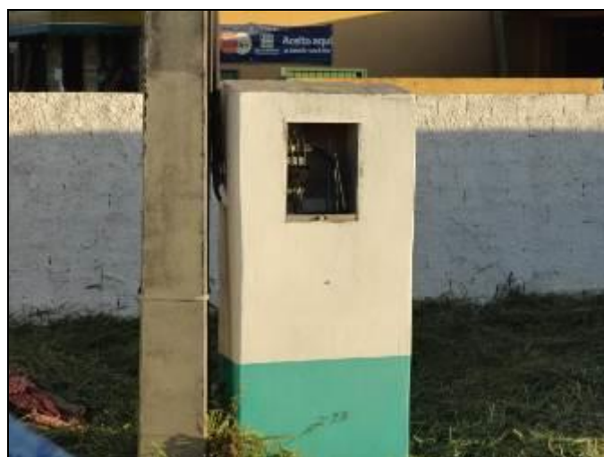
Figura 94 - Poço do Ciro – em reparos, quadro de energia com vidro quebrado (Acompanhamento)
