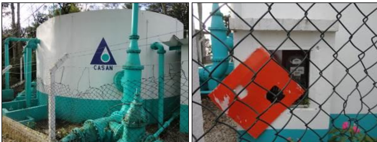
Figura 245 – R-08 Centro - Cerca degradada (à esquerda) e quadro de força com a tampa danificada (Acompanhamento)
