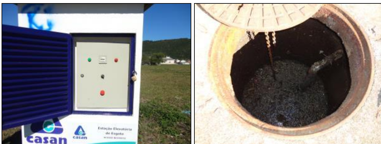
Figura 653- Quadro de comando (à esquerda) e interior do poço úmido (à direita)
