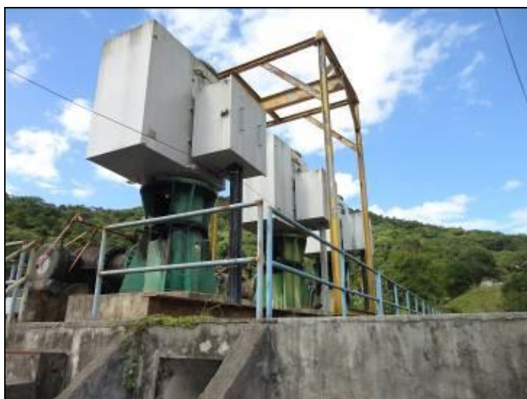
Figura 18 - Bombas de captura de Cubatão (Inicial)
