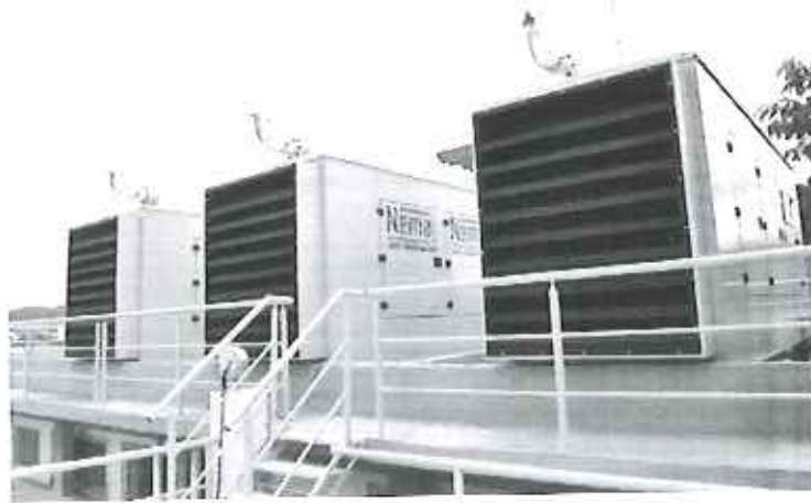
Figura 7 - Geradores de energia na ERAB (©Assessoria de Imprensa/EMASA).
