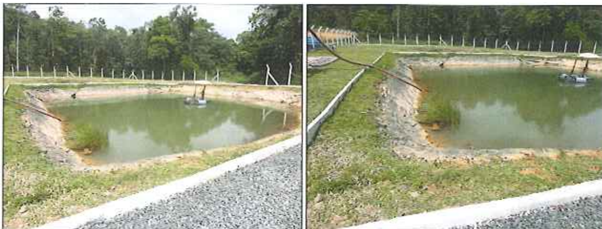
Figura 2: Unidades do tratamento da ETA Rua das Carpas (Fiscalização de dezembro de 2015)
