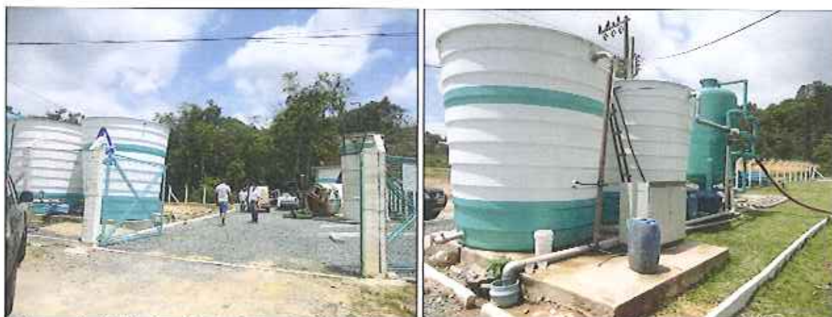
Figura 3: Unidades do tratamento da ETA Rua das Carpas (Fiscalização de dezembro de 2015)
