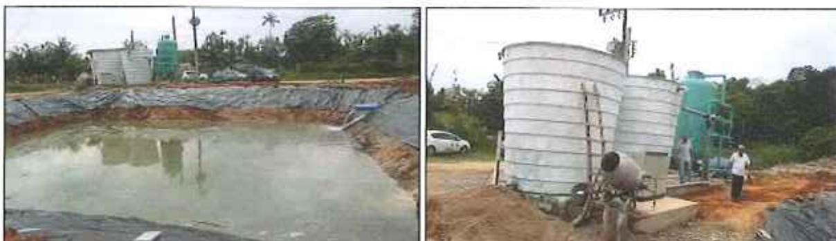
Figura 1: Unidades do tratamento da ETA Rua das Carpas (Fiscalização de dezembro de 2014)
