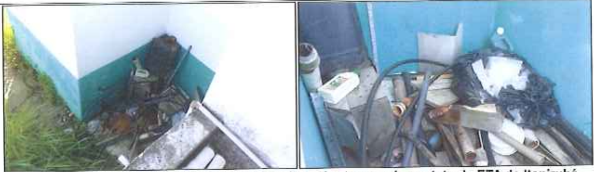
Figura 6: Presença de lixo junto ao local onde está o tanque de contato da ETA de Itapirubá (05/04/2016)
