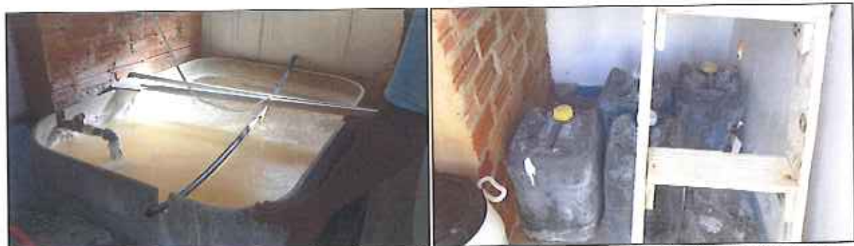
Figura 8: Recipiente com cloro dosado sem tampa e péssimo armazenamento dos produtos químicos na ETA Itapirubá (05/04/2016)
