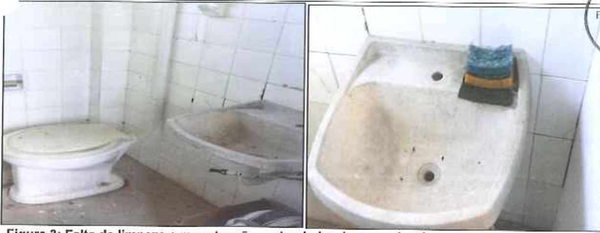
Figura 3: Falta de limpeza e manutenção no banheiro do operador da ETA Itapirubá (05/04/2016)
