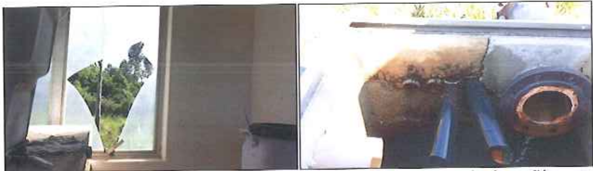
Figura 7: Ausência de manutenção no local de armazenamento e dosagem do cloro e flúor e no tanque de contato na ETA Itapirubá (05/04/2016)
