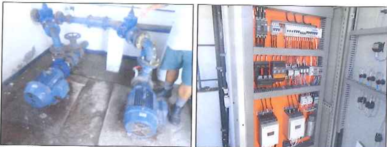
Figura 10: Bombas inoperante na Estação de Recalque de Água e painel de comando (15/04/2016)
