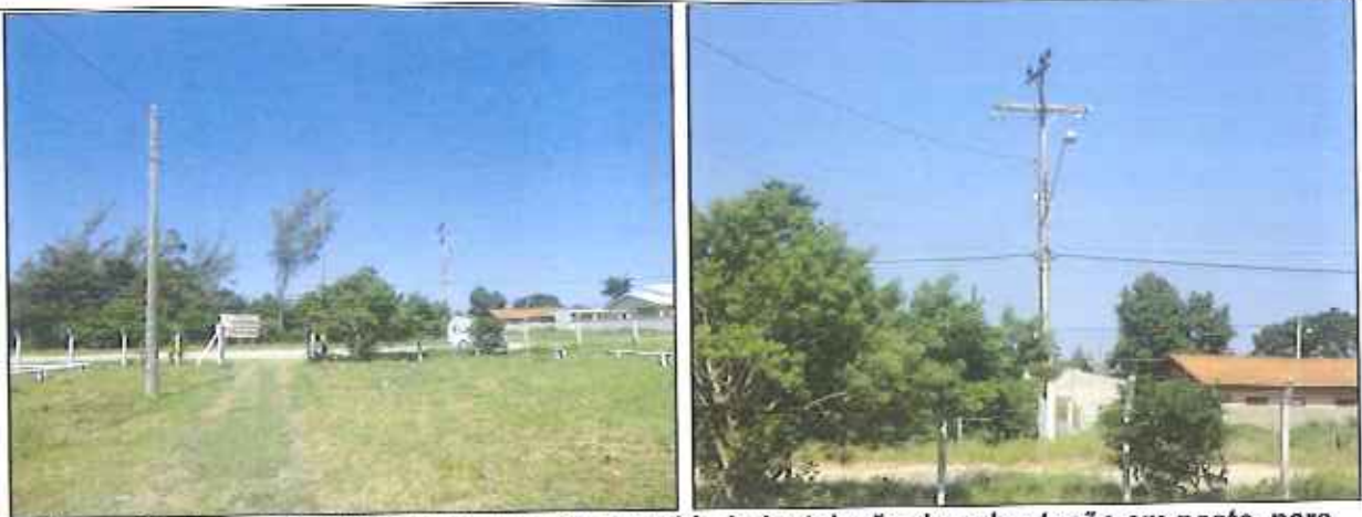
Figura 11: Ramal de entrada de energia, permitindo instalação de subestação em poste, para melhoria de rede, caso não seja resolvido problema de queda tensão constante (15/04/2016)
