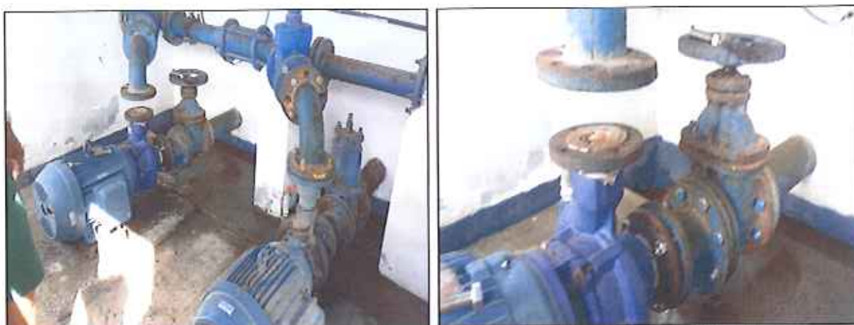
Figura 2: Uma das bombas inoperante na Estação de Recalque de Água (05/04/2016)
