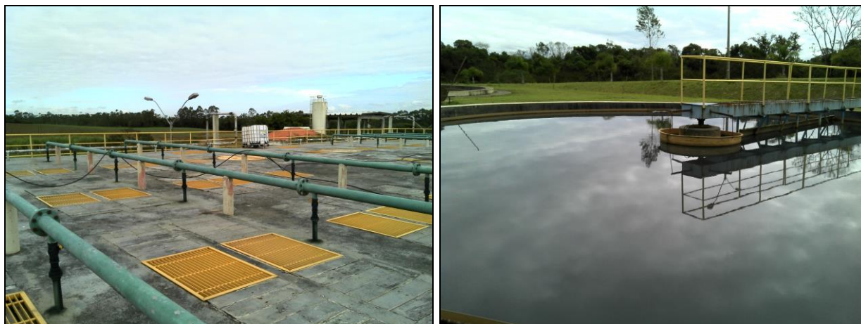
Figura 30: Estação de Tratamento de Esgoto de Criciúma (GEFIS 038/2015)
