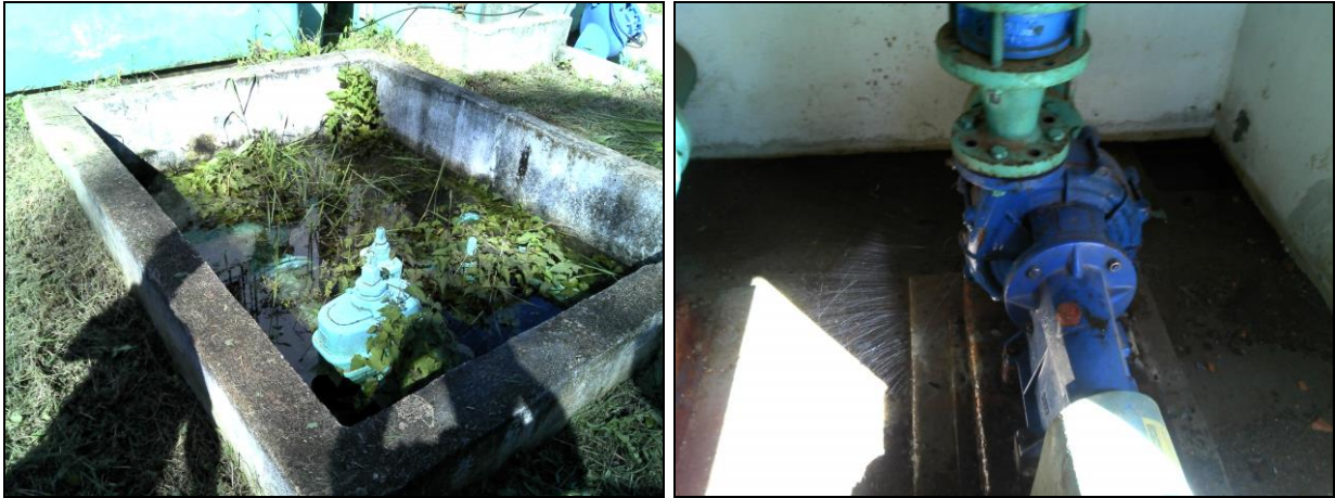
Figura 28: Vazamento na bomba da ERAT 09 (GEFIS 038/2015)
