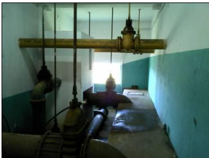
Figura 6: Tubulações com vazamentos
