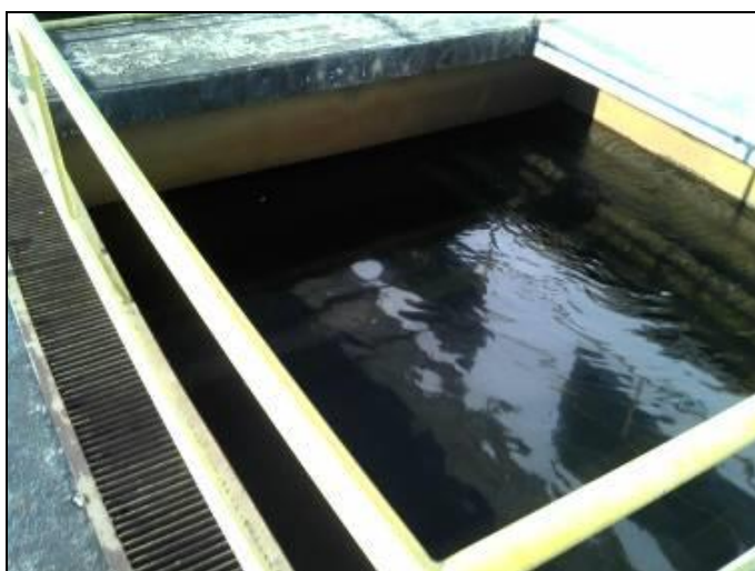
Figura 4: Filtros da ETA
