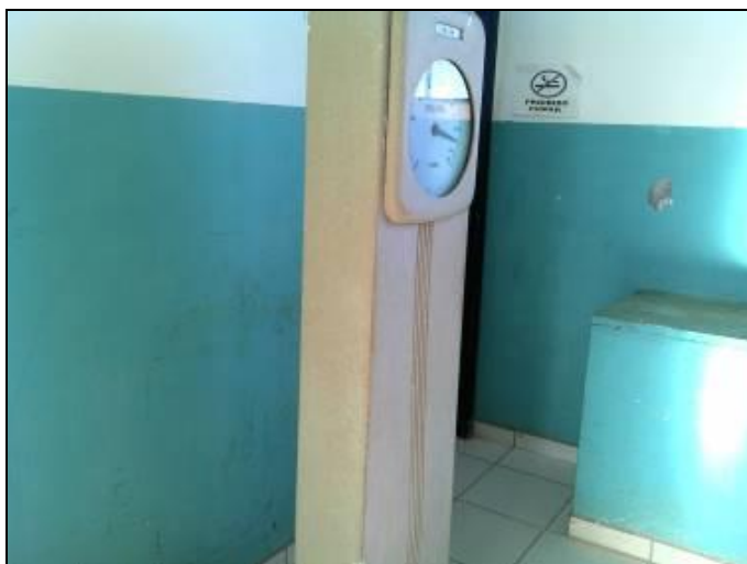
Figura 3: Macro medidor de água bruta
