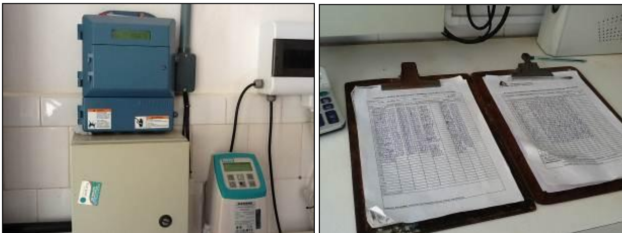
Macromedidores e relatórios de controle.
