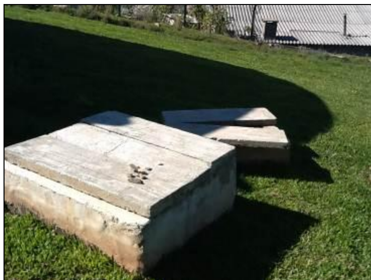
A maioria das estruturas encontrava-se devidamente tampadas.
