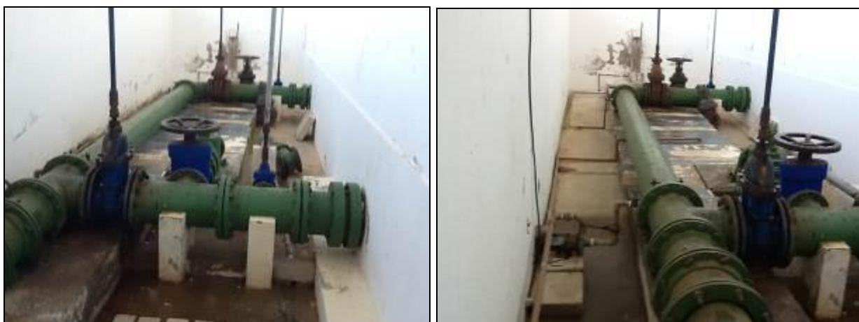
Algumas estruturas apresentam pequenos vazamentos.
