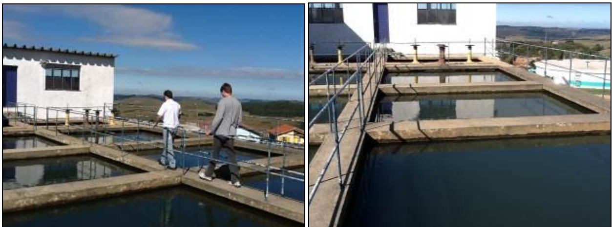
Filtros da ETA São Joaquim.
