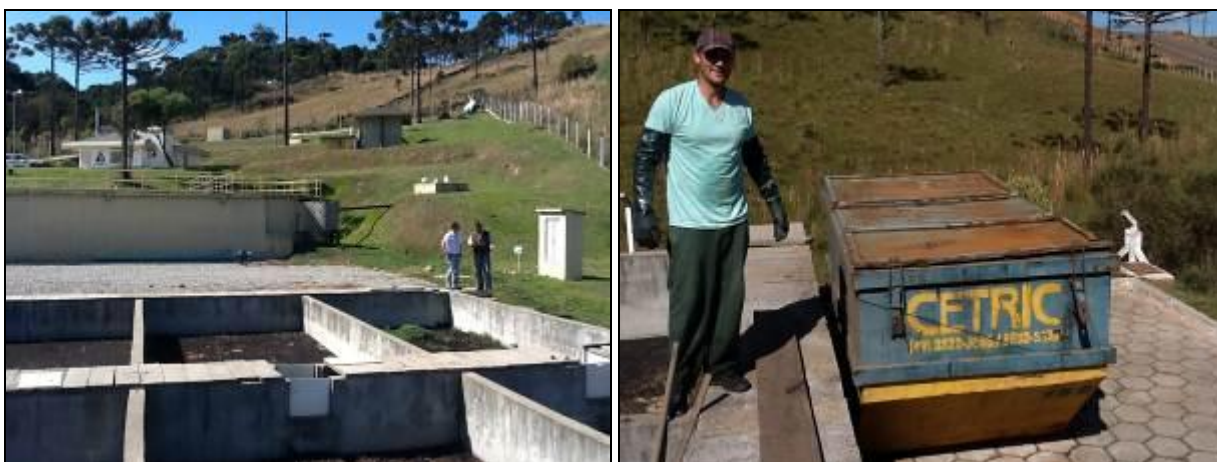
Leitos de secagem do lodo residual e contêiner de transporte do mesmo para aterro sanitário.
