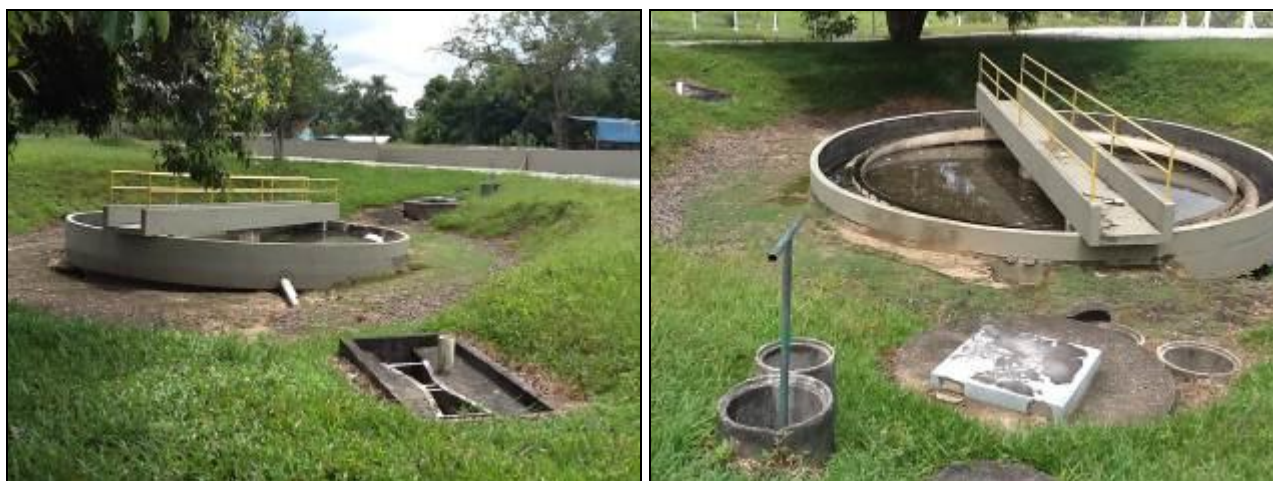
Figura 56: Solo cedeu e atingiu estruturas.
