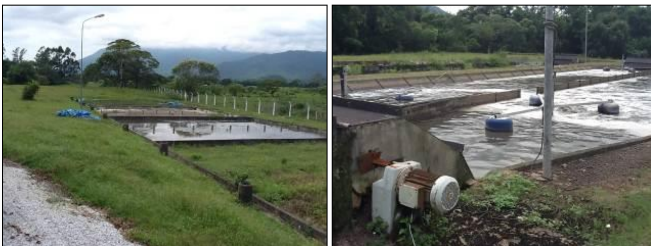
Figura 51: À direita área de deposição do lodo e à esquerda equipamentos de aeração.
