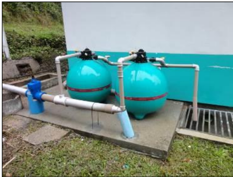
Figura 25: Filtros da ETA (Acompanhamento II)
