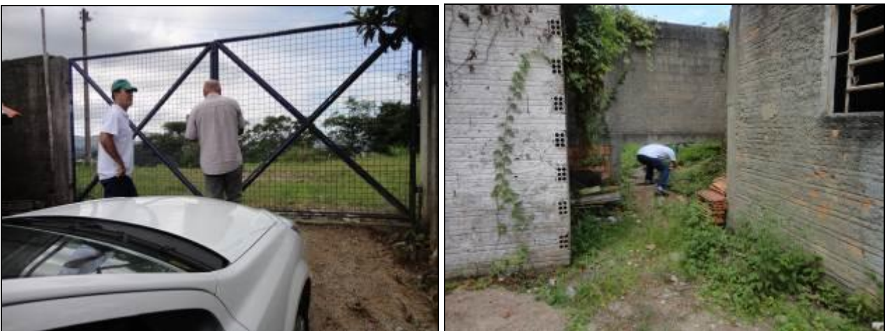
Figura 30: Portão trancado e cadeado emperrado. Utilizou-se parte rompida do muro para acesso ao reservatório. (Acompanhamento I)
