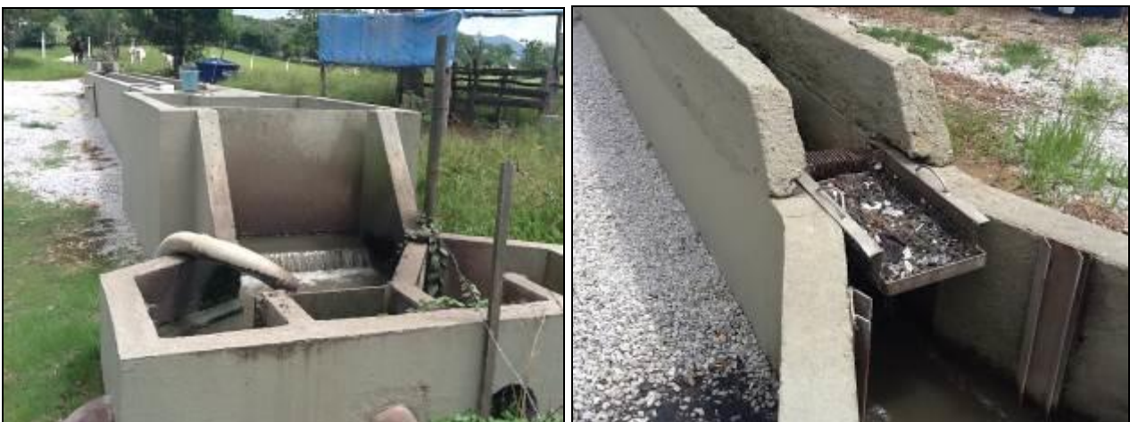
Figura 54: Gradeamento de entrada do esgoto. (Acompanhamento I)
