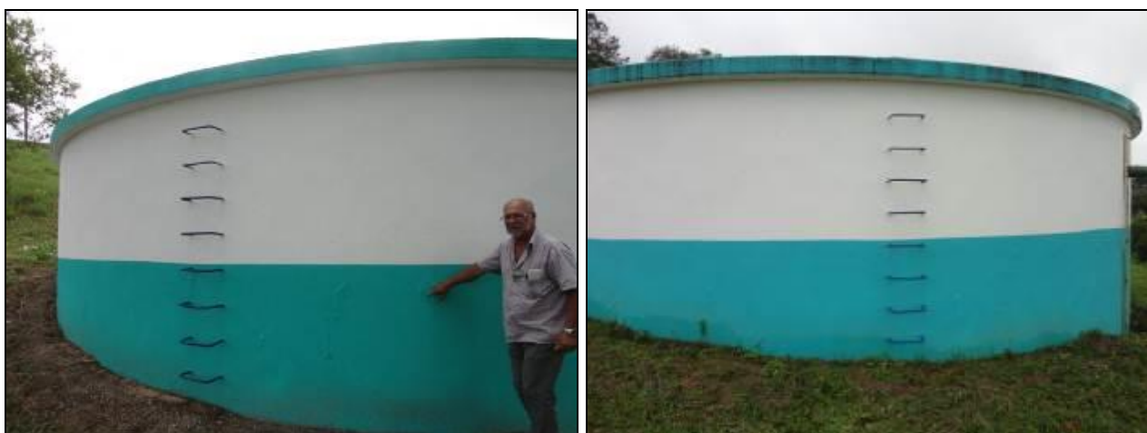
Figura 32: Escadas de acesso à cobertura do reservatório. Feche da Agência aponta para conserto de vazamento efetuado com tecnologia inovadora que utiliza pinos e produto expansivo. Acompanhamento I – Esquerda e II à Direita
