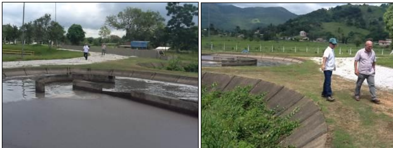
Figura 61: Outras estruturas da ETE (Acompanhamento I)
