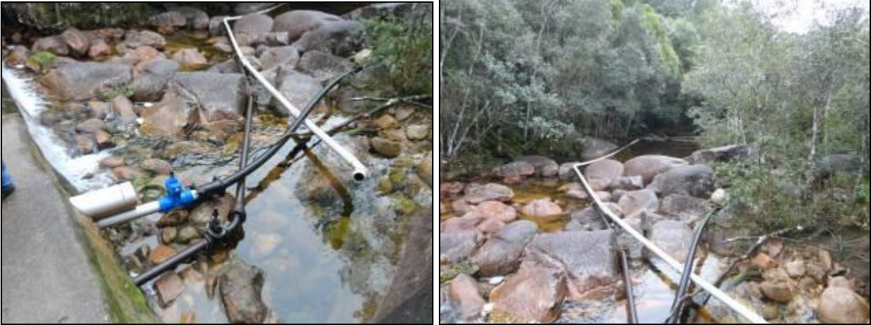
Figura 21: Disposição das adutoras segue inadequada – sob o Rio. (Acompanhamento II)
