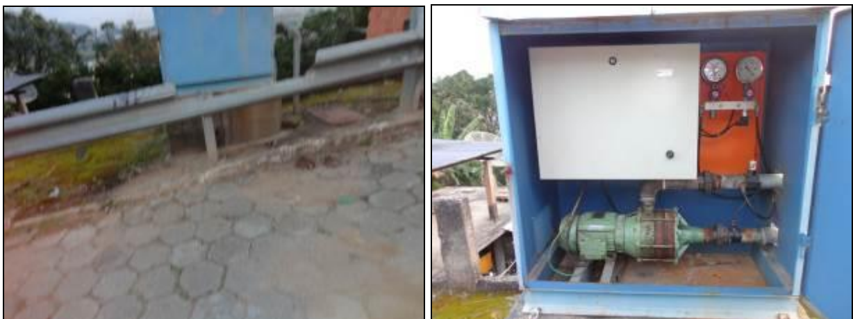
Figura 14: Booster Morro do Céu (Acompanhamento)
