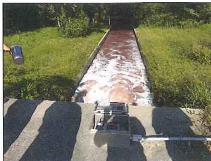
Figura 22: Medidor da vazão do efluente na saída da ETE Potecas inoperante.
