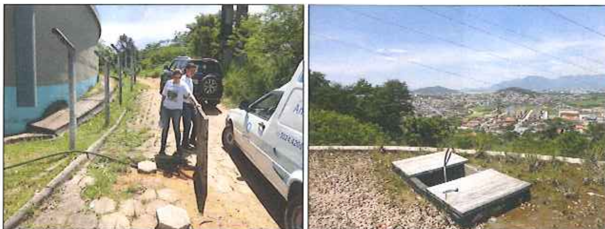
Figura 15: Encanamento clandestino para obtenção da água do Reservatório Forquilhas
