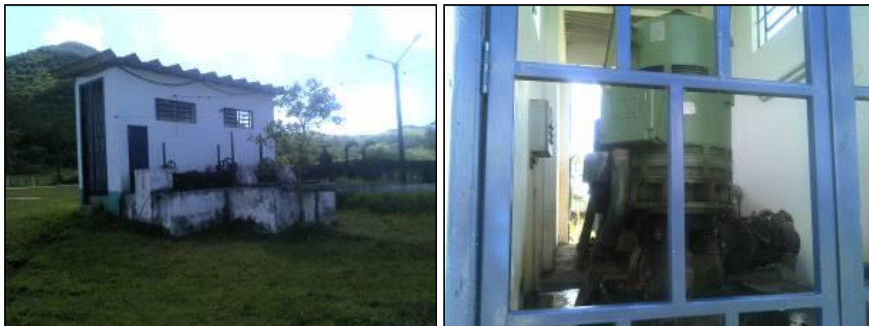
Figura 41: Vista externa e interna da ERAB Captação
