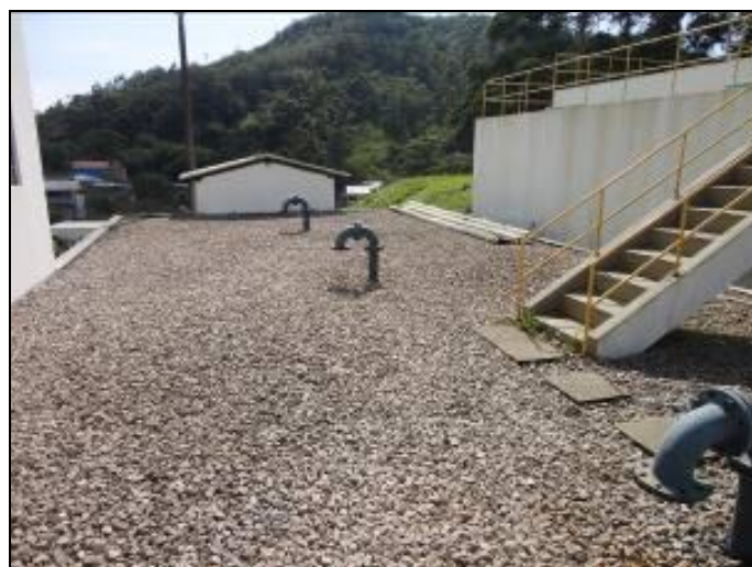
Figura 15: Tanque de contato
