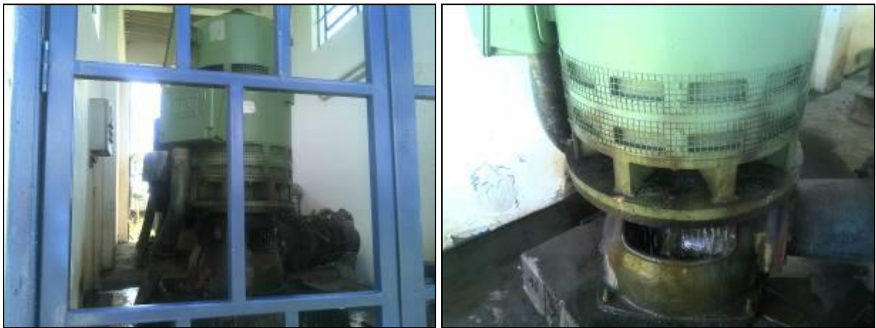
Figura 6: Bombas de captação
