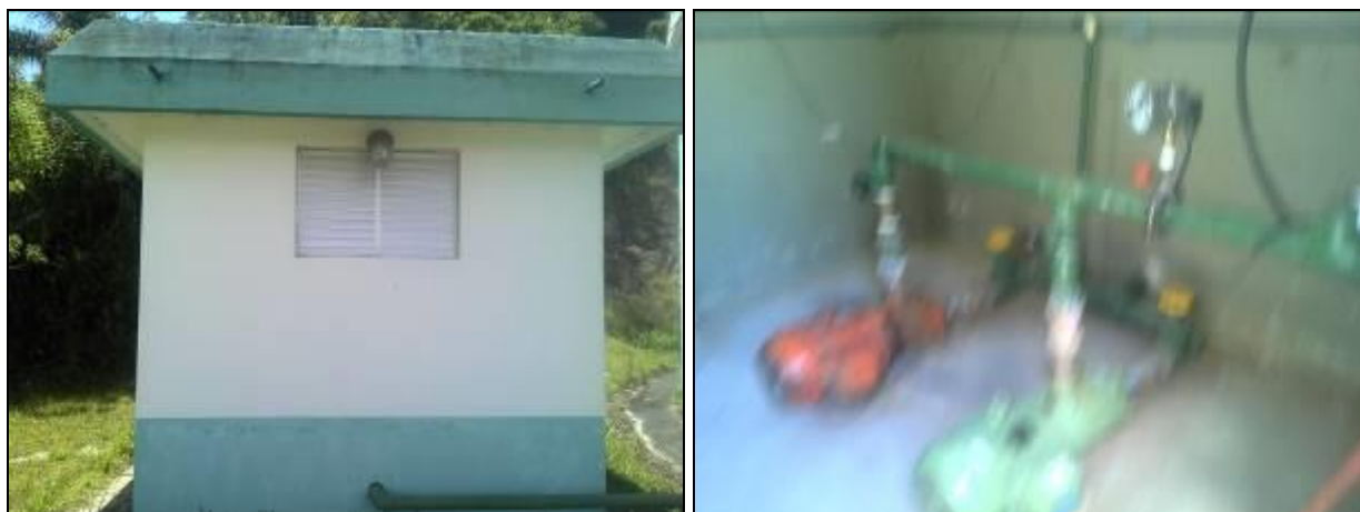
Figura 45: Vista externa e interna da ERAT R07
