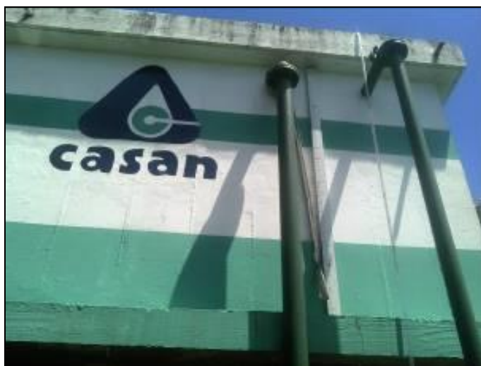
Figura 37: Régua de nível danificada
