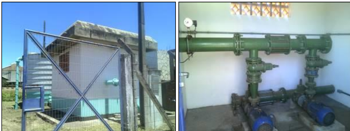
Figura 47: Vista externa e interna da ERAT R11
