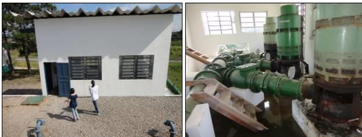
Figura 42: Vista externa e interna da ERAT ETA
