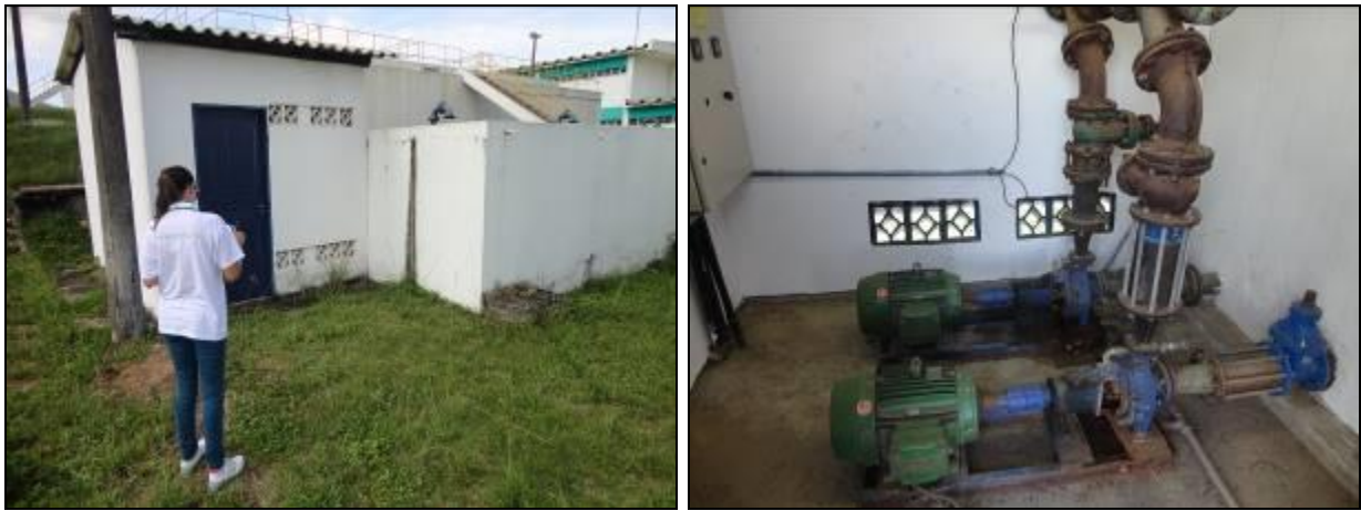
Figura 43: Vista externa e interna da ERAT Nova Brasília
