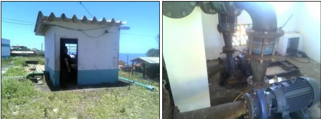
Figura 44: Vista externa e interna da ERAT R04
