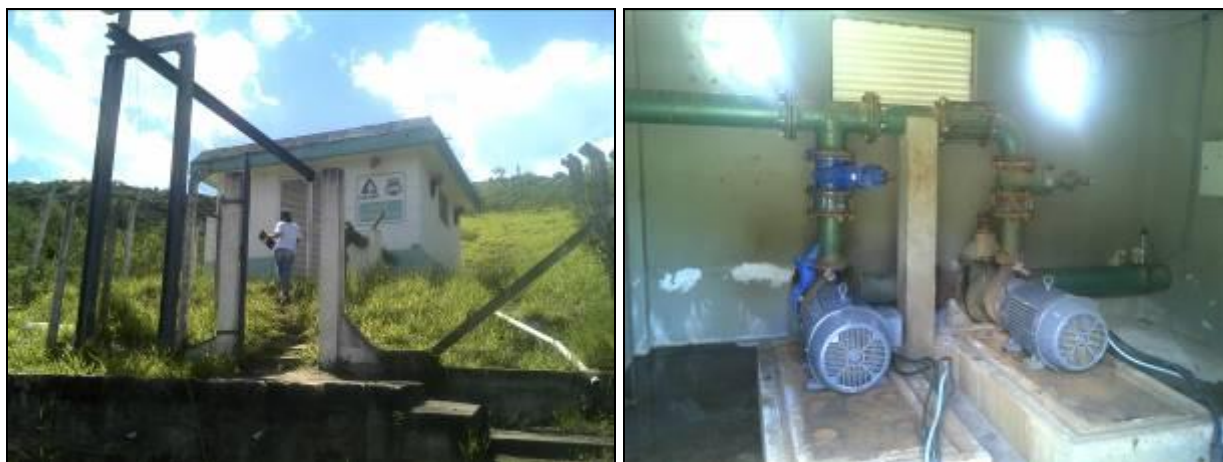
Figura 46: Vista externa e interna da ERAT R08
