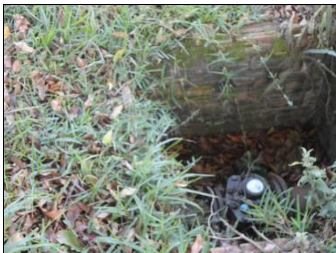
Figura 10: Macro medidor de saída para o bairro Nova Brasília
