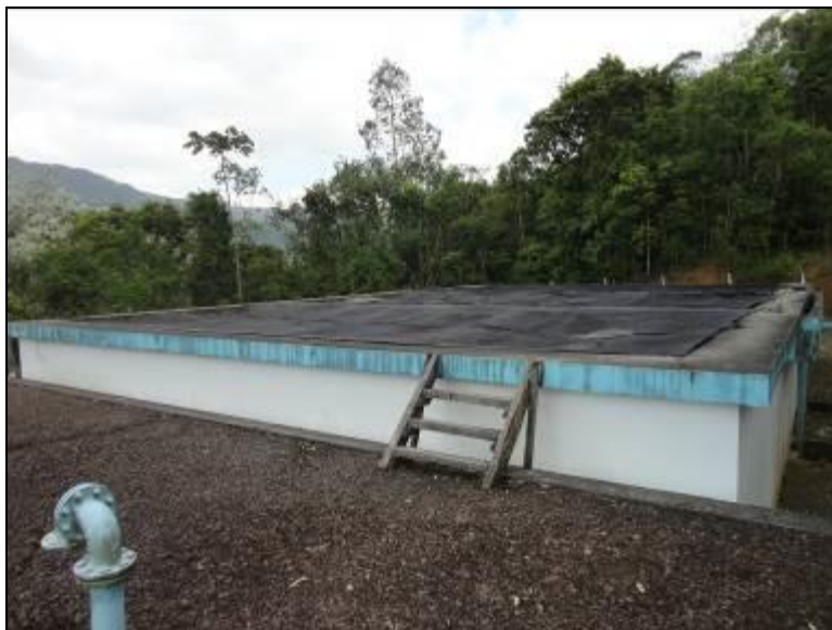
Figura 15: ETA sem guarda-copos (acompanhamento)
