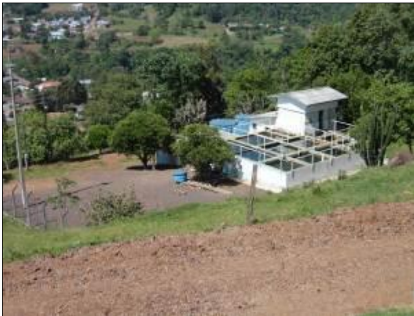
Figura 11: Vista parcial da ETA (inicial)
