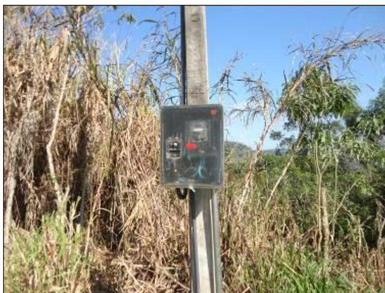
Figura 29: Quadro de Energia do ERAT.(acompanhamento)
