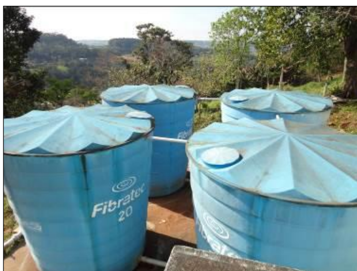
Figura 24: R-0 Junto a ETA – 4 x 20 m 3 (acompanhamento)
