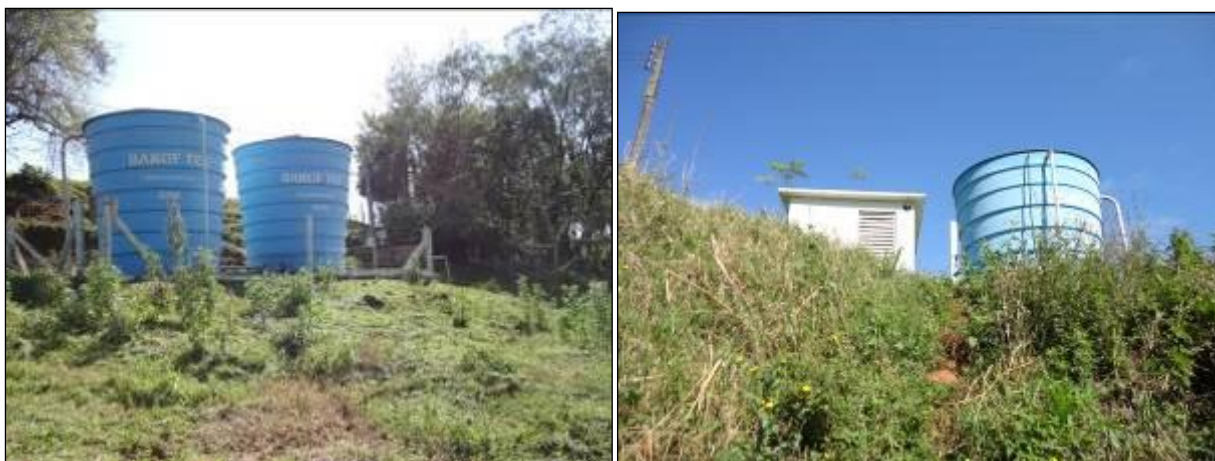
Figura 26: Outros Reservatórios que abastecem o Sistema (acompanhamento)
